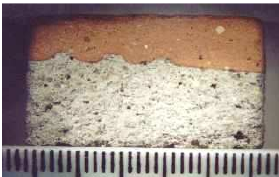
Interface bloco cerâmico/argamassa observada em lupa estereoscópica, na amostra cortada com serra cut-off. Aumento de 04x.
