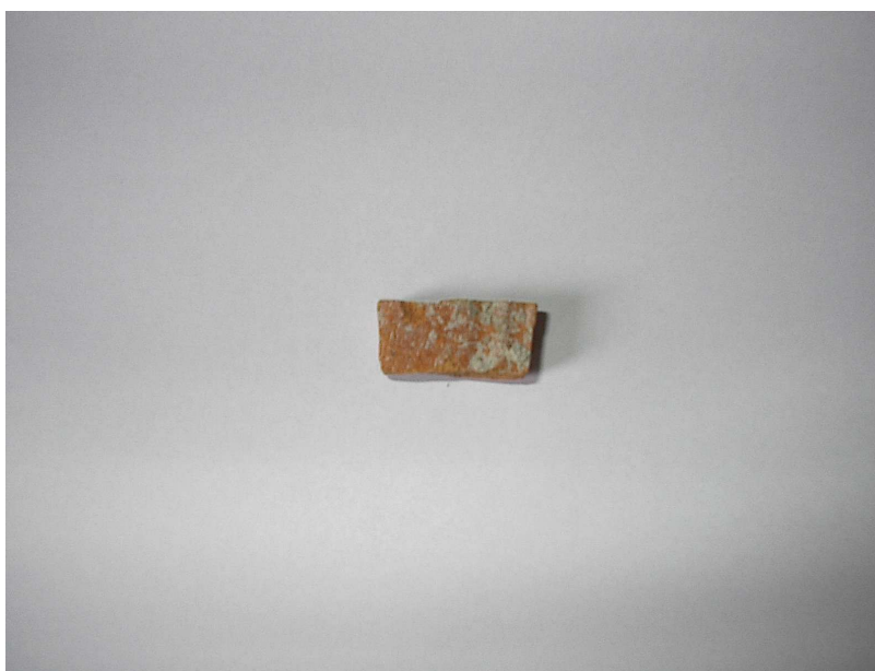
Figura 4.13 – Superfície do bloco cerâmico da amostra (para análise no MEV) após a retirada do revestimento argamassado.
