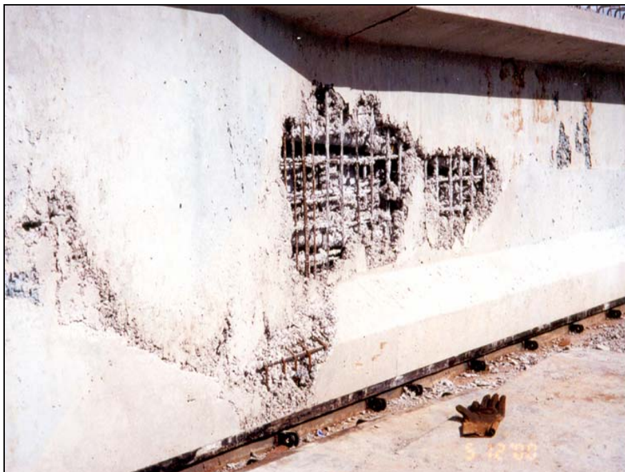
Figura 5.10: Falta de um plano de concretagem provocou danos irreversíveis em uma viga protendida
