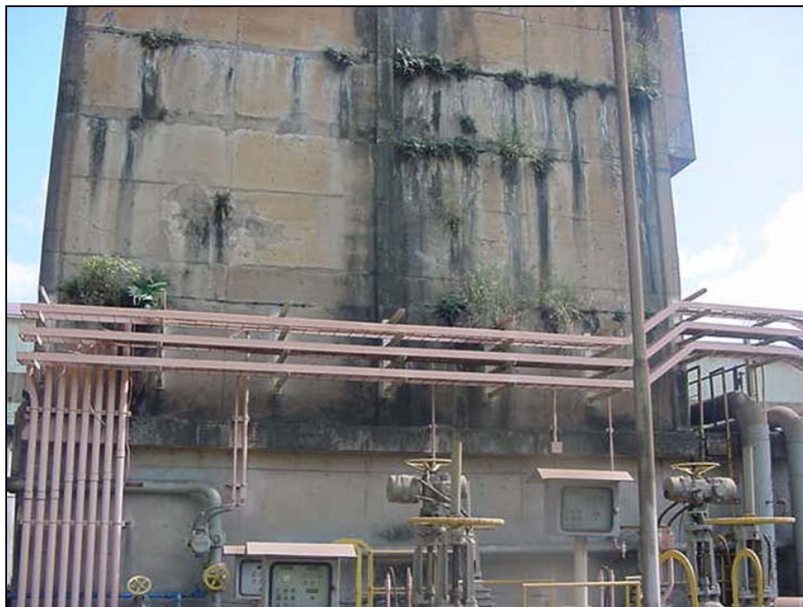
Figura 2.21: Crescimento de raízes de plantas em fendas do concreto deterioram a estrutura
