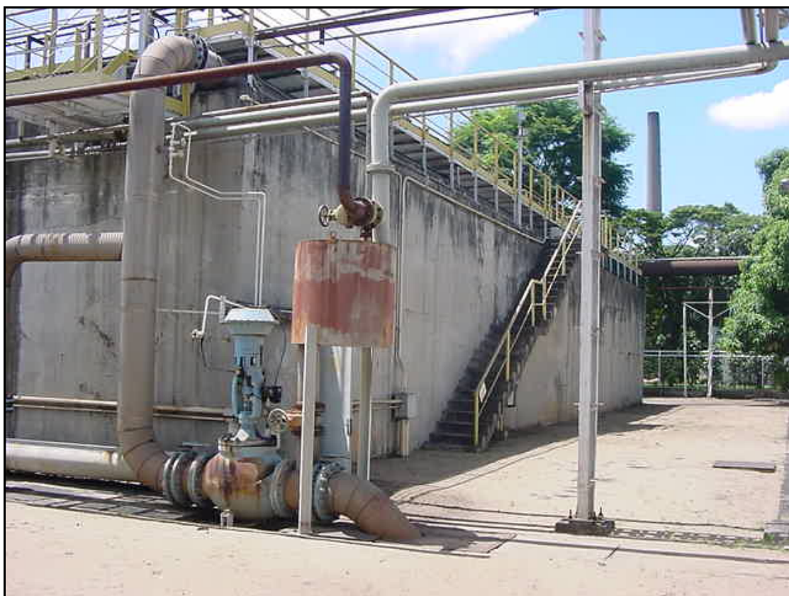
Figura 6.4: Estação de tratamento biológico – ETB / Usiminas
