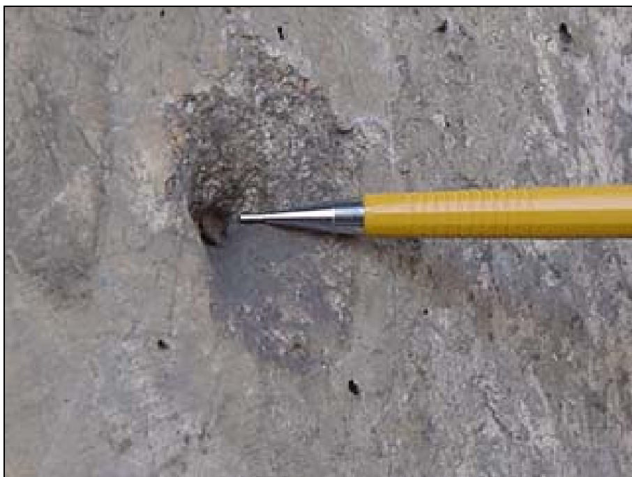
Figura 5.7: Com passar do tempo as pontas de ferro se corroem, deteriorando o concreto
