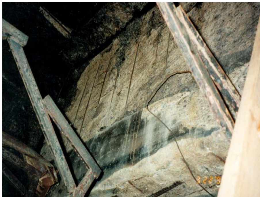
Figura 2.9: Incêndio provoca danos em vigas de um auditório
