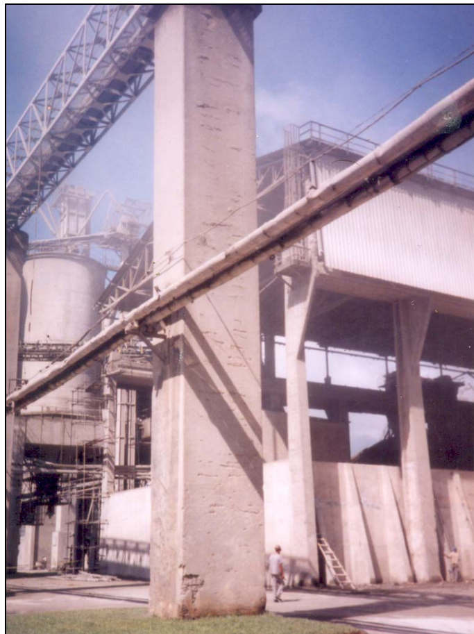
Figura 2.25: Corrosão generalizada, atinge todo um pilar de área industrial
