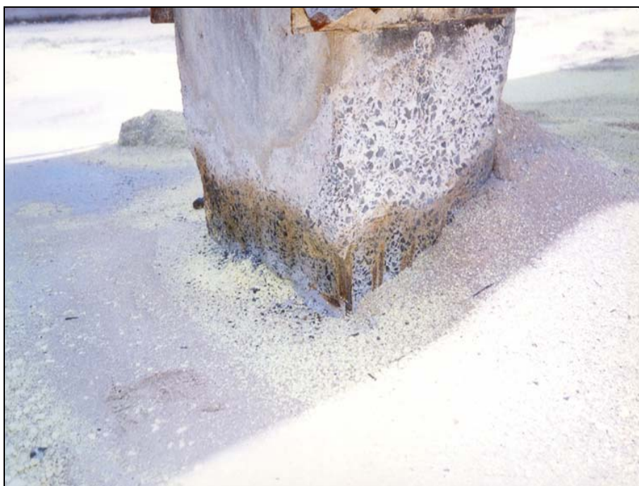
Figura 2.14: Ataque químico por ácido sulfúrico deteriorou pilar em indústria de fertilizantes
