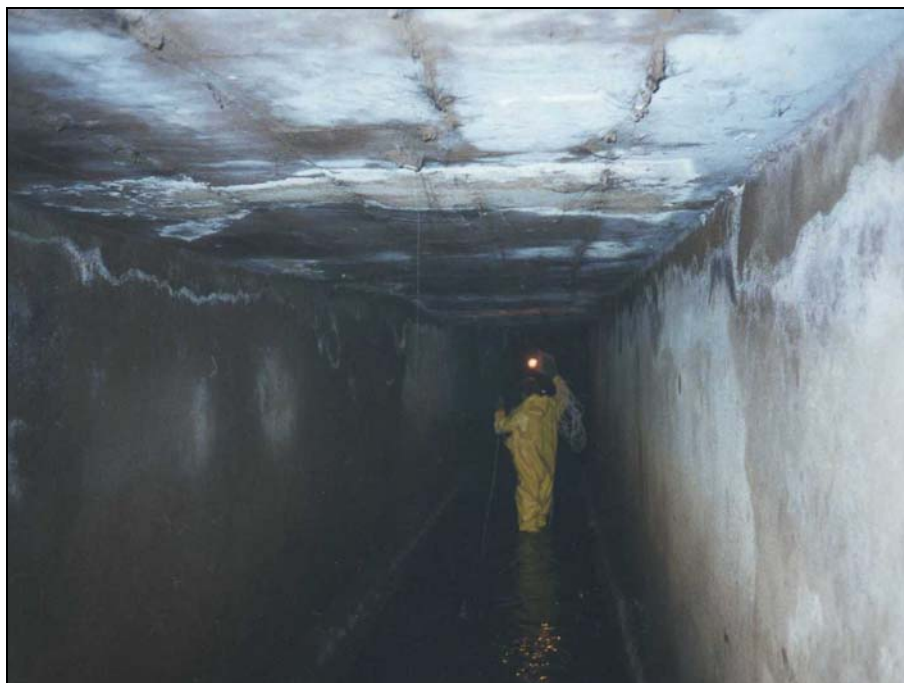
Figura 2.19: Teto de galeria de águas pluviais contaminada por esgotos apresenta manchas devido ao ataque biológico
