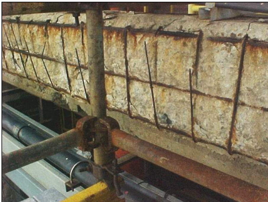
Figura 2.10: Ataque químico deteriorou severamente uma viga de concreto em indústria química
