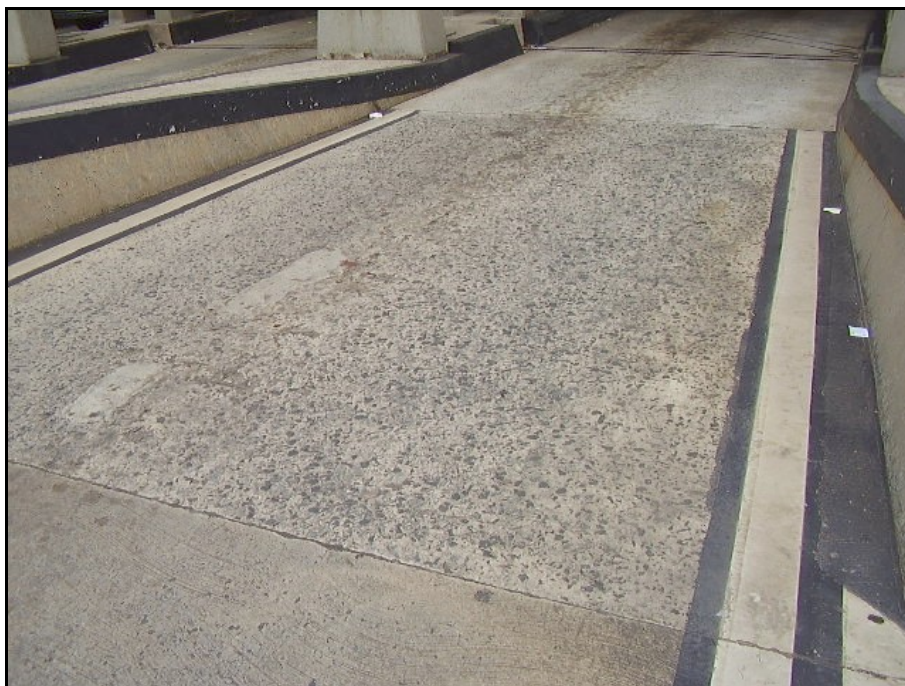
Figura 2.5: Desgaste superficial por abrasão em pavimento de concreto
