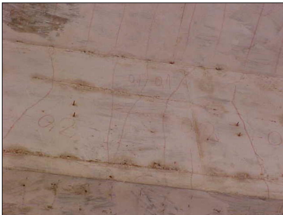
Figura 2.3: Estrutura de ponte com fissuras devidas à retração do concreto
