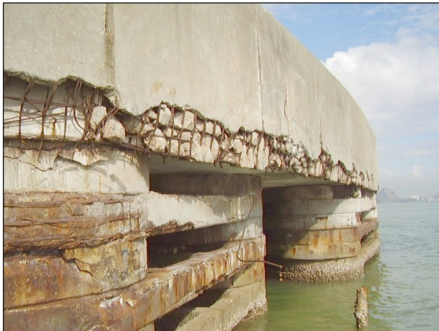
Figura 2.15: Estruturas de concreto localizadas na linha da maré severamente deterioradas
