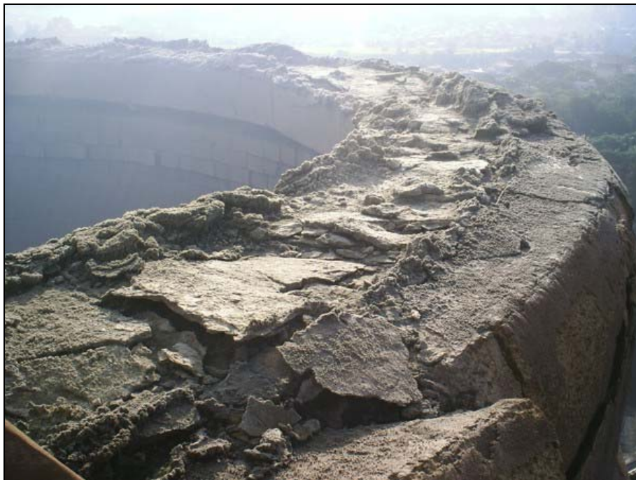
Figura 2.2: Anel superior de concreto de uma chaminé dilacerado devido ao choque térmico
