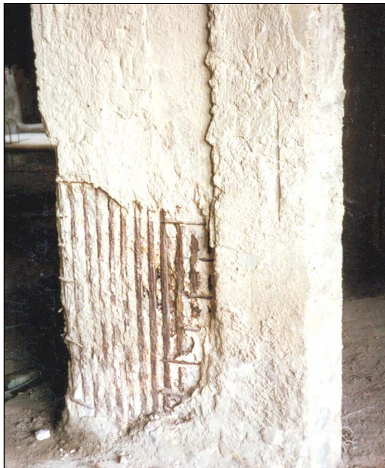
Figura 2.16: Pilar em indústria com corrosão nas armaduras devido à carbonatação
