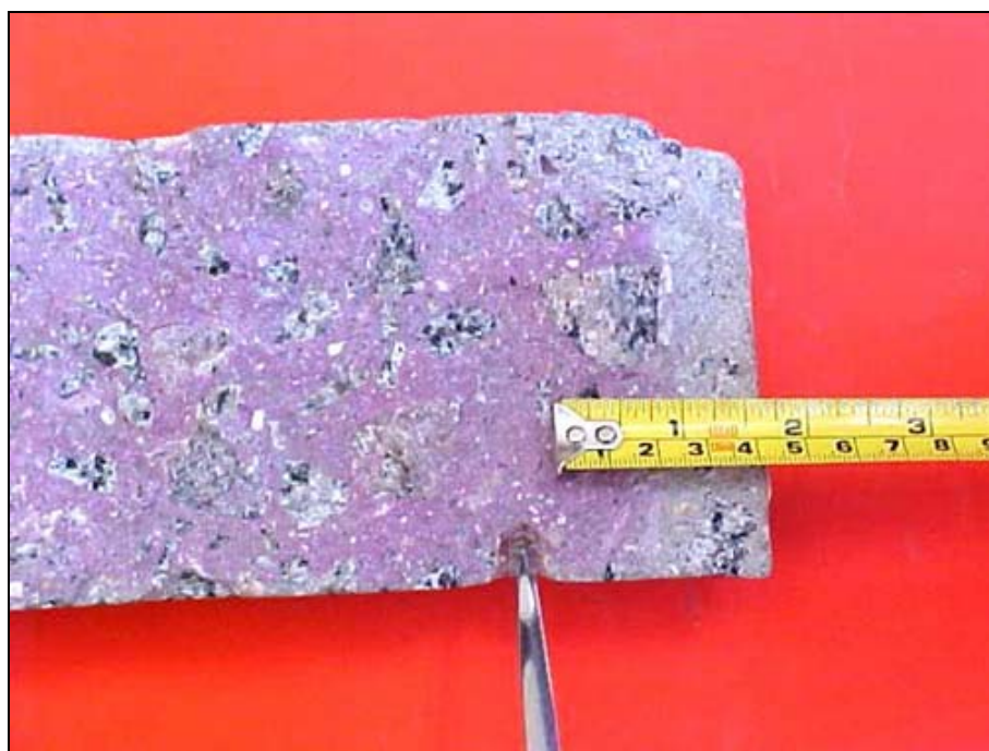
Figura 2.17: Teste com fenolftaleína indicando uma profundidade de carbonatação de 2cm em amostra com 4cm de cobertura de armadura
