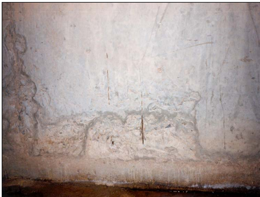
Figura 5.9: Excesso de altura do lançamento de concreto provocou segregação
