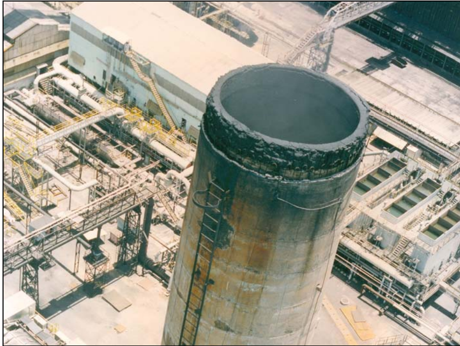
Figura 2.1: Topo de chaminé de uma siderúrgica, deteriorado pela variação brusca de temperatura
