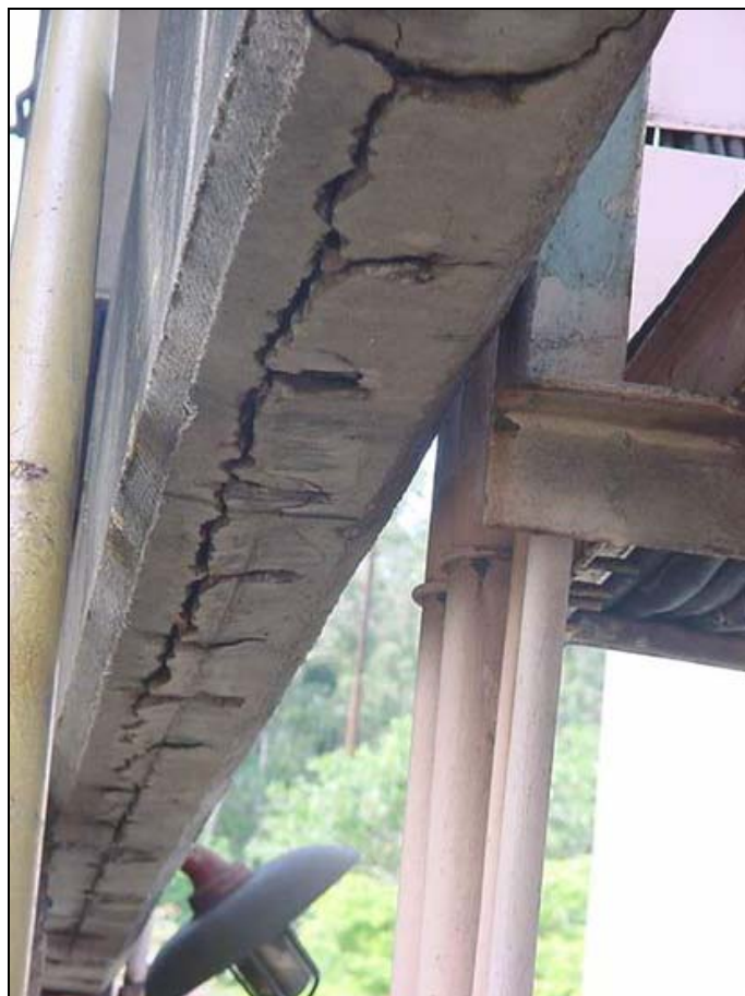
Figura 2.24: Fissuras em viga causadas pela expansão dos óxidos gerados na corrosão
