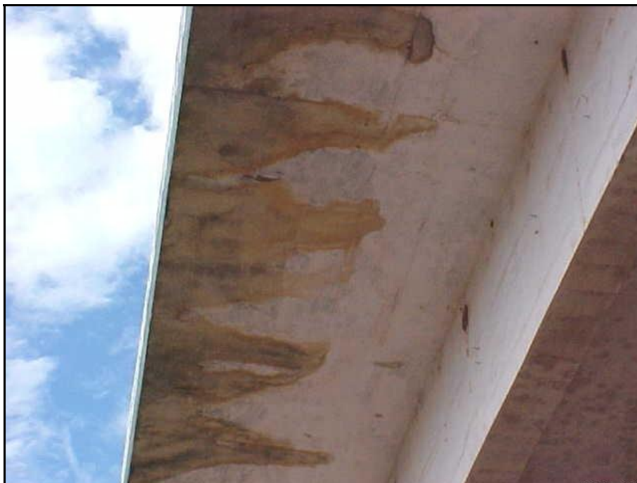
Figura 5.1: Ausência de pingadeira provoca escoamento de água
