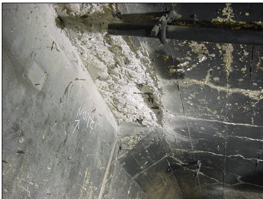
Figura 2.7: Efeitos do calor deterioram a laje superior de um túnel para passagem de peças metálicas com altas temperaturas em uma siderúrgica
