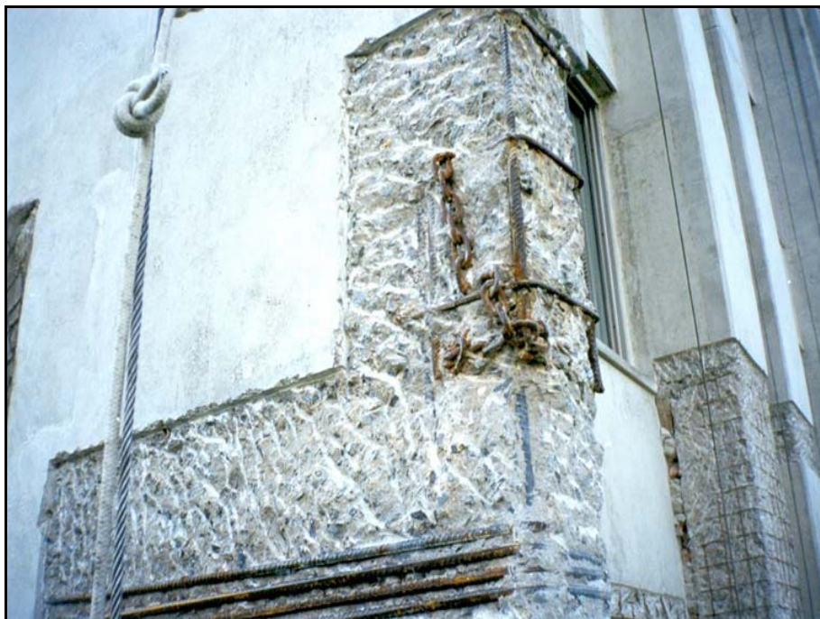
Figura 2.26: Corrosão galvânica de pilar de prédio residencial
