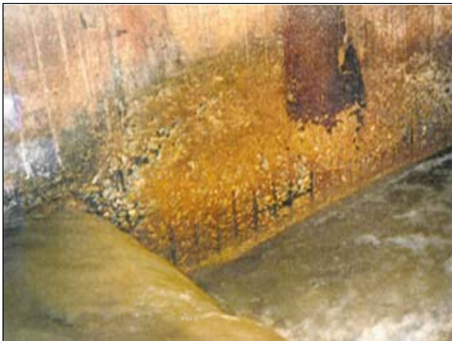
Figura 2.6: Erosão em galeria de água pluvial em região de degrau
