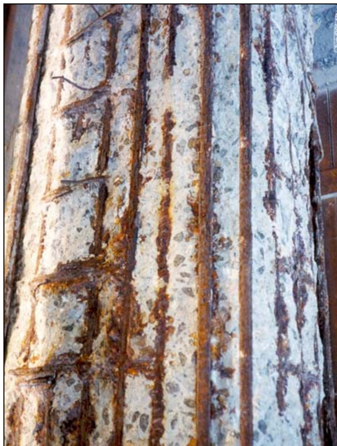
Figura 2.18: Pilar sobre o mar após 10 anos de construção, deteriorado devido aos efeitos da interação da carbonatação com íons e cloretos
