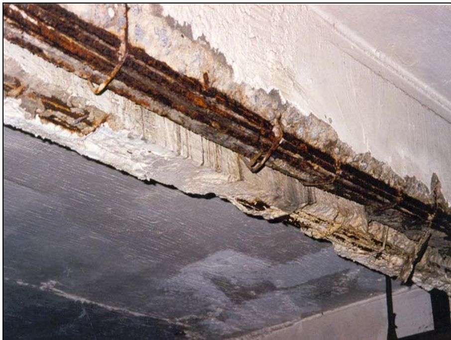
Figura 5.4: Congestionamento das armaduras, provocou deterioração precoce da estrutura
