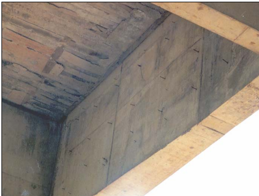
Figura 5.6: Pontas de ferro utilizadas para travamento das fôrmas não são retiradas
