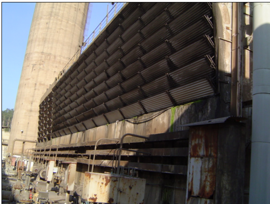
Figura 6.6: Tratamento e recirculação de água – CRALLIN / Usiminas
