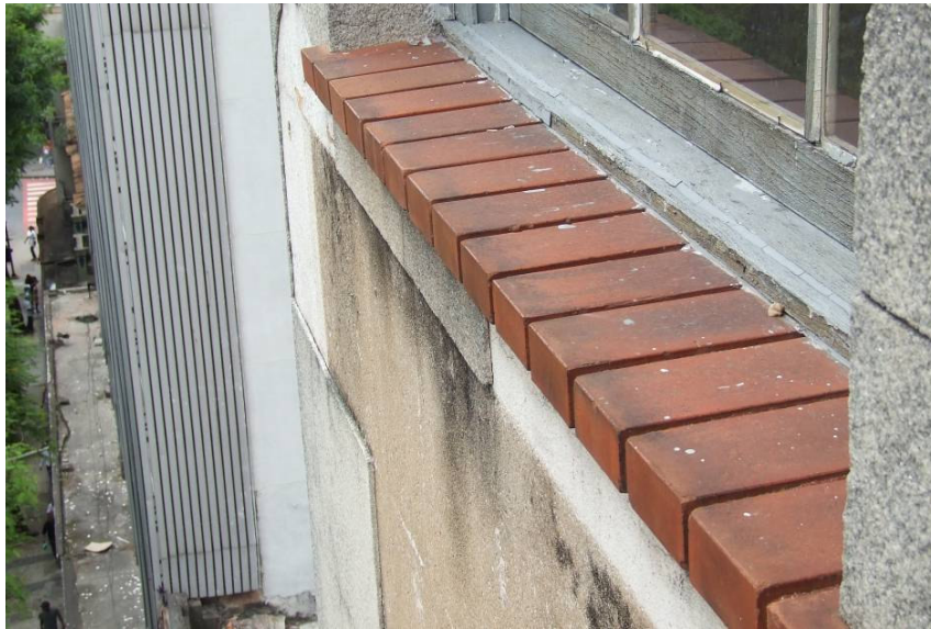
Figura 34 – Descolamento do revestimento no peitoril da janela.
