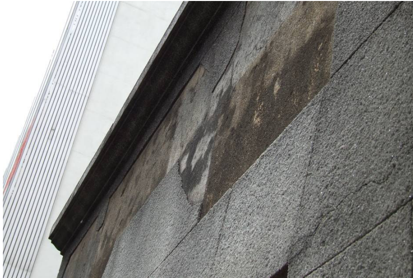
Figura 35 – Descolamento do revestimento na platibanda do prédio.
