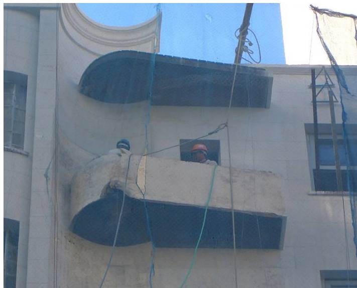
Figura 72 – Execução do revestimento na varanda onde foram realizados os ensaios de caracterização da argamassa aplicada sobre a base.
