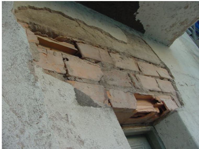
Figura 46 – Local onde houve descolamento também do chapisco e do emboço.
