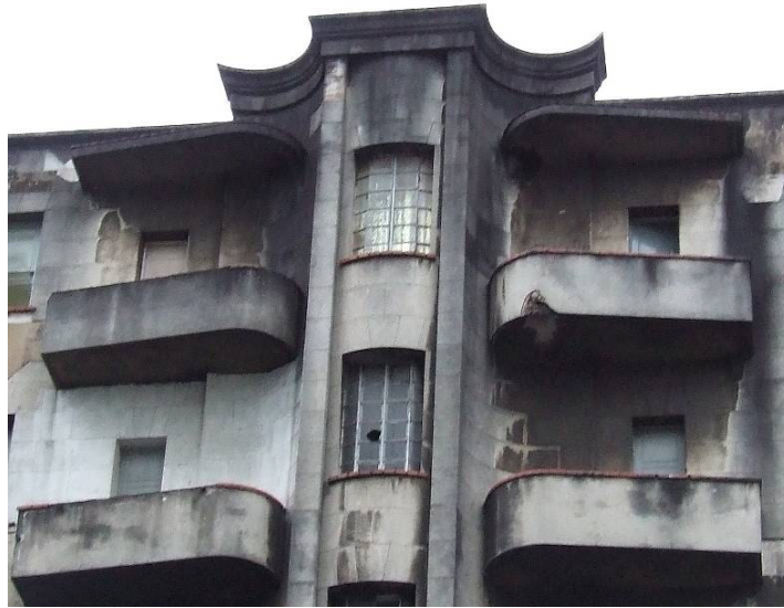
Figura 64 – Detalhe da parte superior do prédio antes da restauração. Fonte: METAMORPHOSE, 2006.
