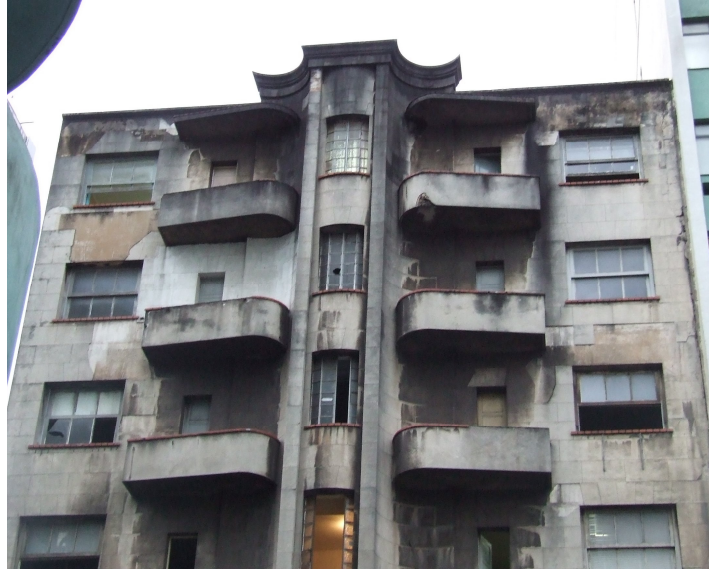
Figura 33 – A fachada encontrava-se em estado precário, com descolamentos em diversos locais.
