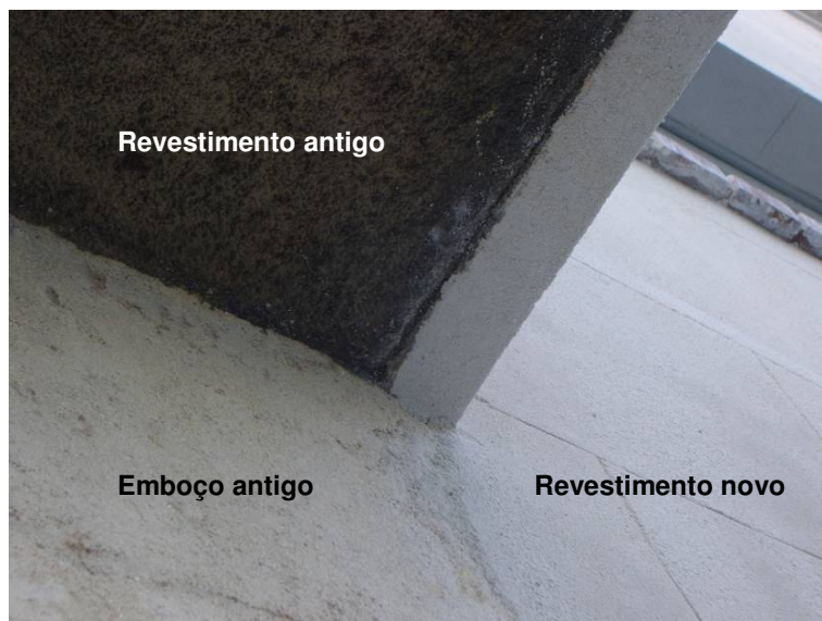
Figura 41 – Detalhe mostrando a interface entre o emboço preexistente, o revestimento antigo (já bastante sujo) e o revestimento novo.
