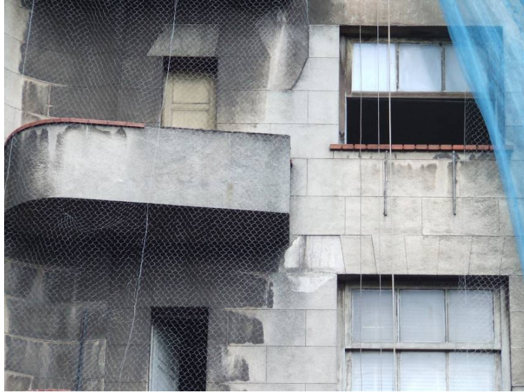
Figura 60 – Detalhe da varanda antes da obra.
