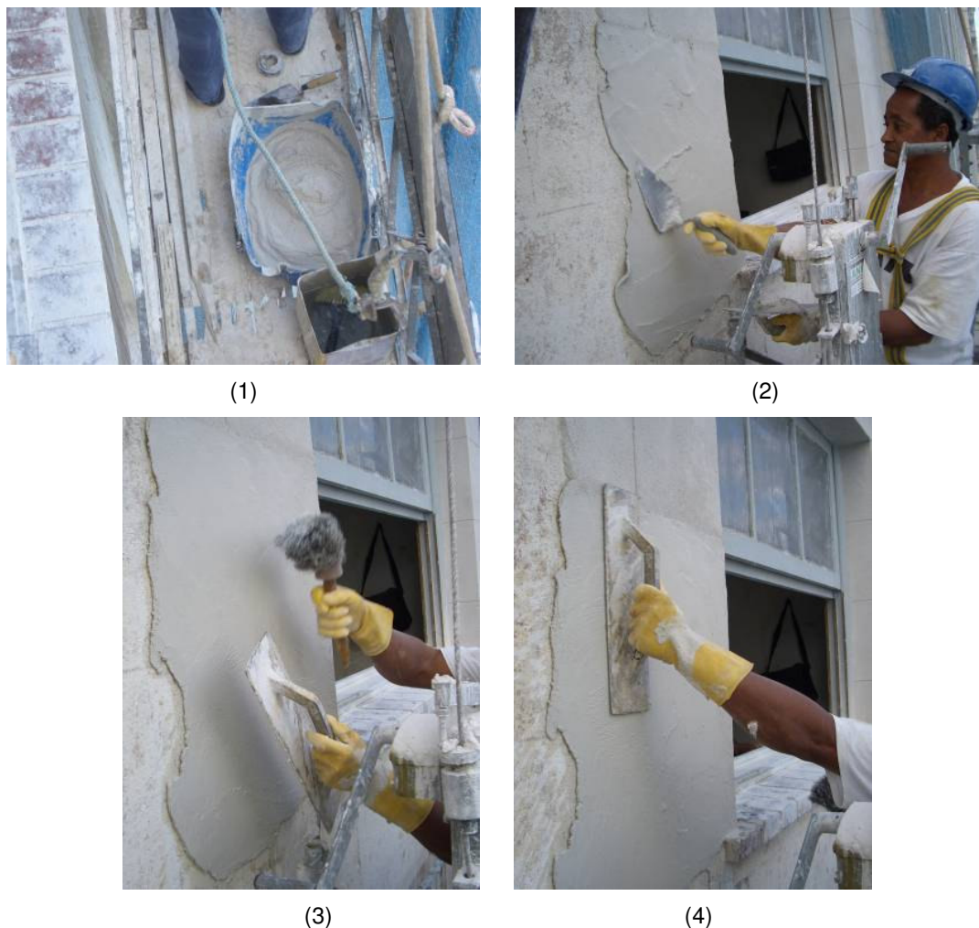
Figura 49 – Aplicação do revestimento em pó-de-pedra: (1) argamassa; (2) aplicação com colher de pedreiro; (3) aspersão de água para facilitar o espalhamento da argamassa; (4) desempeno.
