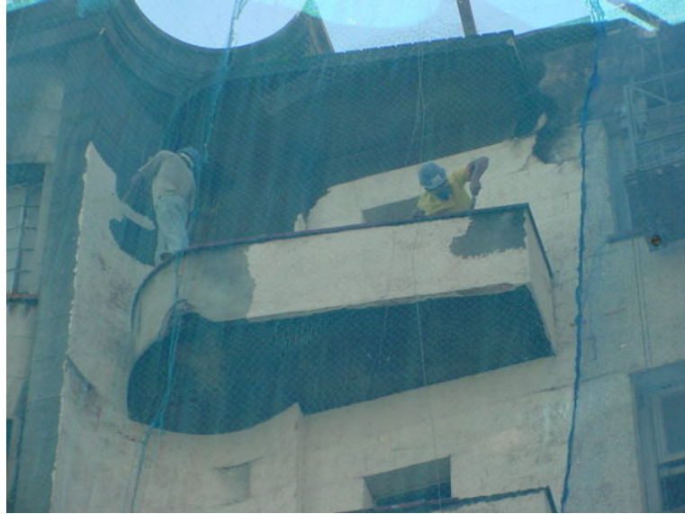
Figura 47 – Recomposição do chapisco/emboço.
