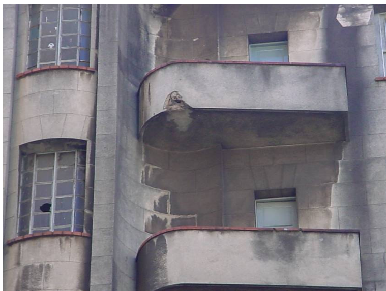
Figura 32 – A sujeira e o desgaste no revestimento demonstram a ausência de manutenção da fachada.
