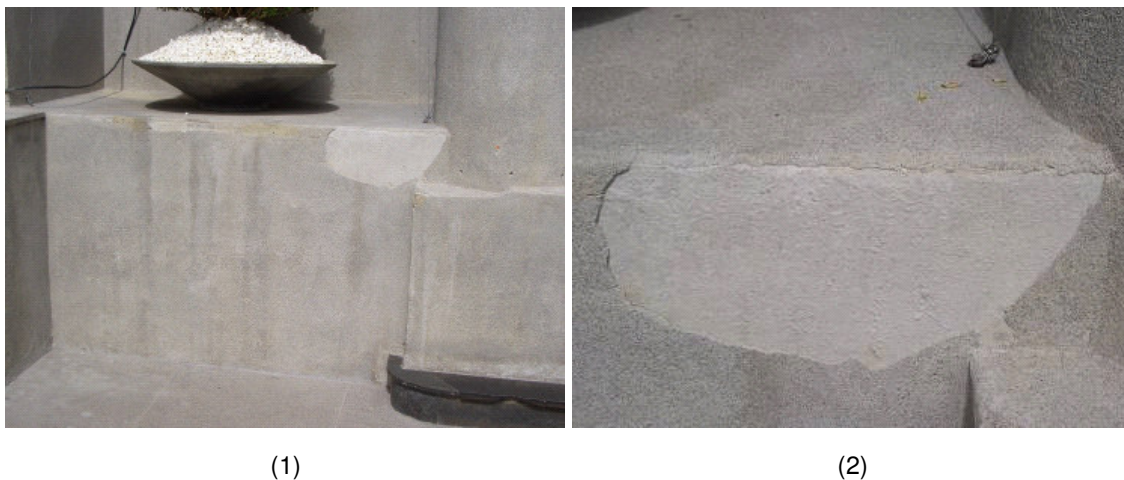
Figura 21 – Patologia no revestimento de pó-de-pedra na fachada de um edifício: (1) vista geral do pano de argamassa; (2) detalhe do descolamento da argamassa.
