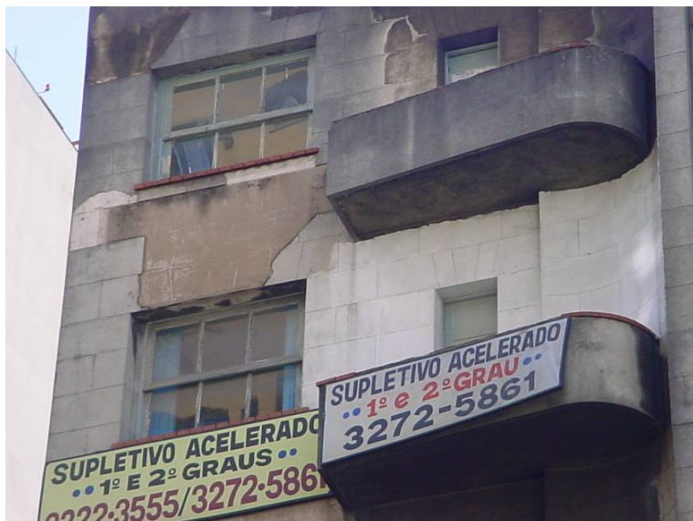
Figura 31 – Descolamentos de grandes panos do revestimento em pó-de-pedra da fachada.
