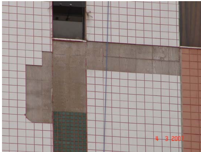
Fotografia 6 – Descolamento de revestimento cerâmico na interface entre argamassa de assentamento e a peça cerâmica.
