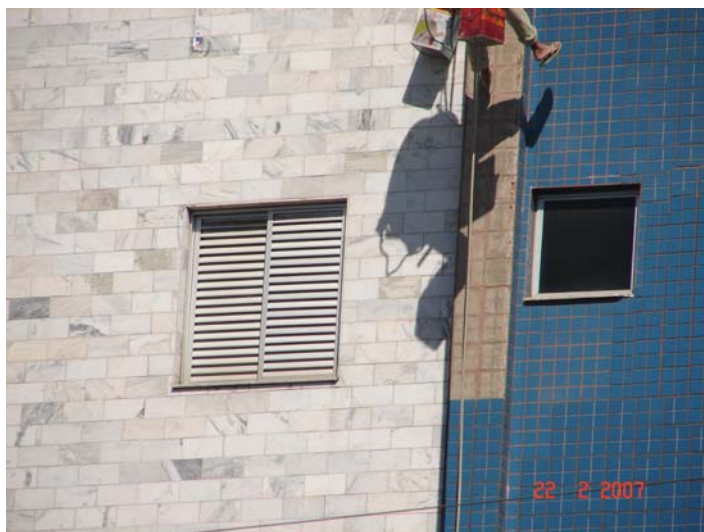
Fotografia 13 – Descolamento de RCF na interface entre a argamassa de assentamento e a peça cerâmica.
