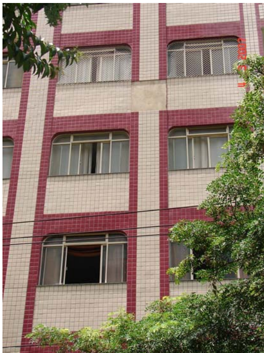
Fotografia 10 – Descolamento de RCF, na interface entre a base e argamassa de regularização.
