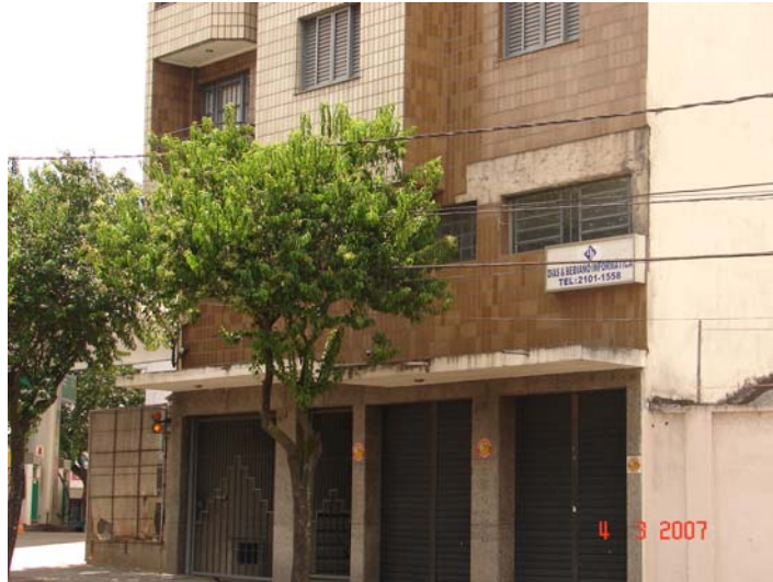
Fotografia 7 – Observa-se patologia em todas as etapas construtivas do RCF.
