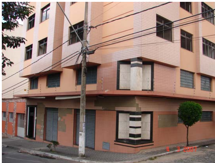
Fotografia 11 – Descolamento de revestimento cerâmico pela deterioração da argamassa de regularização e na interface entre argamassa de assentamento e a peça cerâmica.
