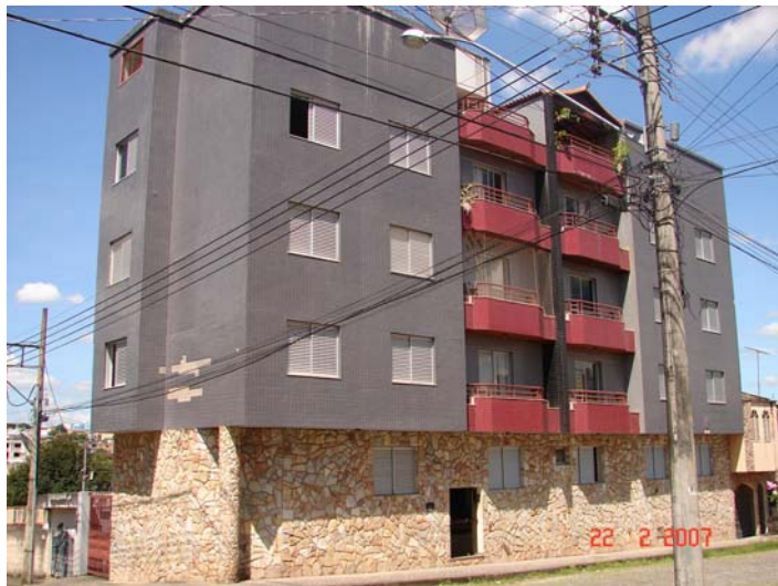
Fotografia 18 – Observa-se patologia em todas as etapas construtivas do RCF.
