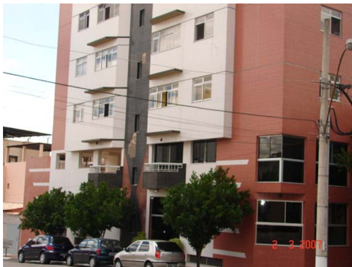
Fotografia 4 – Descolamento de revestimento cerâmico na interface entre argamassa de assentamento e a peça cerâmica.
