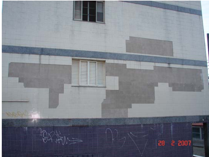
Fotografia 3 – Descolamento de revestimento cerâmico na interface entre argamassa de assentamento e a peça cerâmica.
