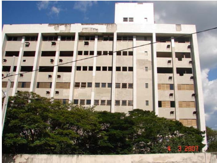
Fotografia 12 – Descolamento de revestimento cerâmico na interface entre argamassa de assentamento e a peça cerâmica.
