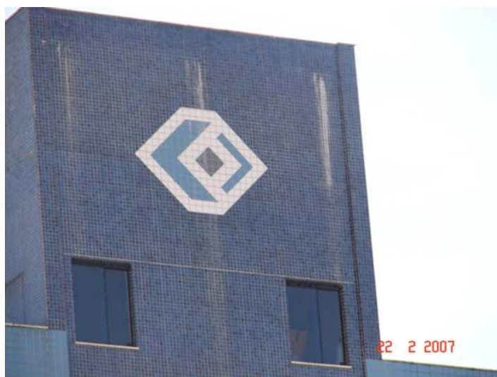
Fotografia 15 – Ocorrência de eflorescências.
