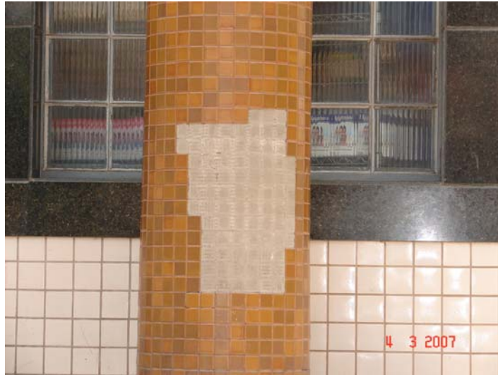
Fotografia 9 – Descolamento de revestimento cerâmico na interface entre argamassa de assentamento e a peça cerâmica.
