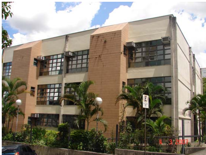
Fotografia 5 – Presença de flora sobre revestimento cerâmico.
