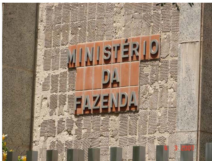
Fotografia 8 – Ocorrência de descolamento de RCF em toda extensão do edifício.
