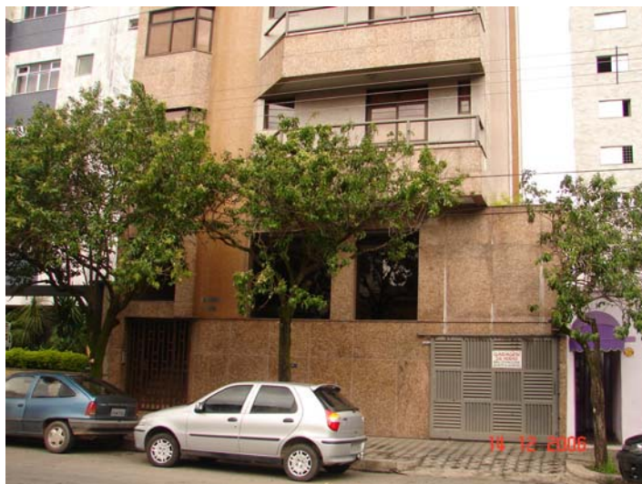
Fotografia 20 – Ocorrência de descolamento de revestimento cerâmico na interface entre a argamassa e a peça cerâmica.
