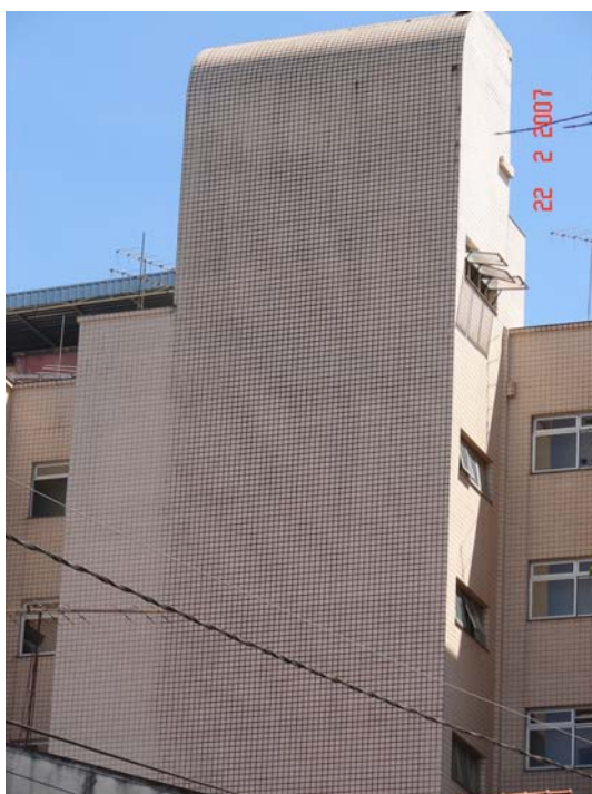
Fotografia 19 – Observa-se a ocorrência de sujidades e presença de flora sobre o RCF.
