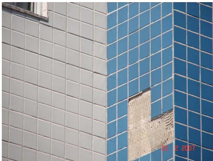
Fotografia 16 – Descolamento de revestimento cerâmico na interface entre argamassa de assentamento e a peça cerâmica.
