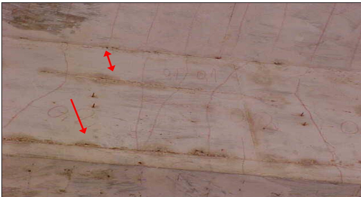
Figura 1 – Fissuras devido à retração do concreto (AGUIAR, 2006)
