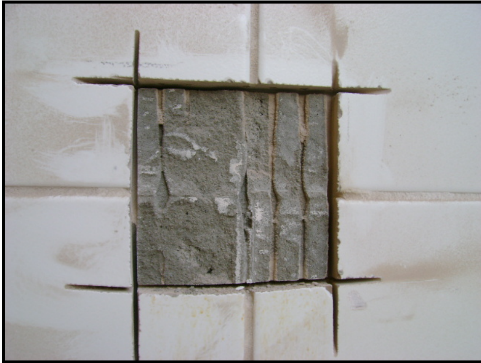
Figura 4.24. – Vista parcial de painel com revestimento cerâmico após arrancamento de um corpo de prova.
