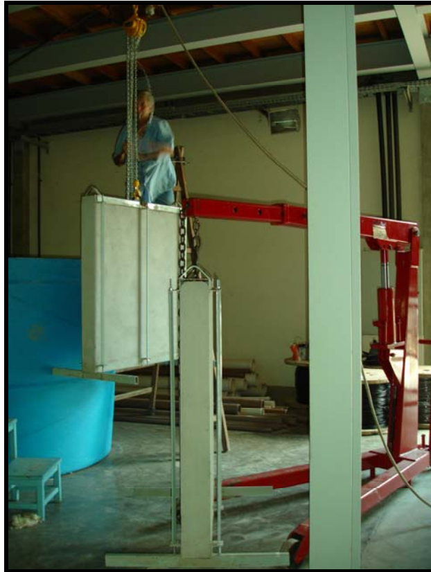
Figura 4.26. – Vista de um painel em deslocamento vertical.
