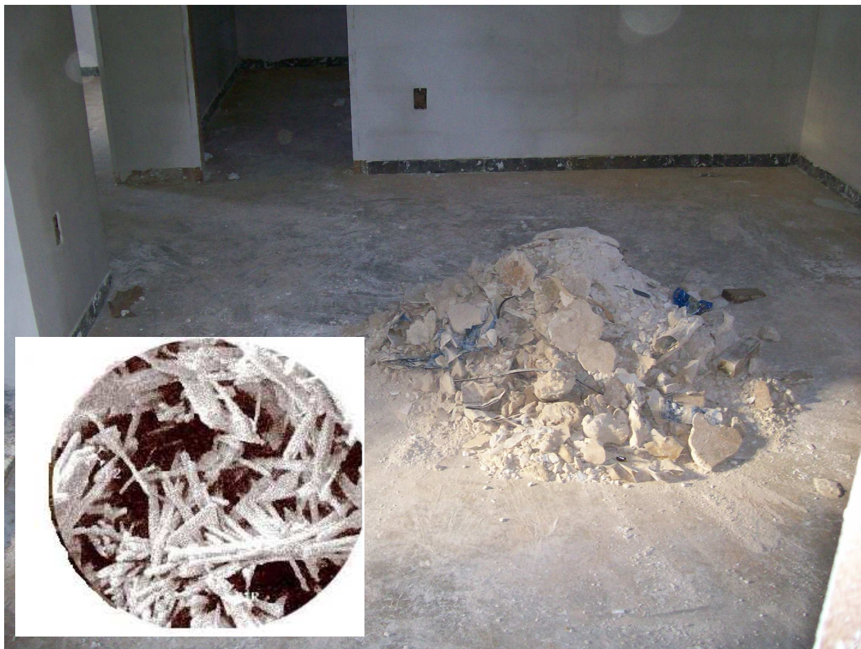
Figura 2.16– Foto do resíduo de gesso em obra em Belo Horizonte e microestrutura do gesso hidratado (NIGLIO e CAMARINI, 2005).
