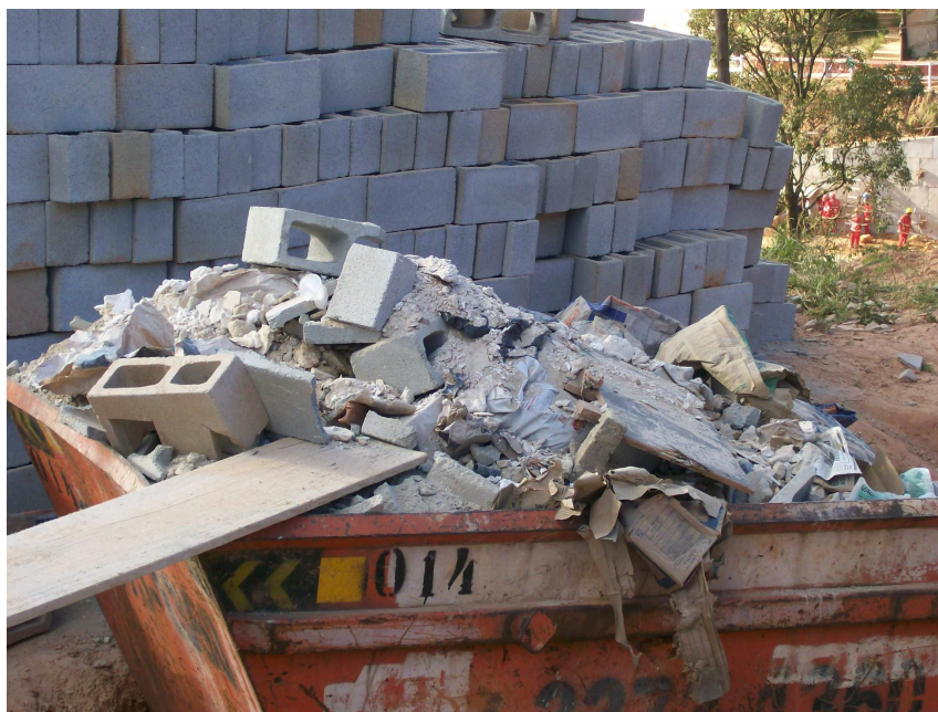
Figura 2.17– Foto do resíduo de gesso lançado em caçamba junto com outros materiais em obra do Programa Vila Viva em Belo Horizonte.
