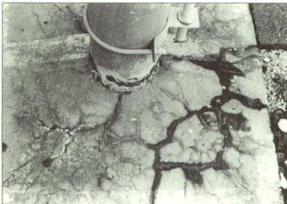
Figura 2.27 - Fissuração na base de concreto armado, de uma torre de rede elétrica, devido ao cimento apresentar um alto teor de sulfatos (THOMAZ, 2003).
