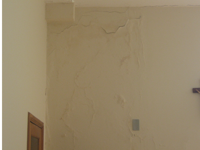
Figura 4.71 – Infiltração devido ao recalque de fundação na ligação entre anexo e edificação principal
