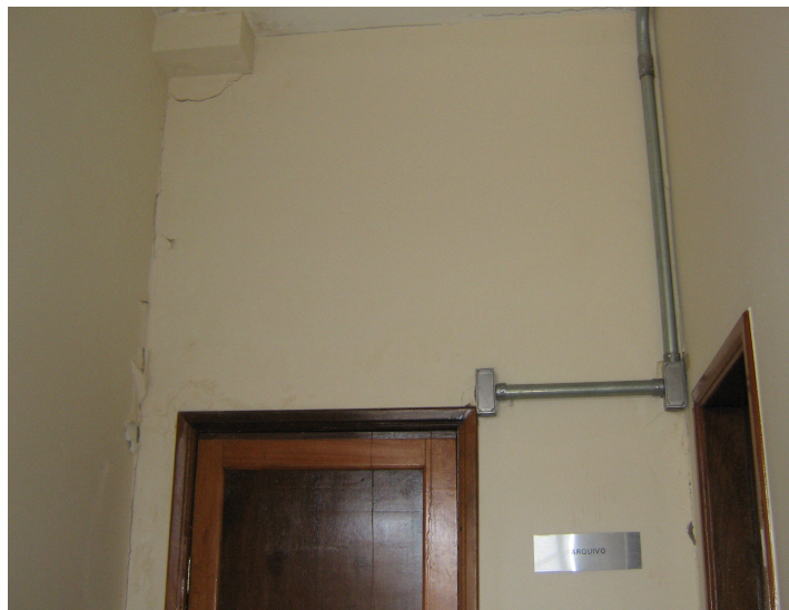
Figura 4.70 – Trinca na ligação entre anexo e edificação principal
