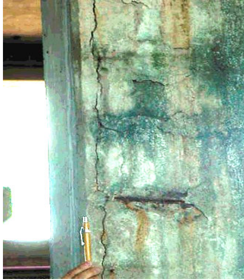
Figura 2.23 – Detalhe de deslocamento da estrutura devido à ação da umidade.
