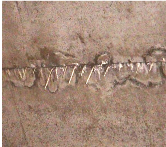
Figura 2.21 – Detalhe de eflorescência “estalactite” na estrutura.
