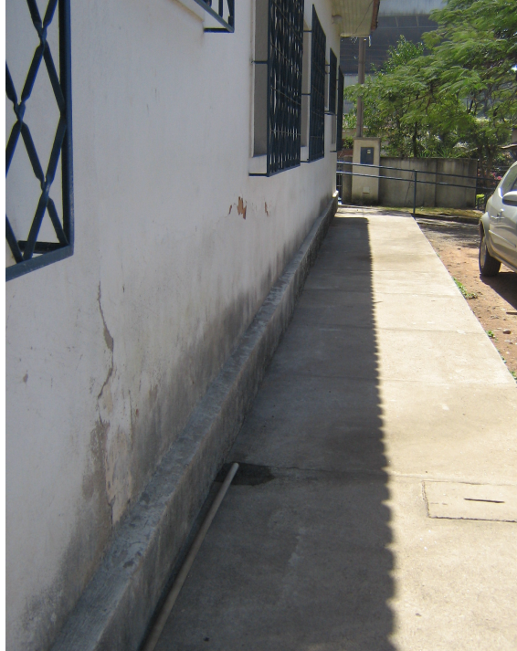
Figura 4.81 – Base da casa com alguns pontos de infiltração
