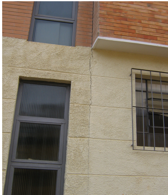
Figura 4.72 – Trinca na fachada - ligação entre anexo e edificação principal
