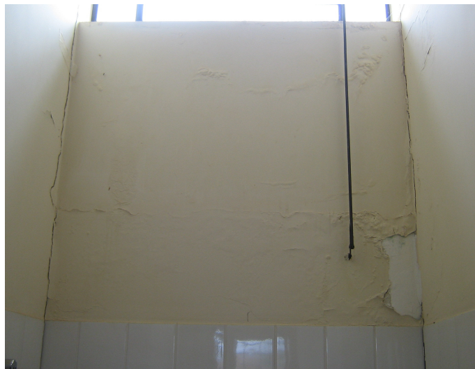
Figura 4.68 – Trinca e infiltração nos sanitários do 2º pavimento na ligação entre anexo e edificação principal.
