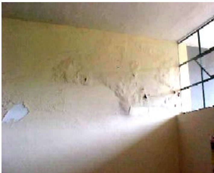
Figura 4.13 – Pintura soltando na parede de uma das salas, localizadas abaixo do reservatório.
