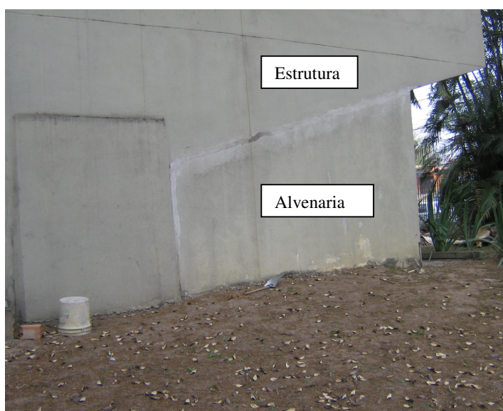
Figura 4.61 – Vista externa da trinca inclinada do 2º pavimento.
