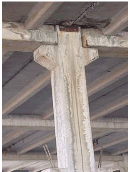
Figura 2.18 – Exemplo de manchas na estrutura, devido problemas de impermeabilização.
