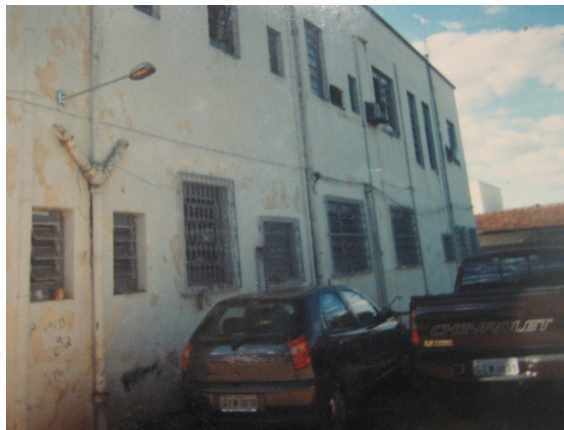
Figura 4.31 – Situação do reboco da fachada antes do tratamento
