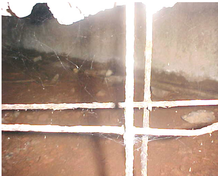
Figura 4.12 – Abertura realizada no abrigo, mostrando sinal de vazamento.
