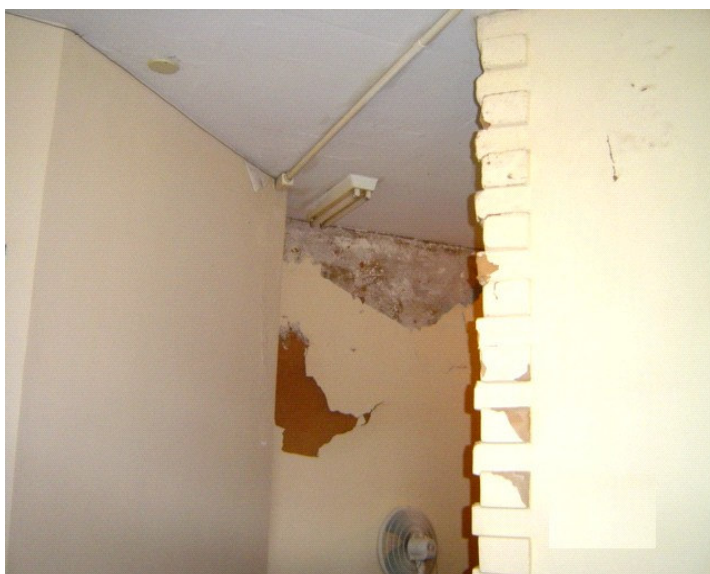
Figura 4.14 – Pintura soltando na parede da lateral direita, localizada abaixo do reservatório.
