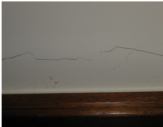
Figura 4.67 – Trinca sobre a porta na ligação entre anexo e edificação principal
