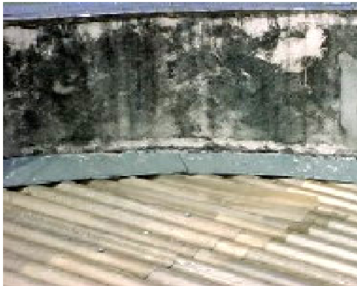
Figura 4.41 – Detalhe das trincas na platibanda.
