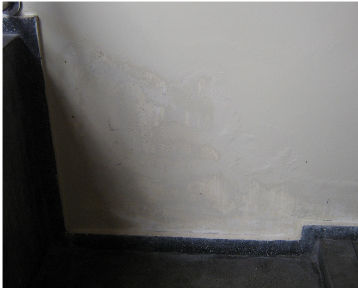
Figura 4.73 – Parede do subsolo com sinais de infiltração
