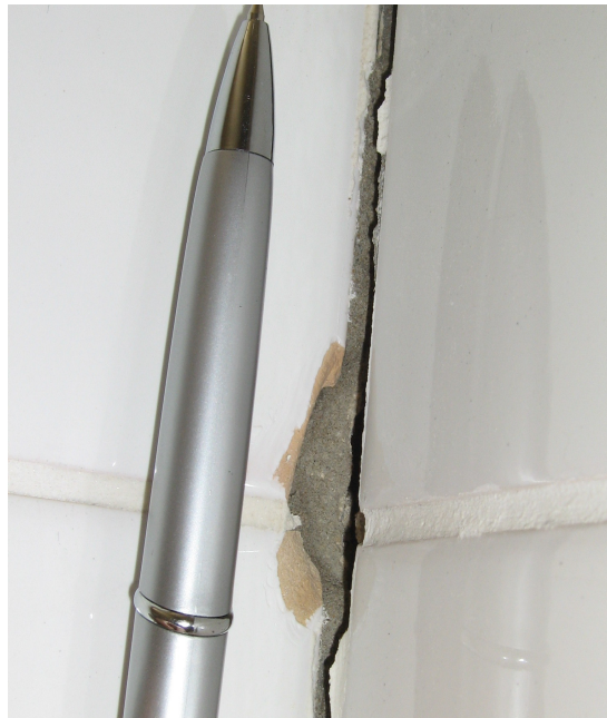
Figura 4.69 – Trinca nos sanitários do 2º pavimento na ligação entre anexo e edificação principal
