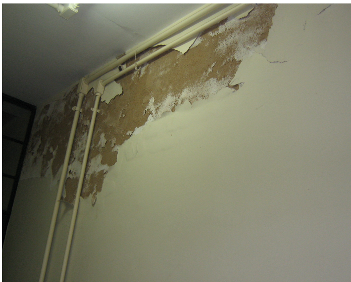
Figura 4.57 – Infiltração na parede da lateral esquerda.
