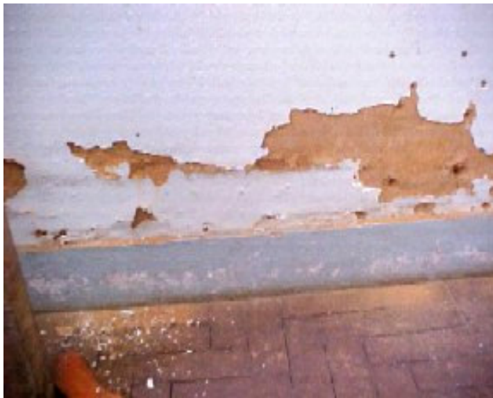
Figura 4.8 – Desplacamento da argamassa de revestimento.
