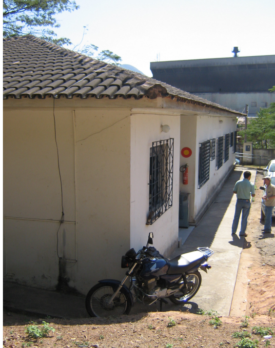
Figura 4.80 – Base da casa com alguns pontos de infiltração
