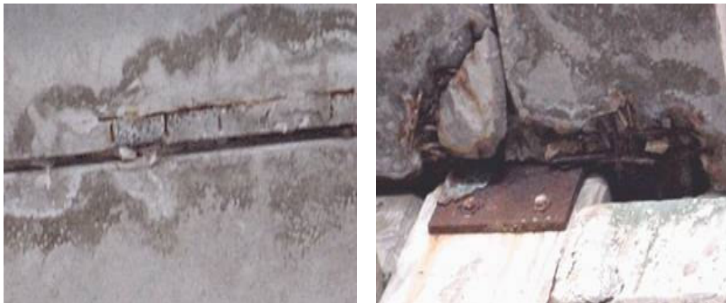
Figura 2.20 – Exemplo de oxidação da armadura, devido a problemas de umidade.
