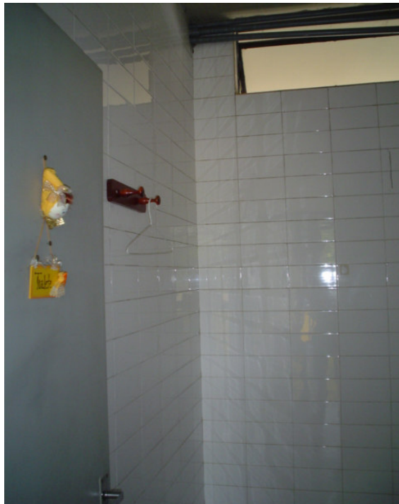
Figura 4.62 – Local de tratamento das trincas de recalque de fundação.
