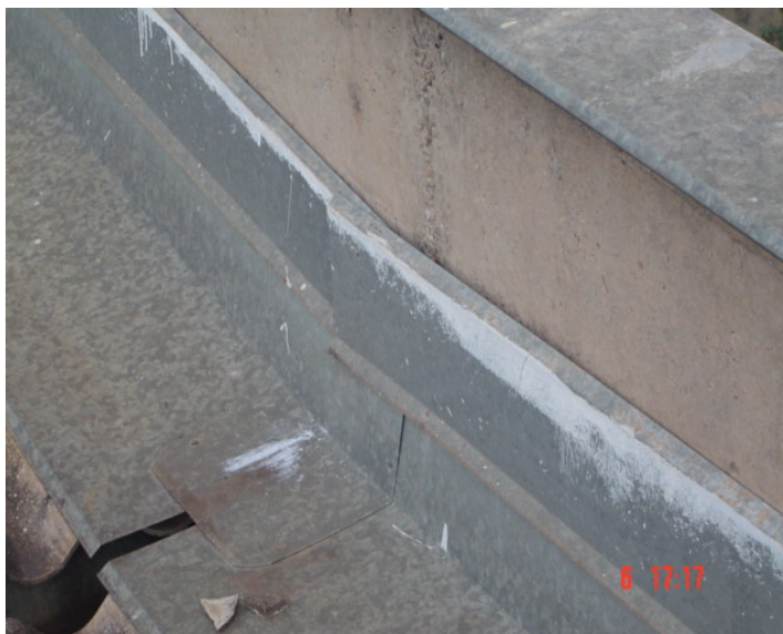
Figura 4.58 – Rufo soltando da platibanda.
