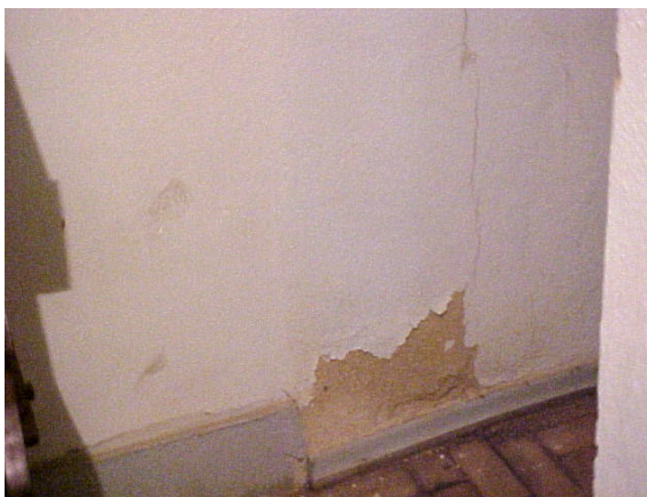
Figura 4.7 – Infiltração na base das edificações.
