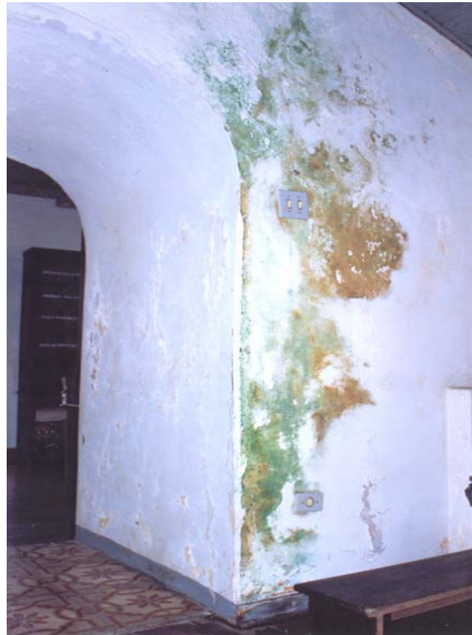
Figura 2.19 – Exemplo de manchas, infiltração, mofo e bolor.
