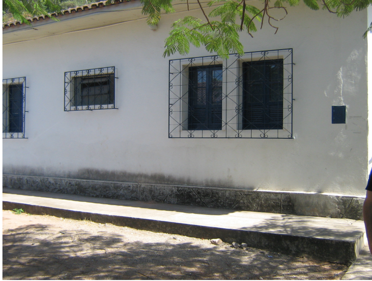
Figura 4.44 – Infiltração na base da casa
