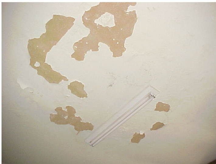
Figura 4.28 – Infiltração no teto do 2º pavimento
