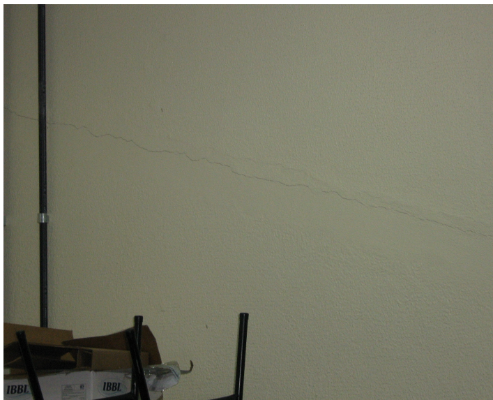
Figura 4.59 – Trinca inclinada no 2º pavimento.
