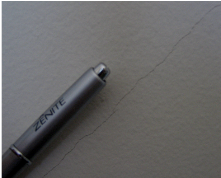
Figura 4.64 – Trinca de reboco em uma sala do 1º pavimento.
