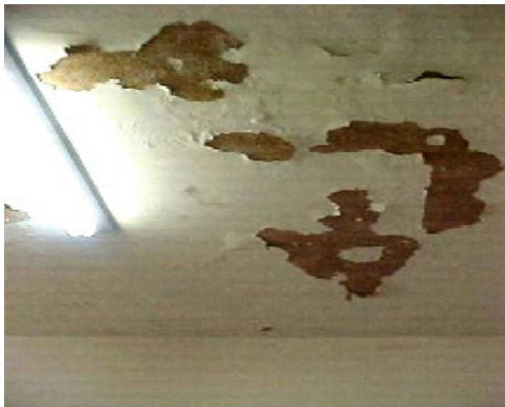
Figura 4.5 – Pintura soltando do teto em Bambuí – 2º pavimento.
