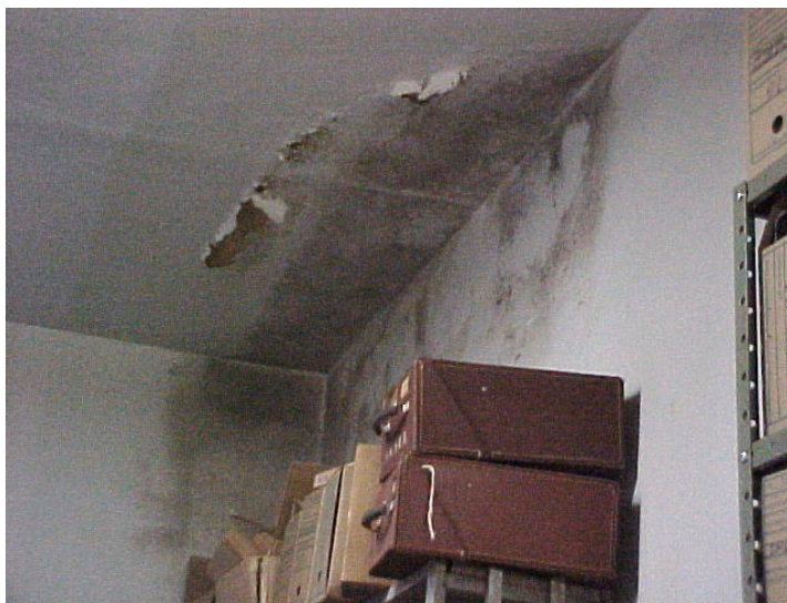
Figura 4.6 – Infiltração com mofo no teto da edificação – 1º pavimento (Anexo 1).
