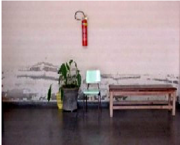
Figura 4.40 – Infiltração na parede do hall do subsolo.
