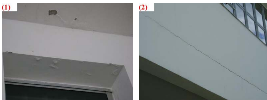
Figura 4.2 - Patologias identificadas no prédio “B” - (1) início da desagregação do revestimento devido à pulverulência; (2) fissura horizontal na interface da viga com alvenaria.
