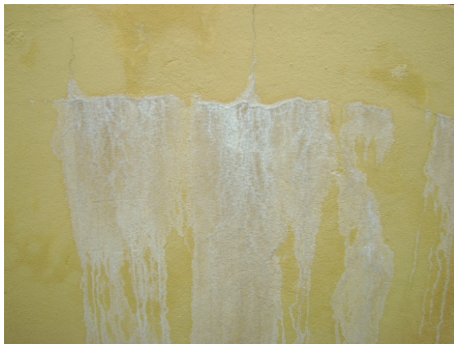
Figura 2.27 - Eflorescência – cristalização dos sais solúveis na superfície da argamassa de revestimento no prédio “L” do estudo de caso
