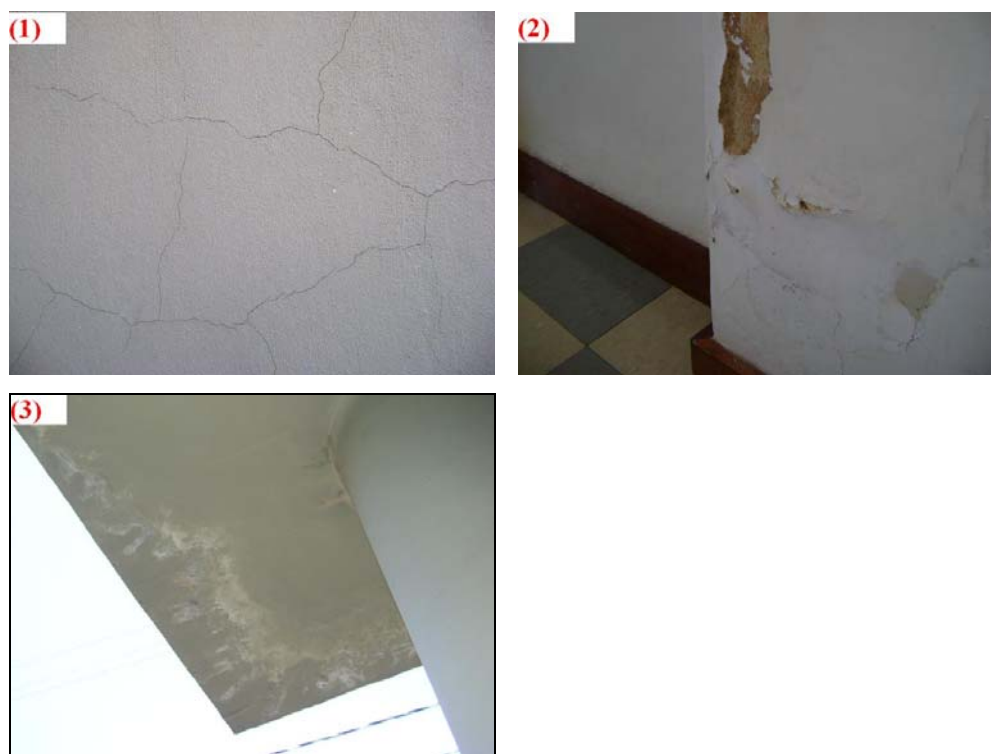
Figura 4.1 – Patologias identificadas no prédio “A” - (1) fissuras de retração; (2) descolamento com pulverulência; (3) eflorescência
