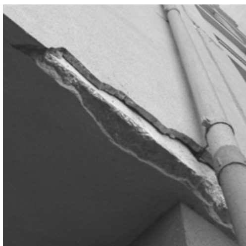
Figura 2.31 - Destacamento de reboco rígido (SILVA e ABRANTES, 2007)
