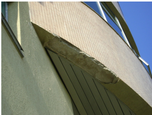
Figura 5.8 - Descolamento do revestimento de argamassa aplicado sobre face inferior da viga - prédio “F” do estudo de caso.
