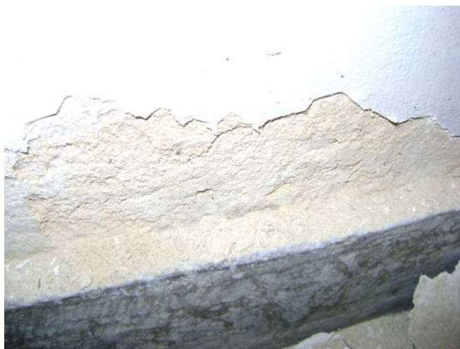
Figura 2.29 - Argamassa perde a coesão tornando-se pulverulenta - prédio “C” do estudo de caso
