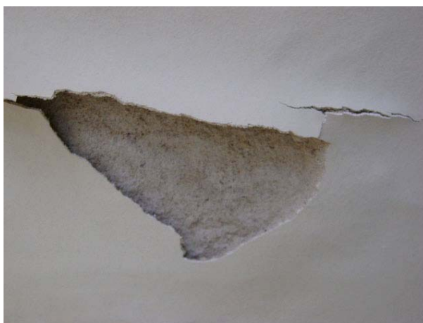
Figura 2.36 - Desagregação com descolamento do revestimento devido à infiltração de água na fachada - prédio “E” do estudo de caso.
