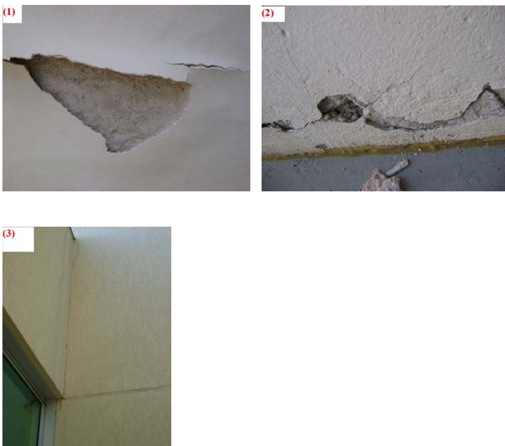
Figura 4.5 - Patologias identificadas no prédio “E” - (1) descolamento com pulverulência; (2) descolamento em placas; (3) fissura vertical na fachada
