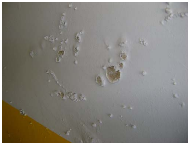
Figura 2.23 - Vesículas formadas no reboco - prédio “C” do estudo de caso
