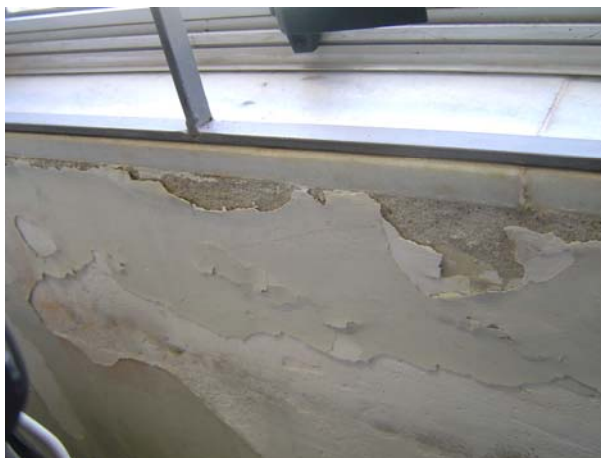
Figura 2.35 - Deterioração do reboco devido à infiltração de água pela janela - prédio “M” do estudo de caso.
