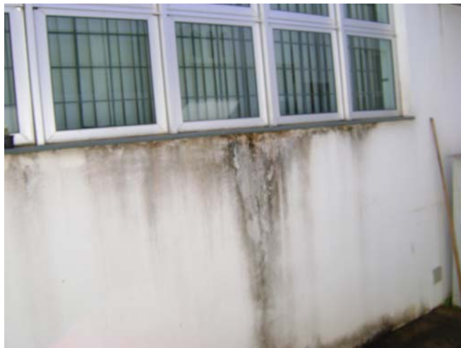
Figura 2.33 - Bolor abaixo do peitoril da janela - prédio “J” do estudo de caso.
