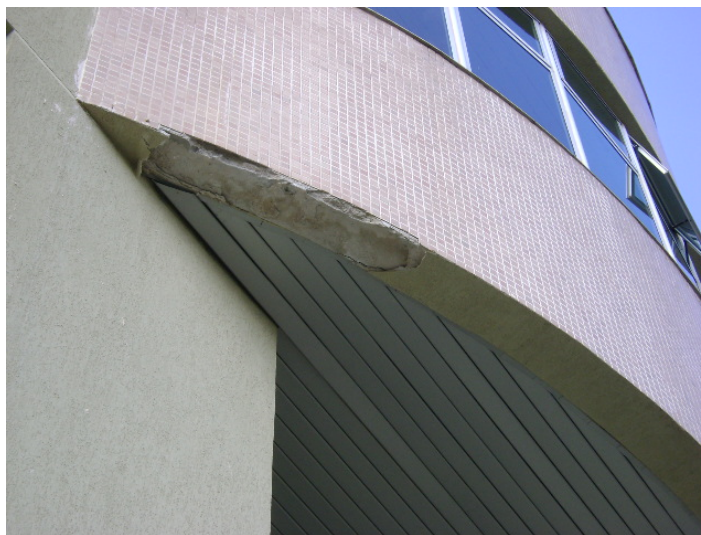
Figura 1.2 - Deslocamento de revestimento de argamassa executado sobre a viga da fachada – prédio “F” do estudo de caso.
