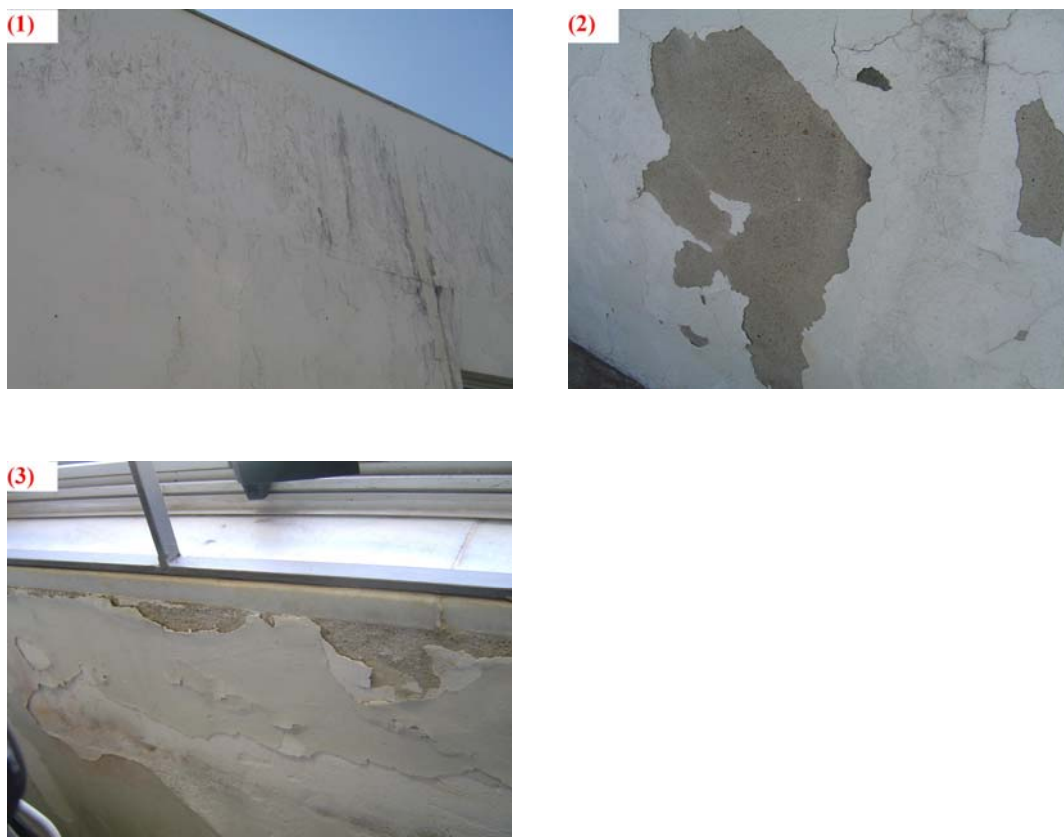
Figura 4.13 - Patologias identificadas no prédio “M” - (1) formação de bolor no revestimento da fachada; (2) fissuras de retração; (3) descolamento com pulverulência
