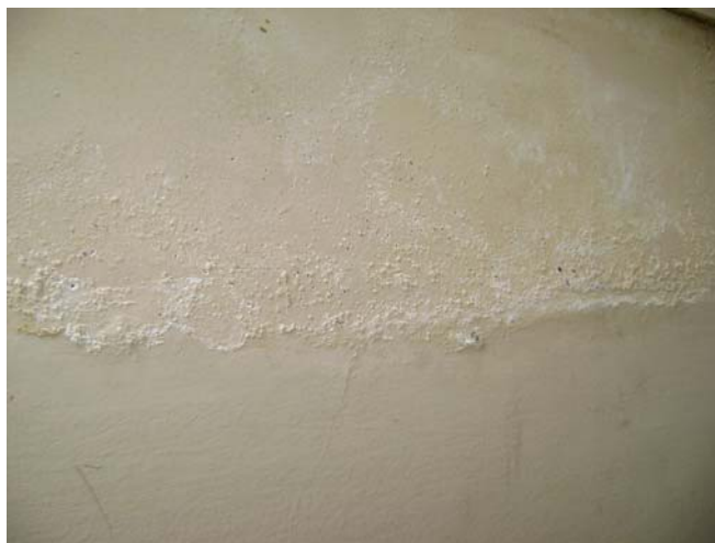
Figura 2.26 - Eflorescência no revestimento interno do Fórum de Leopoldina
