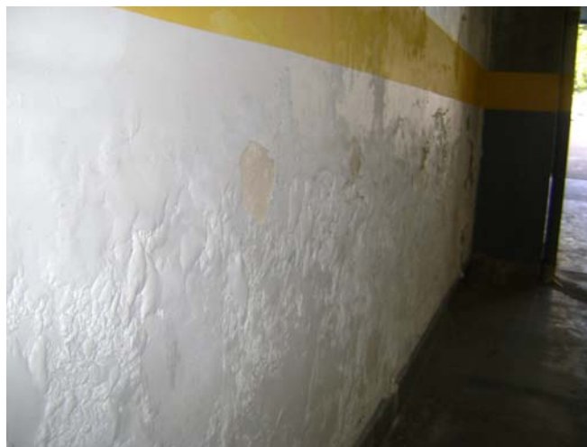
Figura 2.28 - Argamassa pulverulenta nos pontos empolados e facilmente removível, exposta a umidade ascendente - prédio “C” do estudo de caso
