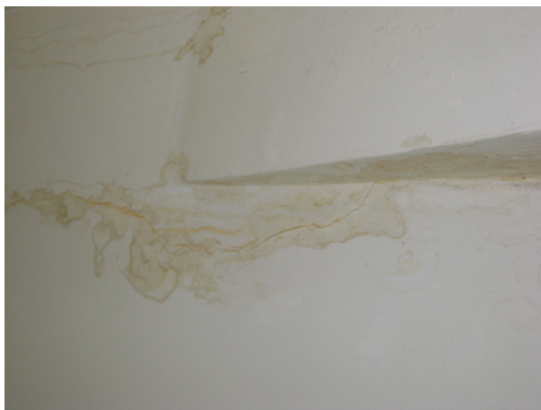
Figura 5.9 - Presença de “bolor” devido à infiltração de água pela cobertura – prédio “L” do estudo de caso.
