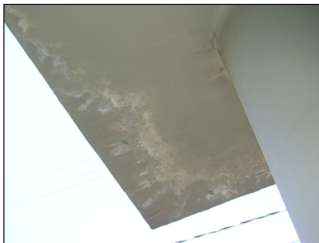
Figura 2.25 - Eflorescência na laje de cobertura do hall de entrada – prédio “A” do estudo de caso
