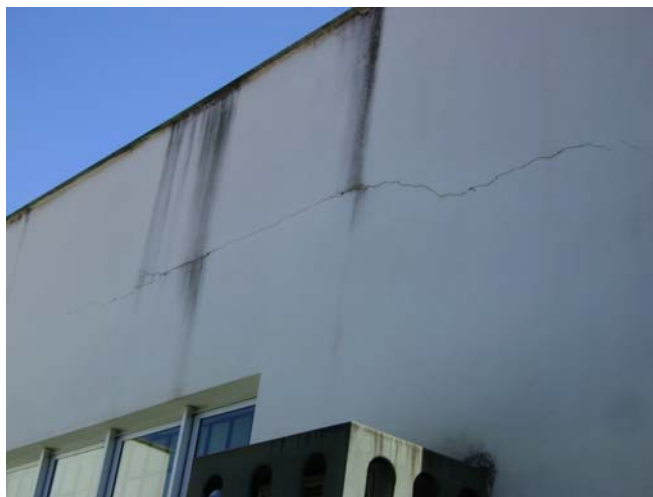
Figura 2.34 - Bolor na fachada abaixo do chapim da platibanda - prédio “J” do estudo de caso.
