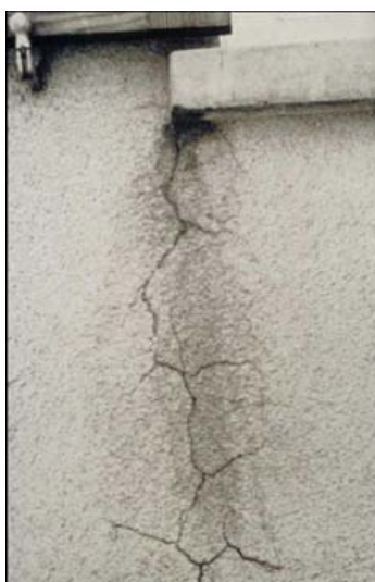
Figura 2.20 - O fluxo de água interceptado do peitoril da janela escorre lateralmente, provocando a fadiga do reboco desenvolvendo sua fissuração (THOMAZ, 1989).
