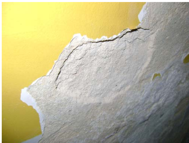
Figura 2.30 - Descolamento devido à pulverulência da argamassa - prédio “C” do estudo de caso
