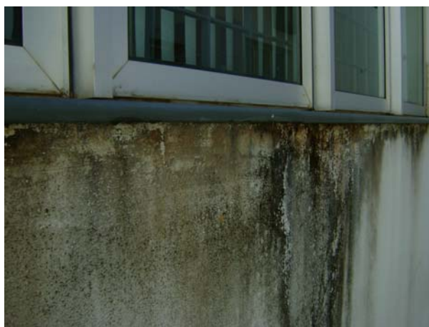
Figura 5.10 - Formação de mofo devido às deficiências do peitoril da janela – prédio “J” do estudo de caso.
