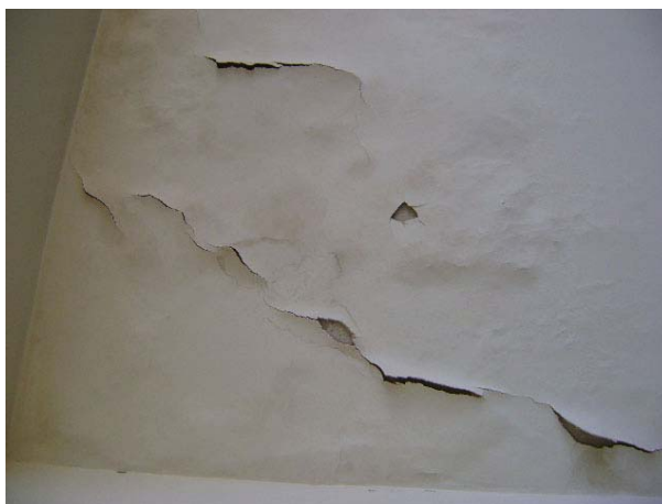
Figura 2.37 - Desagregação com descolamento do revestimento devido à infiltração de água na fachada - prédio “E” do estudo de caso.
