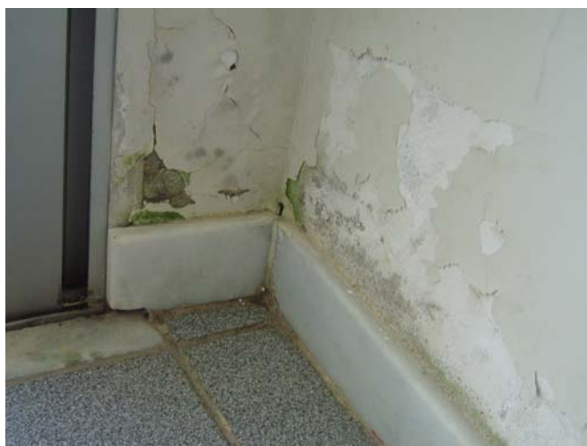
Figura 2.32 - Início do aparecimento de fungos no revestimento devido à umidade ascensional - prédio “M” do estudo de caso.
