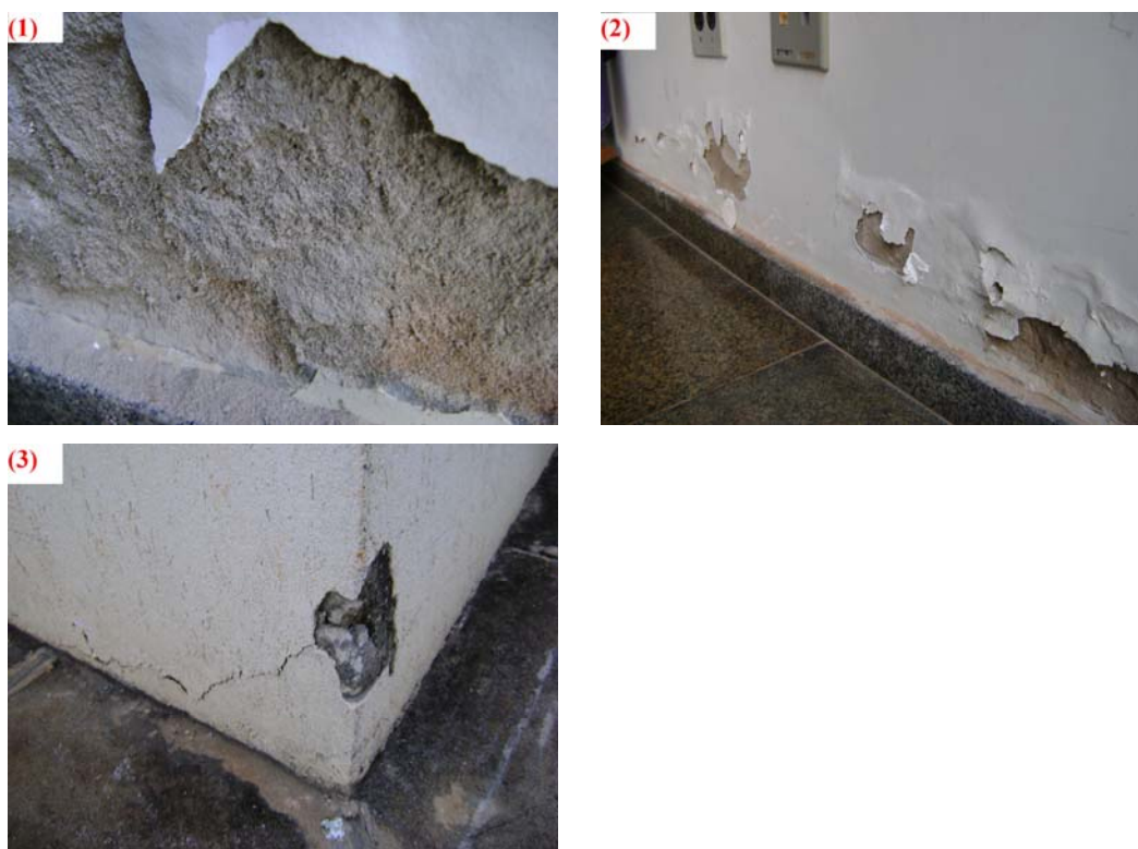
Figura 4.14 - Patologias identificadas no prédio “N” - (1) desagregação do reboco devido à pulverulência; (2) descolamento com pulverulência; (3) fissuras e início do descolamento de parte do revestimento
