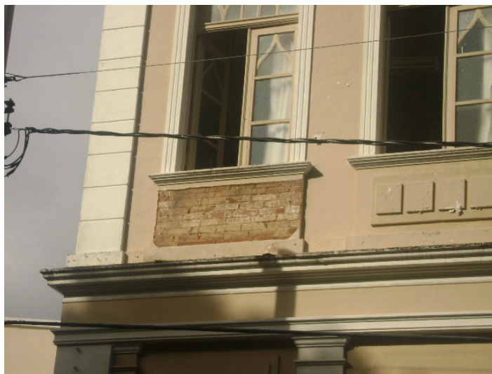
Figura 1.1 - Deslocamento de revestimento em fachada no Fórum de Leopoldina
