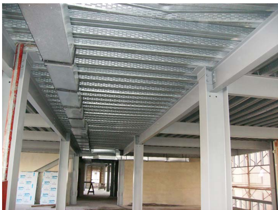
Figura 5.3 - Dutos horizontais para passagem das instalações.
