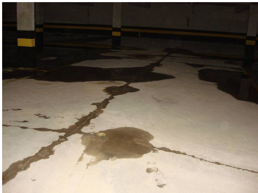
Figura 30 – Infiltração de água pelo piso Fonte: Acervo da autora.
