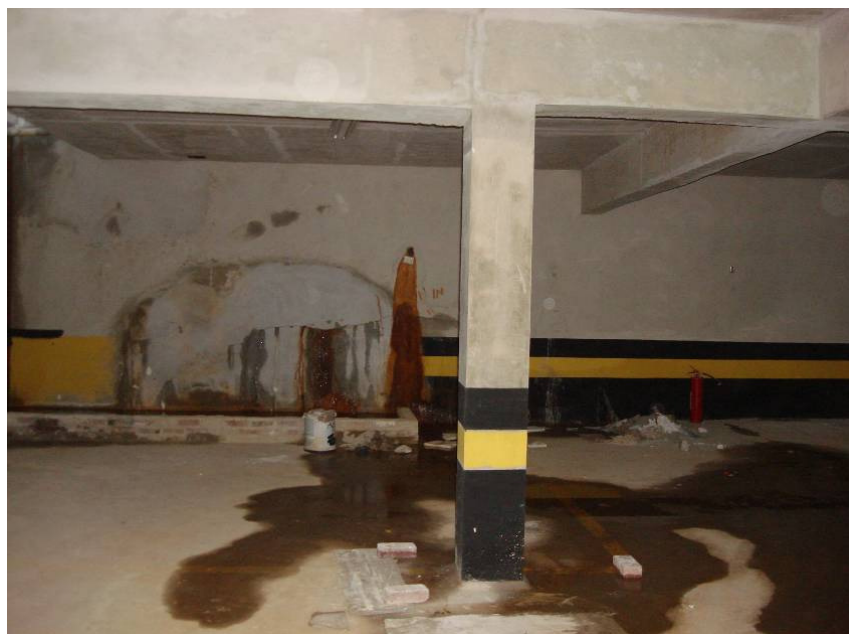
Figura 29 – Infiltração de água pela parede Fonte: Acervo da autora.
