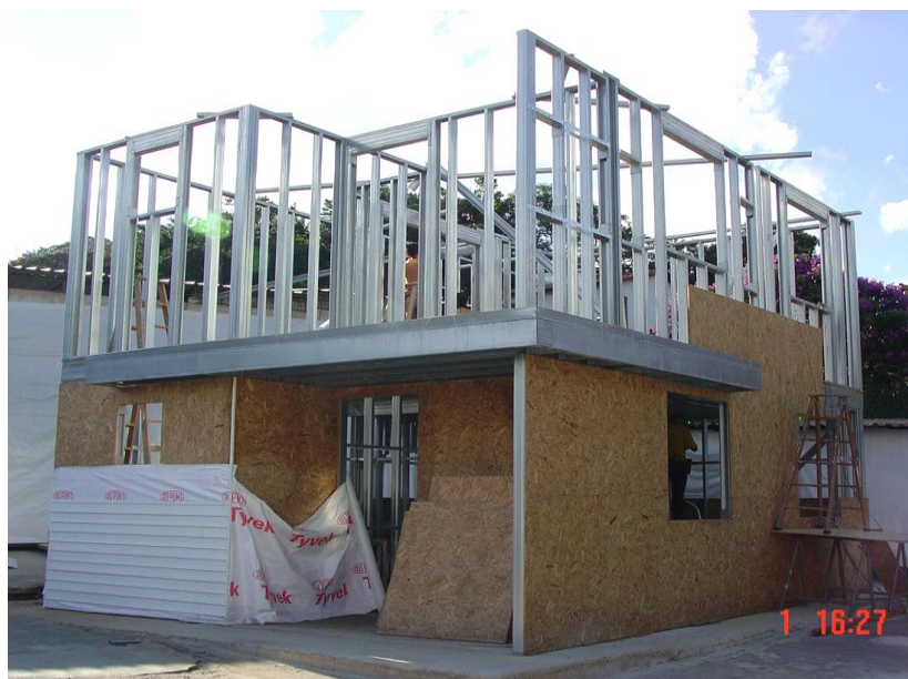
FIGURA 18 – Siding Vinílico aplicado sobre placa de OSB revestido com manta hidrófuga (Fonte: Usiminas, 2004).
