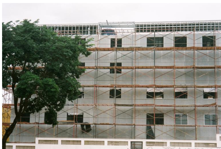
FIGURA 17 – Placa cimentícia externa (Arquivo do autor, 2009).
