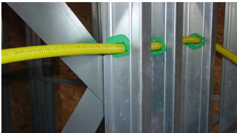
FIGURA 29 – Tubulação elétrica (Fonte: Usiminas – 2004).
