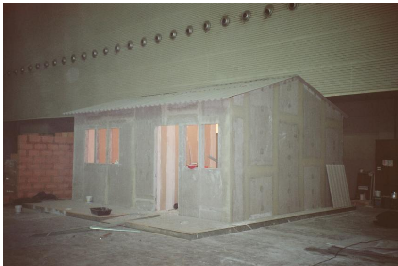
FIGURA 49 – Segundo dia de montagem do protótipo: fechamento dos painéis verticais internos e externos, cobertura (Fonte: Arquivo do autor, 2008).
