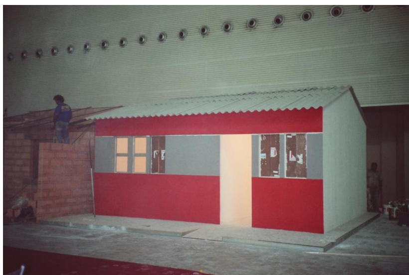
FIGURA 50 – Terceiro dia de montagem do protótipo: instalações elétricas, instalação das janelas, primeira demão de pintura (Arquivo do autor, 2008).
