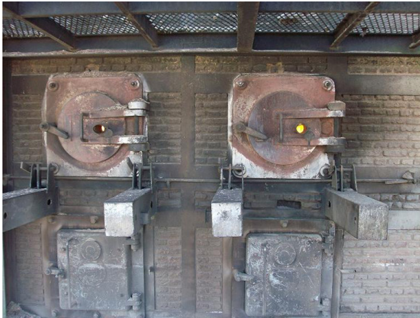
Figura 4.5 - Vista das fornalhas da caldeira.
