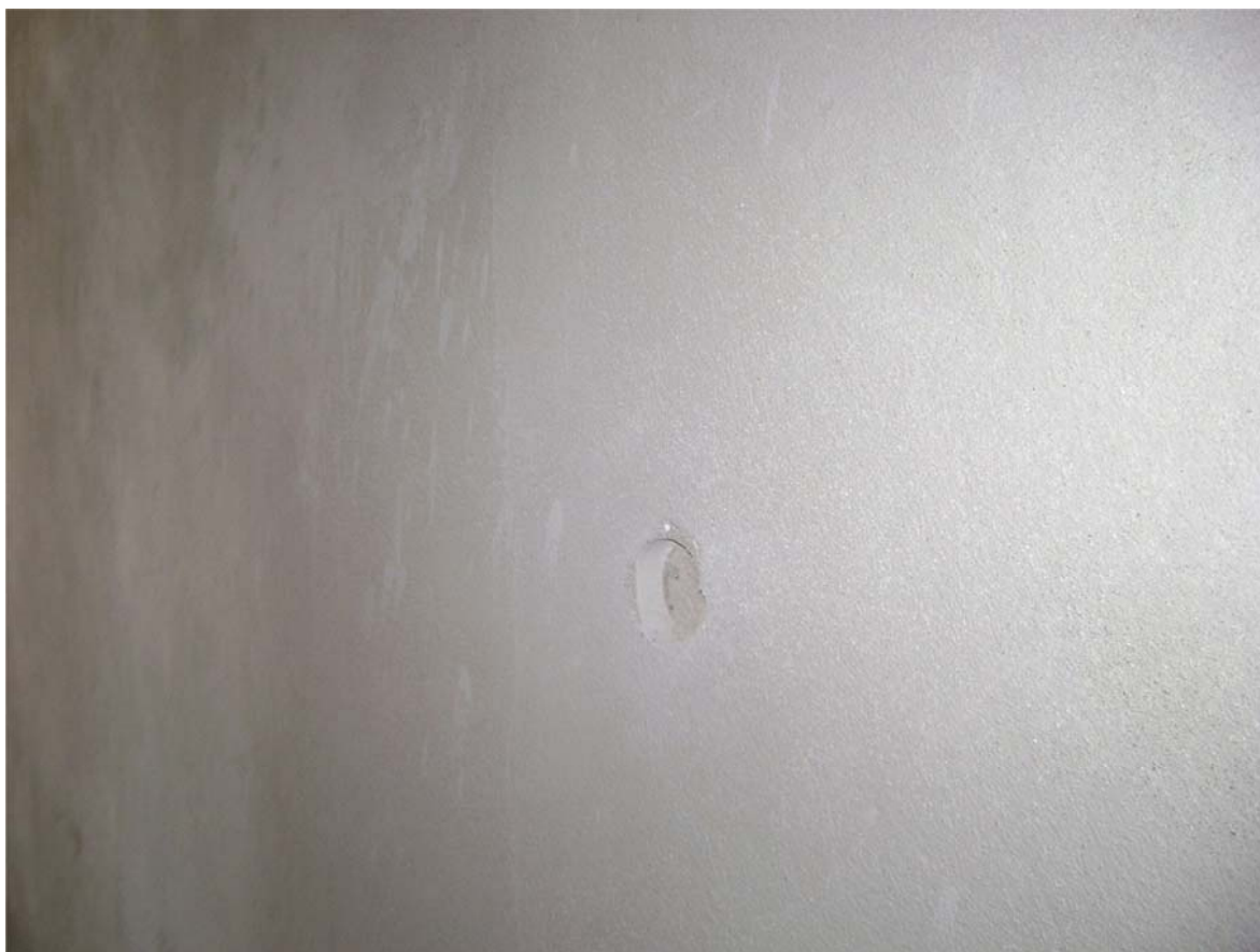
Figura 41 - Análise visual para detectar fissuras no revestimento com a argamassa 2.
