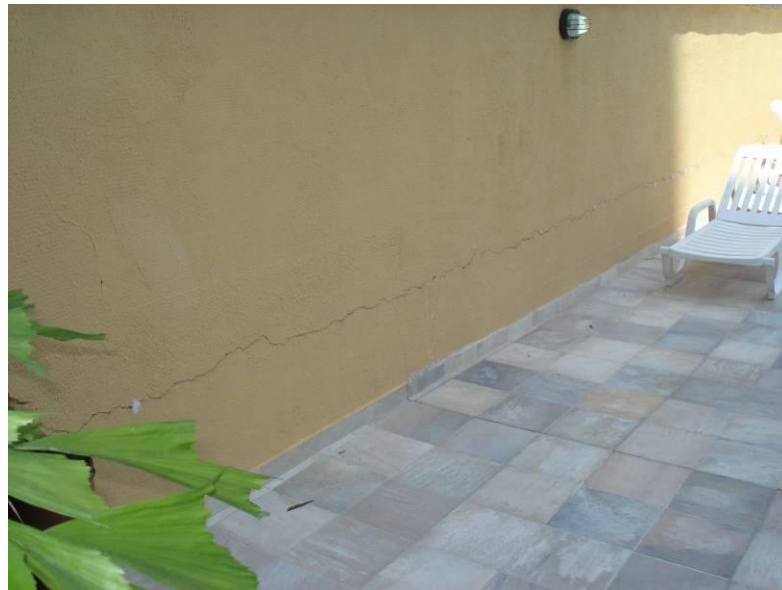
Figura 23 - Trinca no muro resultante de dilatação térmica da laje
