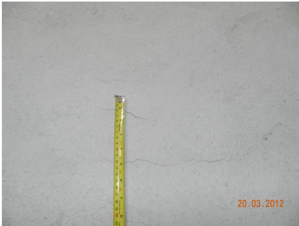
Figura 87 - Fissuras de retração após a execução do reboco da parede PAR-2.
