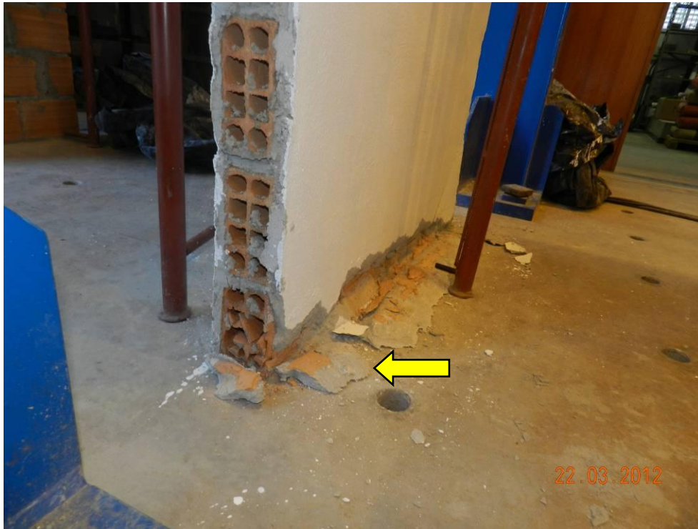
Figura 91 - Reboco deslocado da parede. Configuração inclinada sugere rompimento por cisalhamento.
