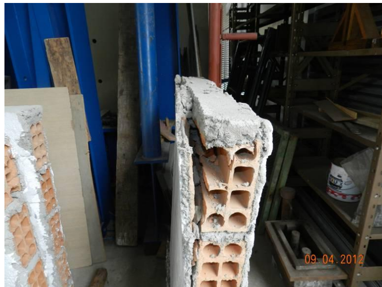
Figura 112 - Parede rompida por esmagamento da parte central devido à flexão do capeamento que estava apoiado nos rebocos.
