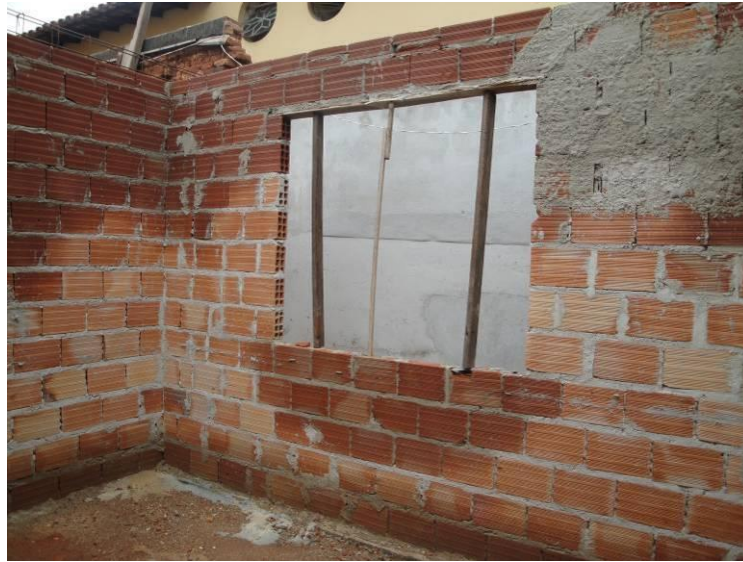
Figura 37 - Vão de janela sem os devidos cuidados de execução de verga e contra-verga. Acervo próprio.
