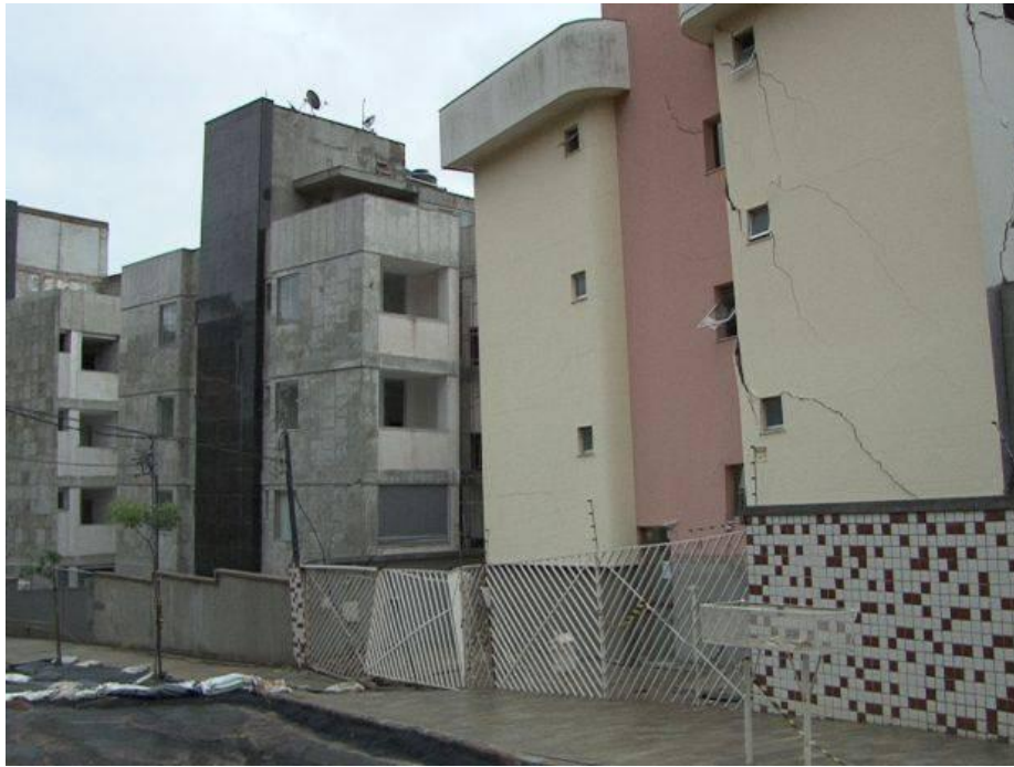
Figura 45 - Formação de rachaduras devido a recalque diferencial de fundação. 18
