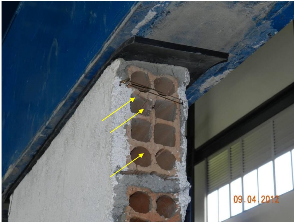
Figura 109 - Aparecimento de fissuras nos septos centrais do bloco durante a etapa 3.
