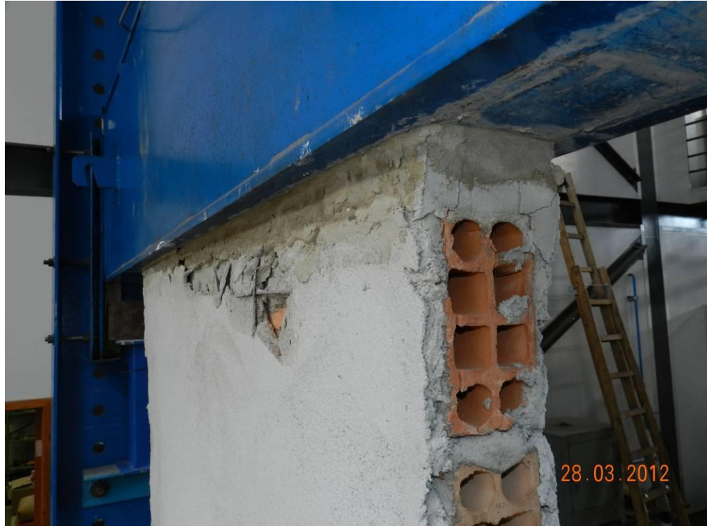
Figura 97 - Flambagem da tela soldada, que induziu ao deslocamento do reboco na PAR-3.
