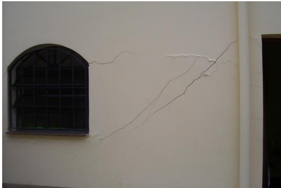
Figura 44 - Formação de fissuras devido a recalque diferencial 17 .
