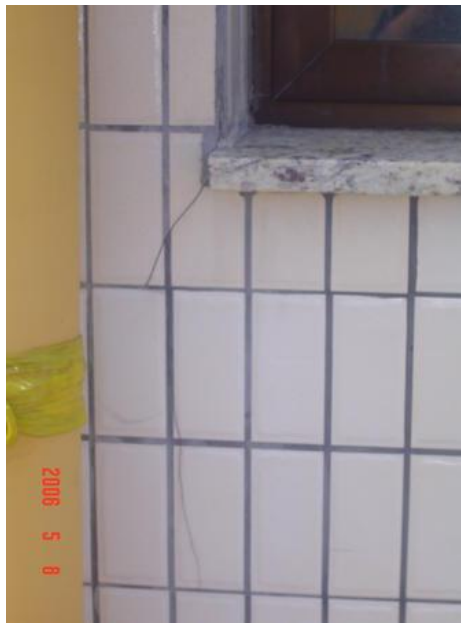
Figura 36 - Fissura no canto da janela ocasionada pela ausência de vergas 16 .
