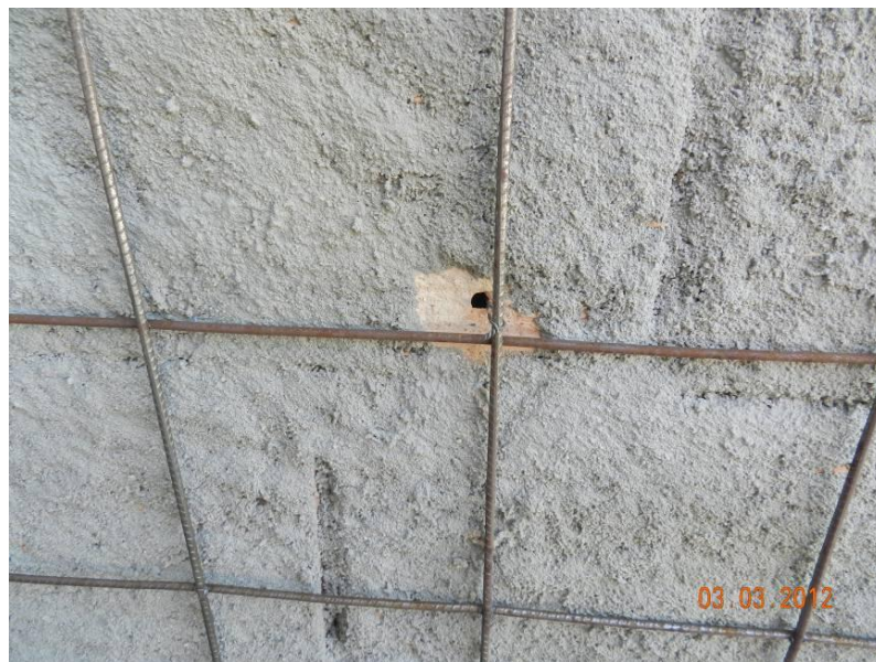
Figura 72 - Detalhe do furo na alvenaria pelo qual era passado o arame que fixa as telas.
