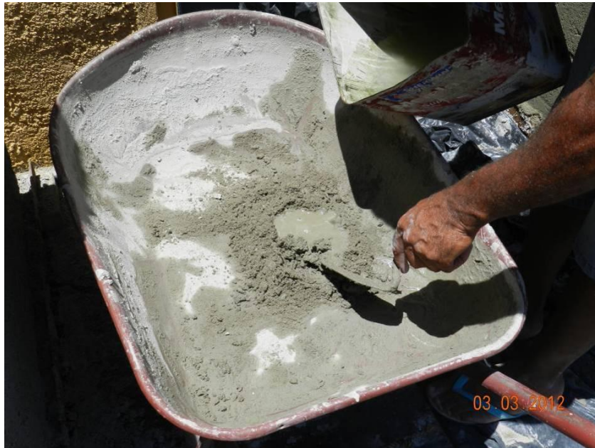
Figura 71 - Necessidade de acréscimo de água na argamassa.
