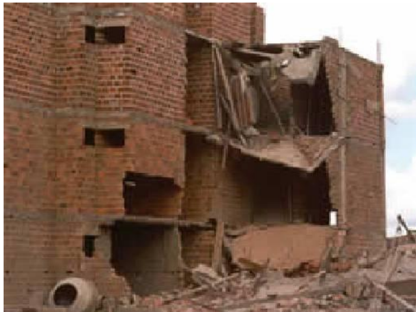
Figura 51 - Ruína de edificação devido ao uso de bloco cerâmico de vedação com função estrutural: Revista Técnica 19
