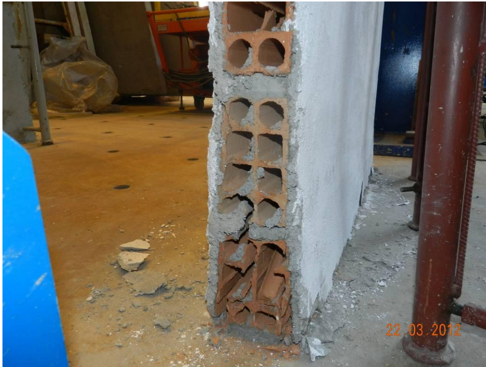
Figura 90 - Rompimento dos septos dos blocos com distanciamento dos rebocos entre si. Parede PAR-2.
