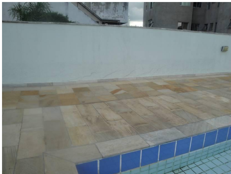
Figura 24 - Trinca em forma de escama no muro, resultante de dilatação térmica da laje
