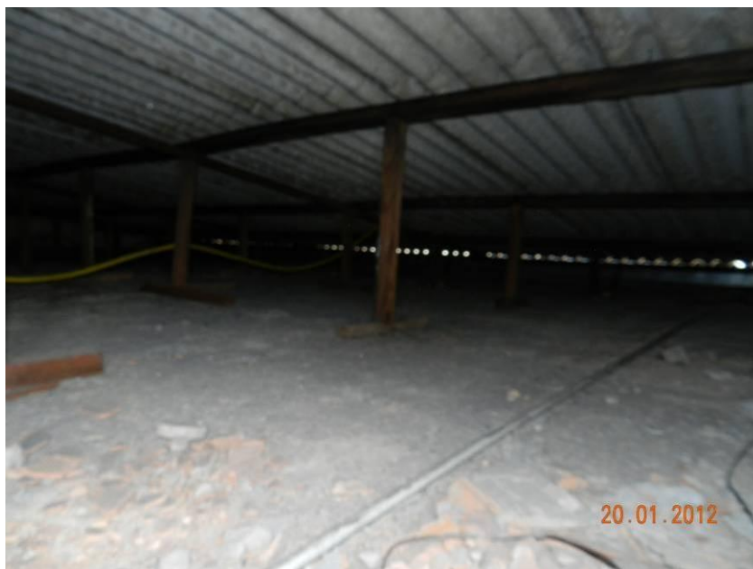
Figura 22 - Telhado de amianto impondo à laje grande variação térmica
