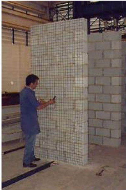
Figura 56 - Utilização de tela com o objetivo de reforçar o reboco da parede. Extraído de OLIVEIRA (2001). 21
