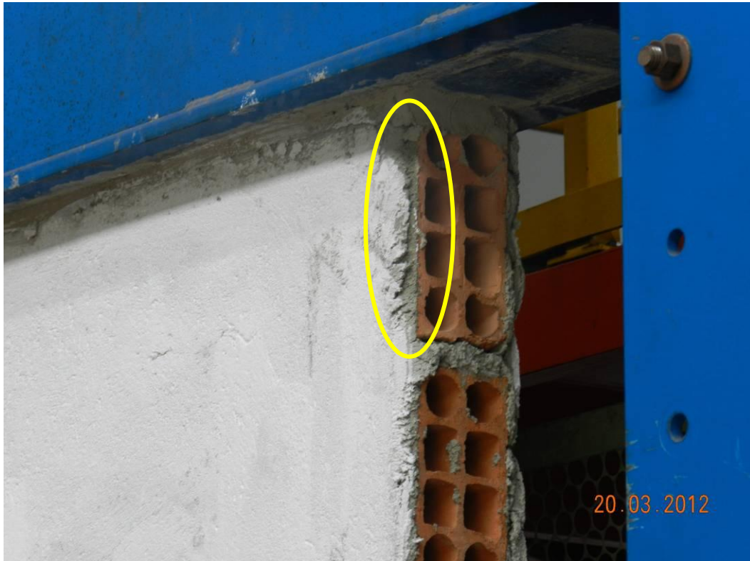
Figura 88 - Deslocamento de parte do reboco da parede PAR-2.
