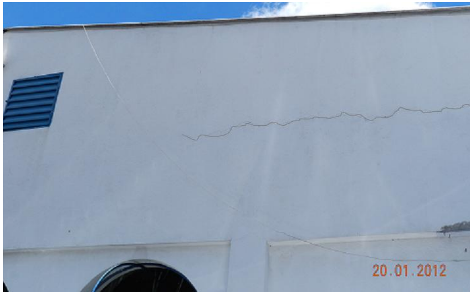
Figura 47 - Trinca (realçada digitalmente) indicando retração de laje, que foi executada posteriormente - Acervo próprio.
