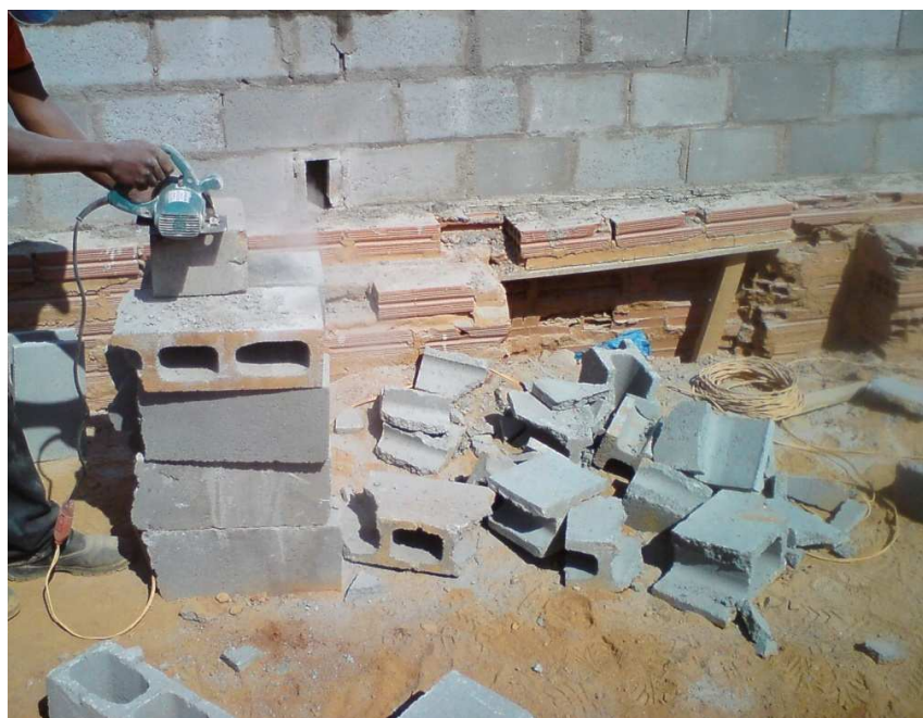
Figura 4.8: Corte de um bloco inteiro para a obtenção de um bloco compensador. Desperdício de mão de obra e geração de resíduo. Fonte: Autor.
