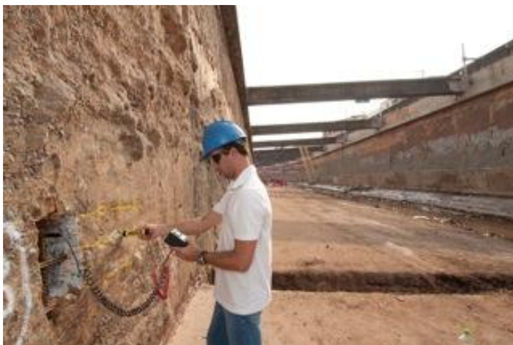
Figura 20 – Ensaio de potencial de corrosão realizado nas paredes do canal do Ribeirão Arrudas.
