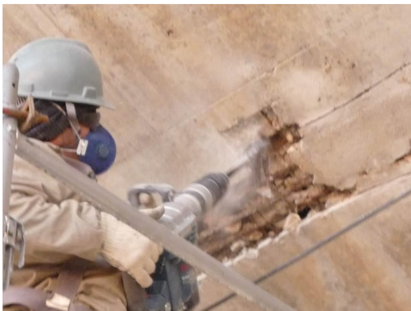
Figura 26 – Apicoamento mecânico de concreto em área que apresentava segregação e corrosão, com a etapa de reparo em andamento.
