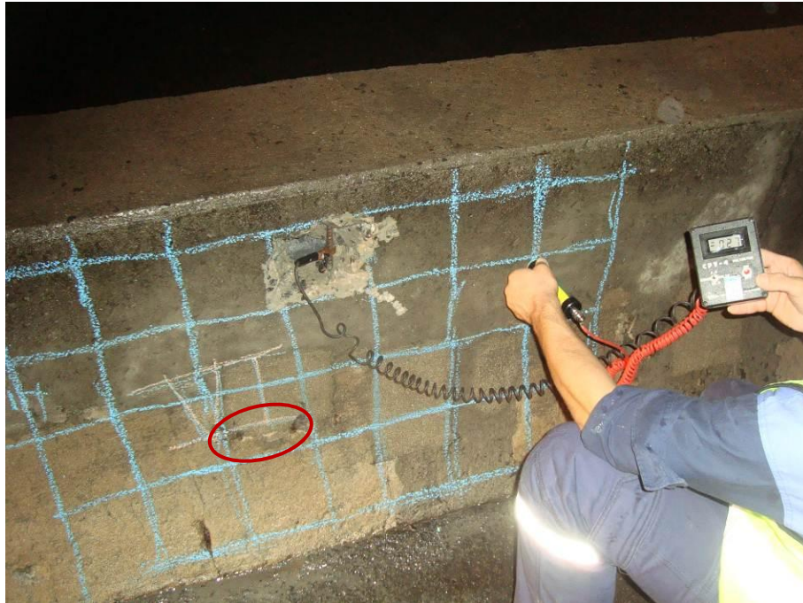
Figura 50 – Local escolhido para o ensaio VI próxima aos reparos existem pontos com armaduras expostas em processo de corrosão.
