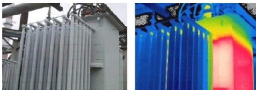
Figura 9: Baixo nível de óleo isolante, ocasionando sobreaquecimento. Fonte: [30]
