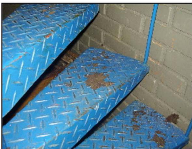
Figura 4- Escada de metal com ferrugem
