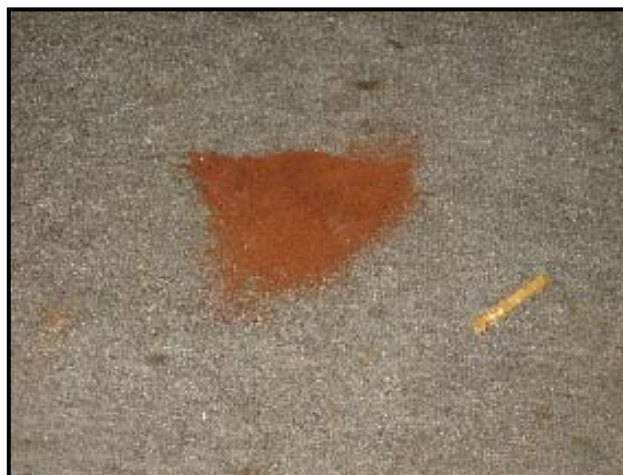
Figura 19- Ferrugem das latas em contato com o carpete (piso do acervo)
