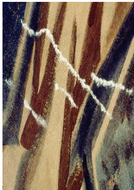
Fig. 21 – Atividades de Minas Gerais Detalhe: nivelamento de rachaduras Fonte: Acervo CECOR – Crédito: Cláudio Nadalin
