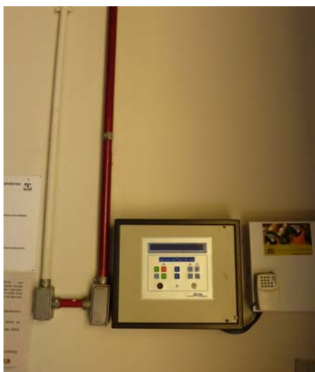
Figura 64 – Sistema de detecção de incêndio Foto: Kleumanery Melo
