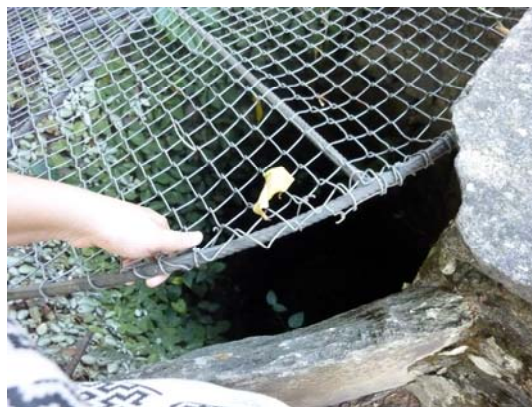
Figura 59 – Detalhe da grade de proteção do poço
