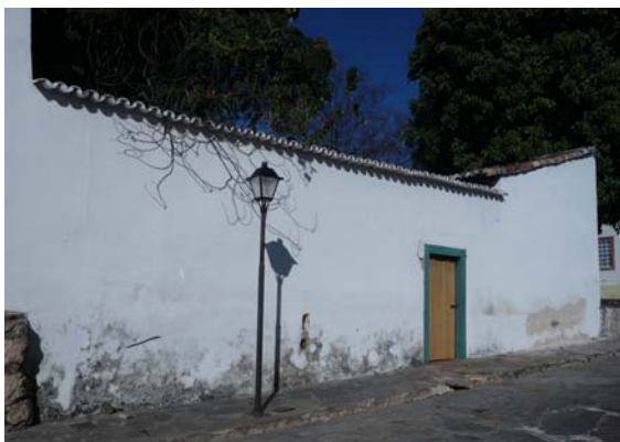
Figura 46 – Manchas de umidade na parte externa do muro
