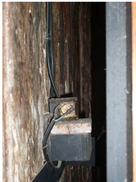
Figura 68 – Transformador da luminária ajustável. Foto: Kleumanery Melo
