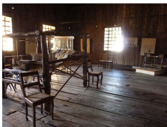
Figura 48 – Detalhe do assoalho da enxovia 2 com tábuas irregulares e soltas
