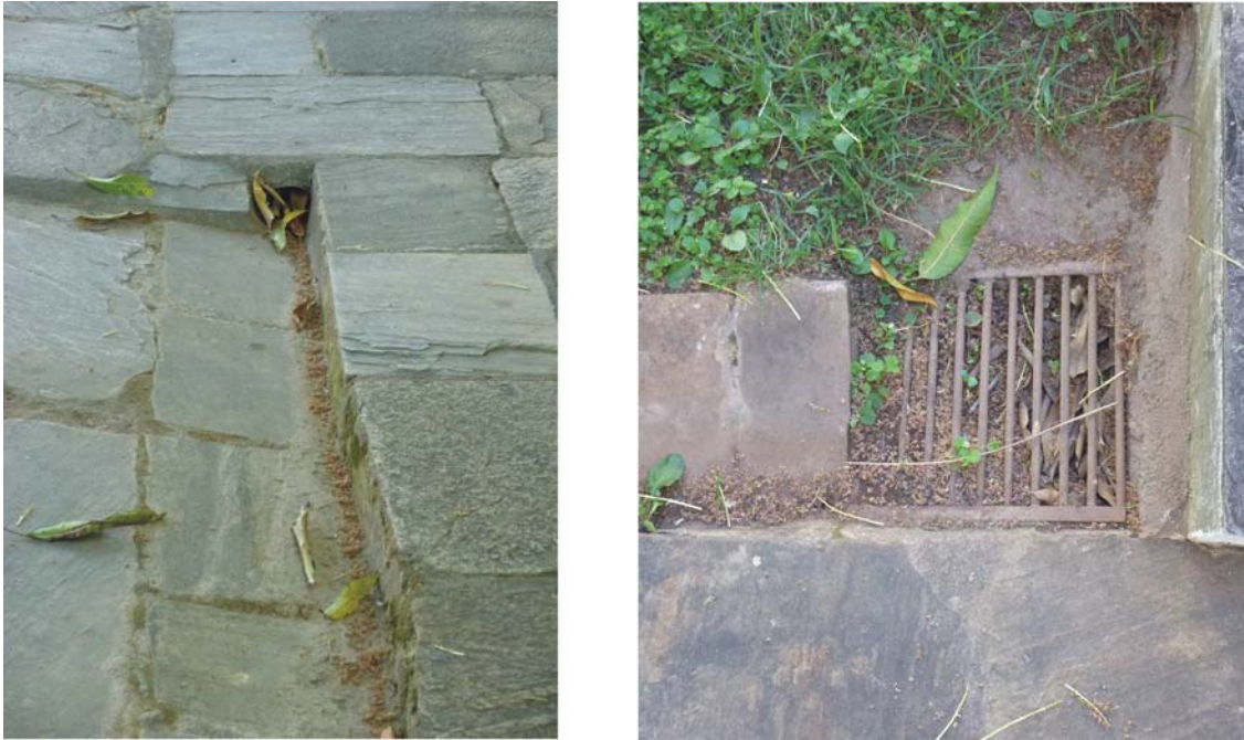
Figura 61 – Entupimento das canaletas e coletores de águas
