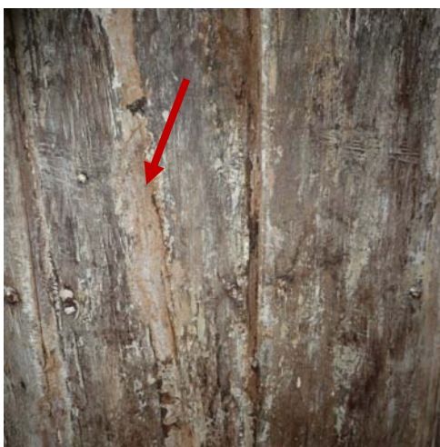
Figura 44 – Detalhe de madeira com complementação em cimento Foto: Kleumanery Melo
