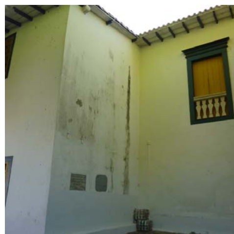
Figura 47 – Manchas de umidade na fachada lateral provocada pela ausência de calhas
