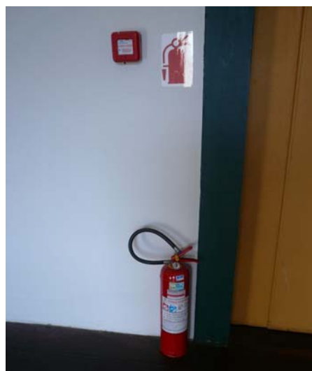
Figura 65 – Equipamentos de detecção e combate a incêndio Foto: Kleumanery Melo
