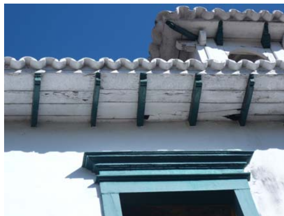
Figura 50 – Detalhe do beiral da edificação com perdas provocadas pelo apodrecimento da madeira e ataque de xilófagos.
