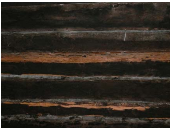
Figura 49 – Detalhe do forro do pavimento térreo com manchas de umidade e sinais de apodrecimento na madeira.
