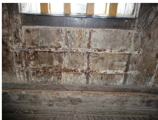
Figura 45 – Detalhe de reforços metálicos apresentando oxidações Foto: Kleumanery Melo
