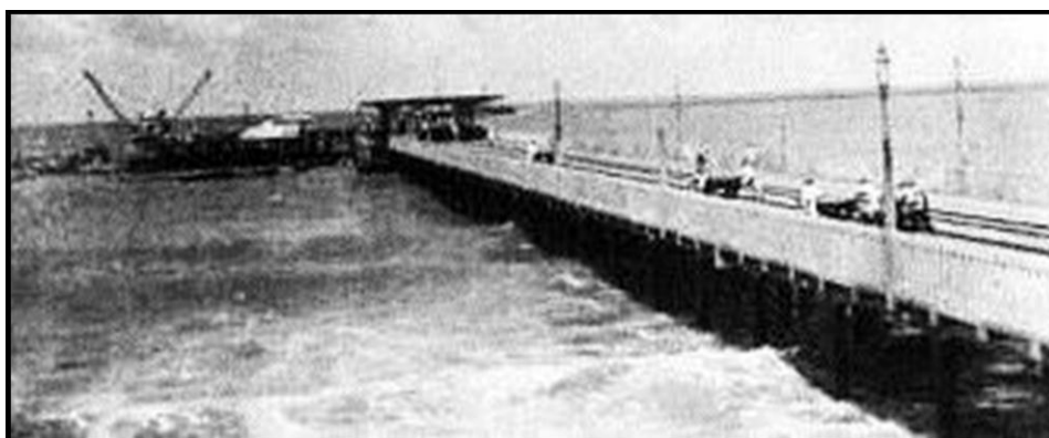
FIGURA 63. Ponte dos Ingleses em construção - 1923. (Foto reprodução, com tratamento digital da imagem).
