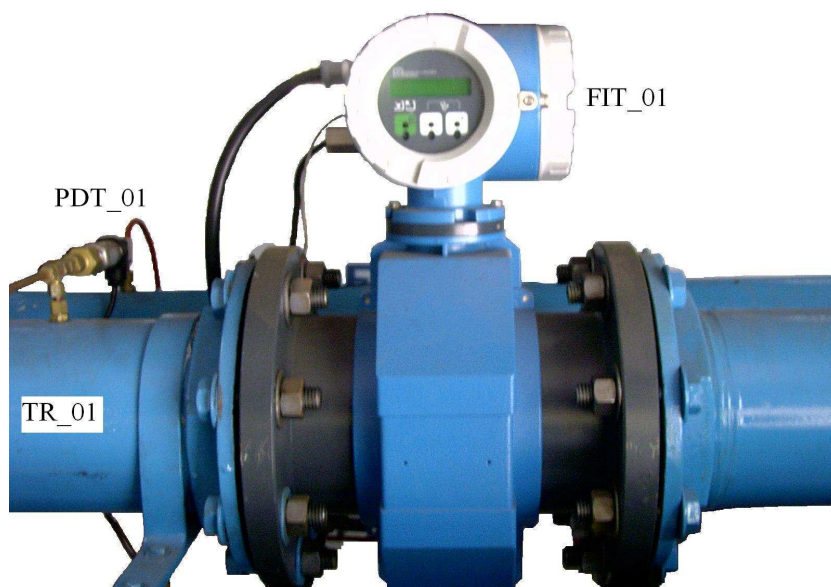
Figura 3.11: Medidor de vazão, sensor eletromagnético, instalado na tubulação de saída principal do sistema de bombeamento
