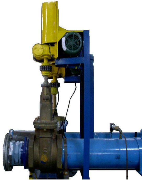
Figura 3.3: Válvula-gaveta motorizada da saída principal do sistema de bombeamento.
