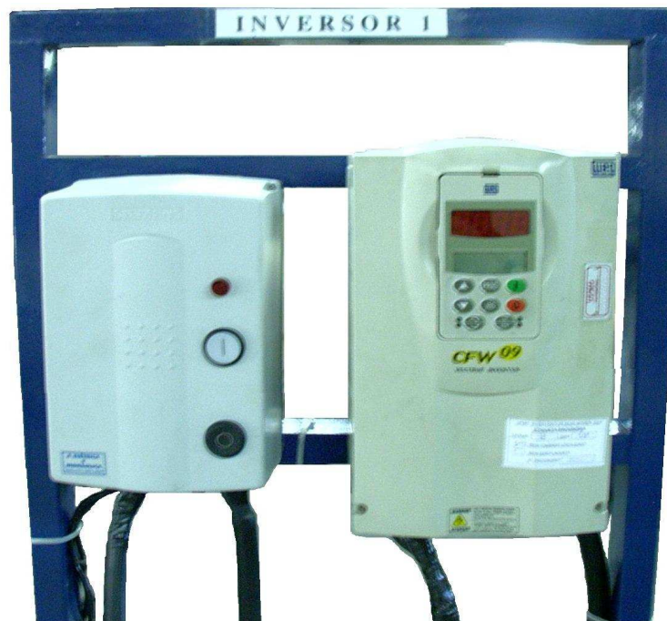
Figura 3.5: Inversor de frequência utilizado no controle de velocidade de cada um dos motores de indução trifásicos.
