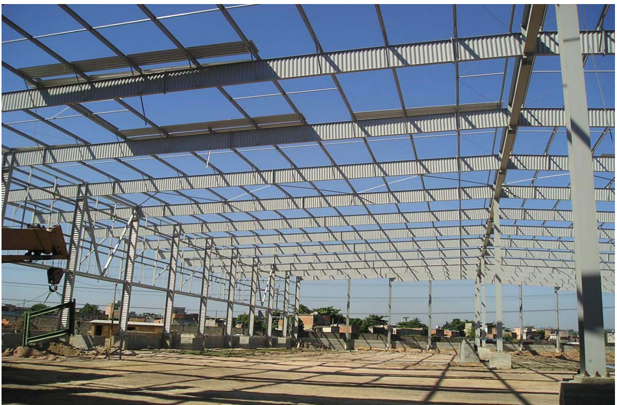
Figura 1.3 – Galpão construído com peças de alma corrugada senoidal – Codeme Engenharia S.A.
