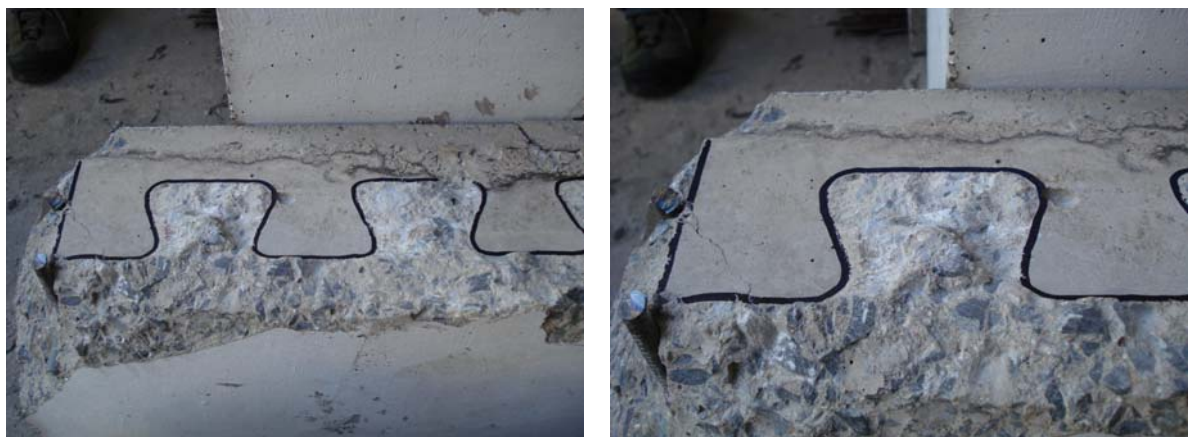
FIGURA 4.10 – Detalhe dos pinos de concreto cortados junto às bordas dos furos do conector.
