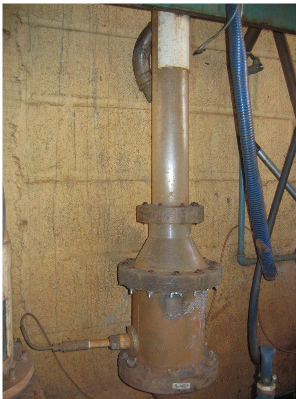
Figura 4.6 – detalhe do fundo da coluna com seu sistema de aeração.
