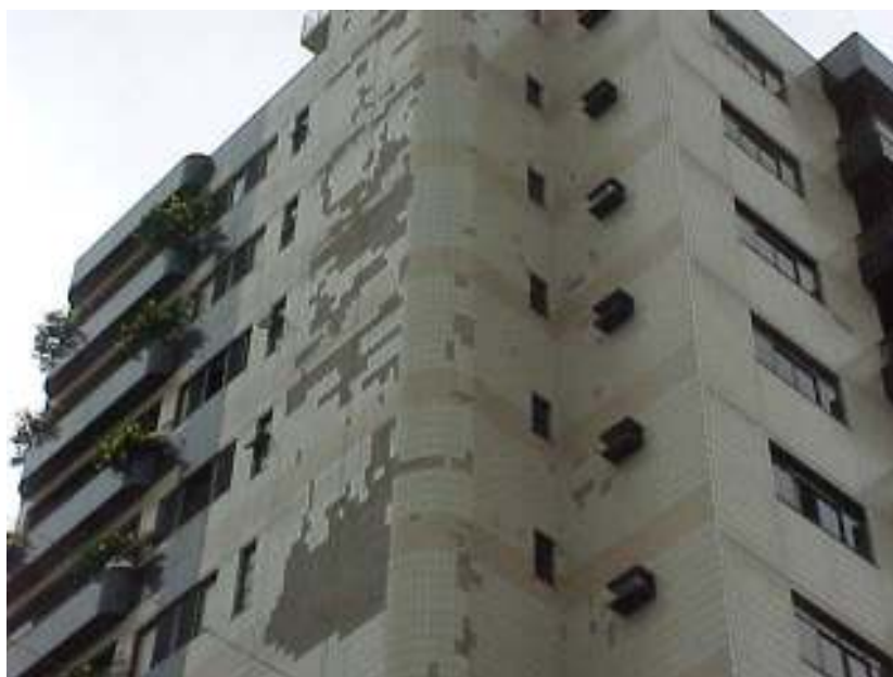
Figura 1.2 – Destacamento de placas cerâmicas em fachada de edifício (Arquivo Consultare – Pedrosa e Nascimento Engenharia e Consultoria Ltda.).
