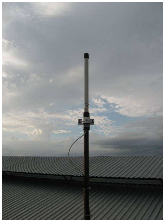
Figura 3.17. Antena omnidirecional instalada
