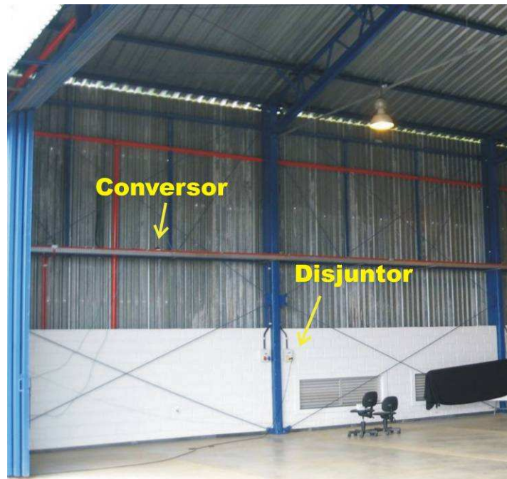
Figura 3.27. Local de instalação dos equipamentos
