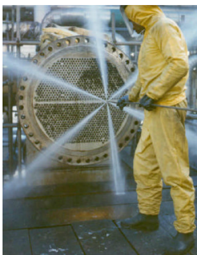
Figura 4.2 – Operador executando limpeza de feixe tubular por hidrojateamento.
