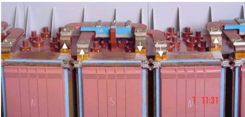
Fig. 1.8 – Usina de Tucuruí: detalhe da conexão em série dos pólos.
