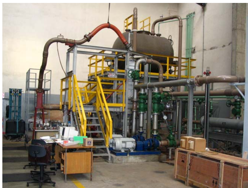
Figura 3.2 – Foto do Circuito Hidrodinâmico do Reator (CHR).
