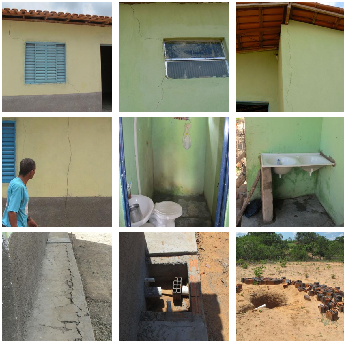
Fig. 43: Problemas estruturais e de acabamento das novas casas da Catinguinha . Fonte: arquivo pessoal
