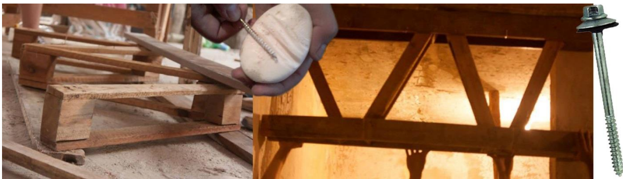
Figura 69 Vigas de madeira feitas com pallets . Para facilitar o aparafusamento entre as peças foi utilizado sabão. Por fim as vigas foram fixadas nos pilares utilizando parafusos de fixar telha. Fonte: elaborada pelo autor.
