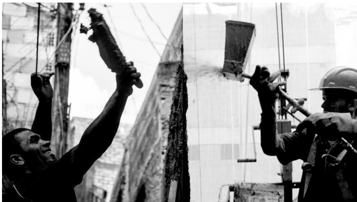
Figura 56 À esquerda o pedreiro autônomo que participou de um dos mutirões. À direita um projetor de massa em operação 51 . Fonte: Imagem à esquerda: Horacius de Jesus, Imagem à direita: www.Anvi.com.br , fabricante de projetores de massa.
