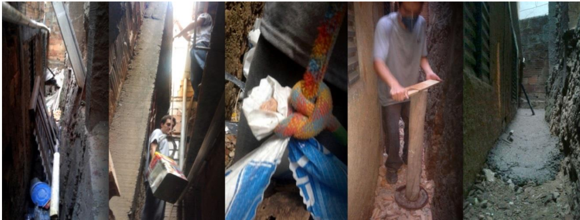
Figura 66 Processo de limpeza, deposição de entulho, sua compactação e concretagem no vão existente entre a obra e casa vizinha. Fonte: elaborada pelo autor.
