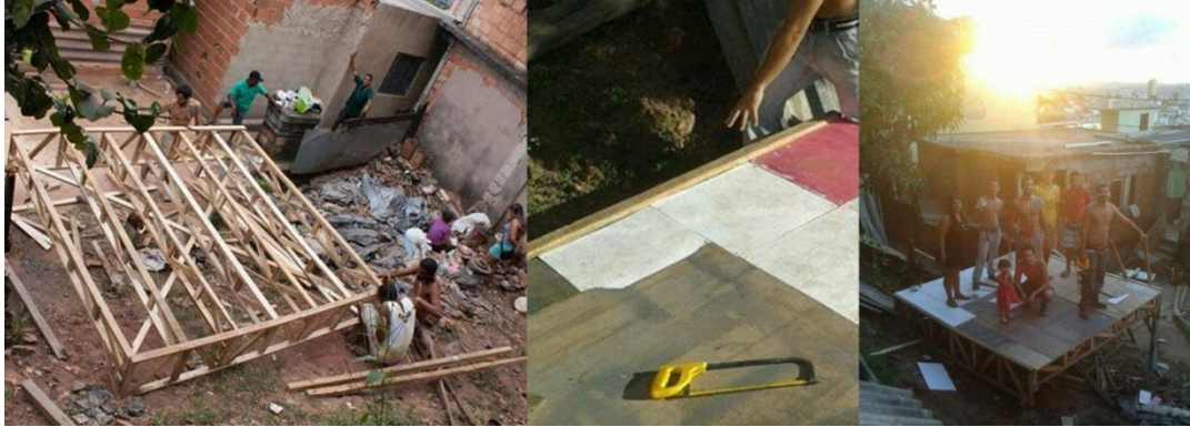
Figura 92 Fixando a estrutura treçada nos postes de fundação e o piso nas vigas. A rigidez da estrutura após a fixação do piso aumentou surpreendentemente. Fonte: elaborada pelo autor.
