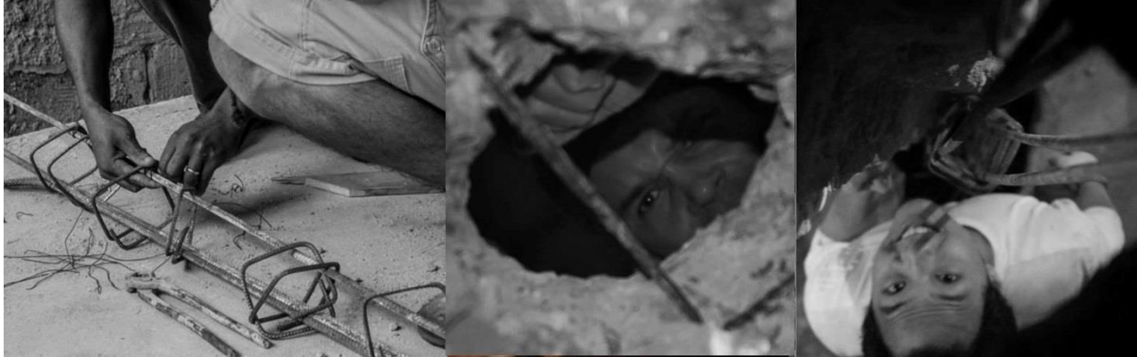
Figura 67 Amarração de estribos dobrados na obra, abertura de buraco na laje e posicionamento da armadura. Fonte: elaborada pelo autor.
