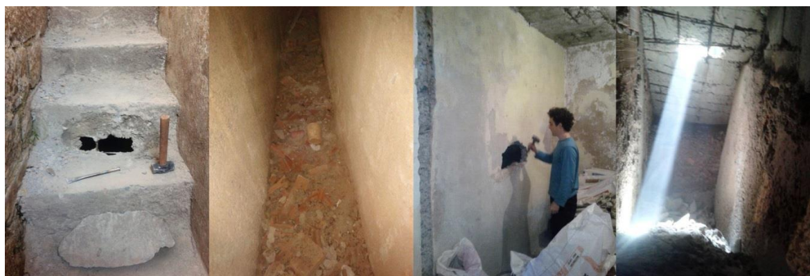
Figura 61 A descoberta do espaço vazio, entre a parede da sala e o muro de arrimo, quando se estava tentando regularizar a dimensão dos degraus da escada. Fonte: elaborada pelo autor.
