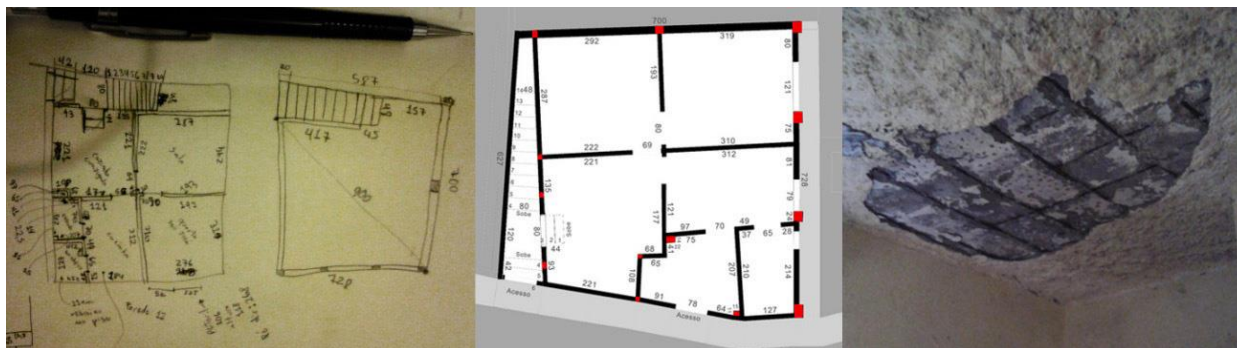
Figura 50 À esquerda levantamento de medidas da casa. Ao centro a planta com a localização dos pilares em vermelho 49 . À direita o processo de corrosão que vinha acontecendo na armadura da laje. Fonte: elaborada pelo autor.
