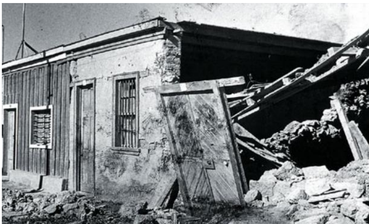
Figura 8. Edificações afetadas pelo terremoto chileno de 1971
