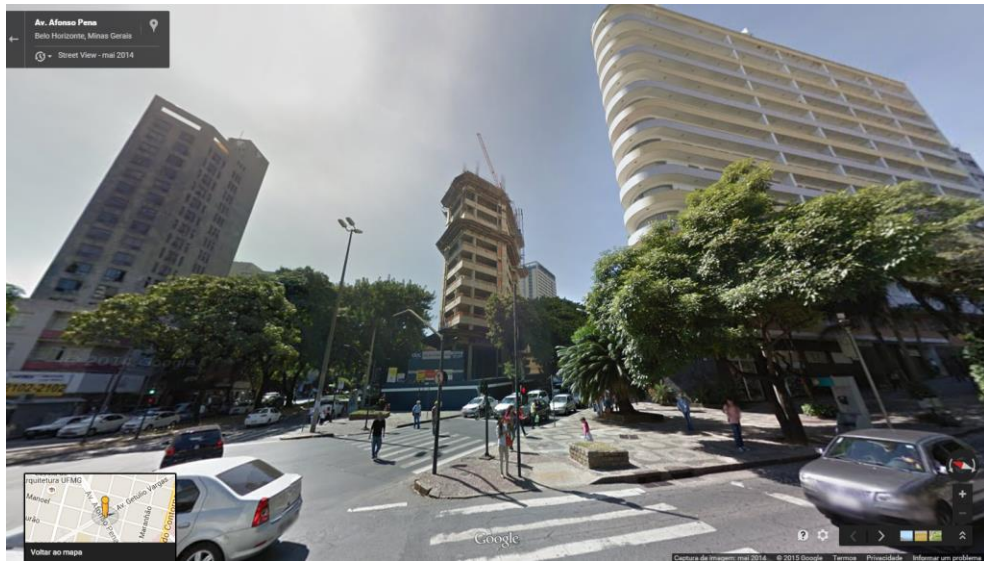
Imagem de Levantamento 10. Edifício de andares múltiplos, executada em 2014, em estrutura de concreto moldada no local e alvenarias de bloco cerâmico para vedação. Implantado à Av. Afonso Pena.
