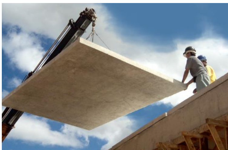
Figura 36. Estrutura de piso pré-fabricado
