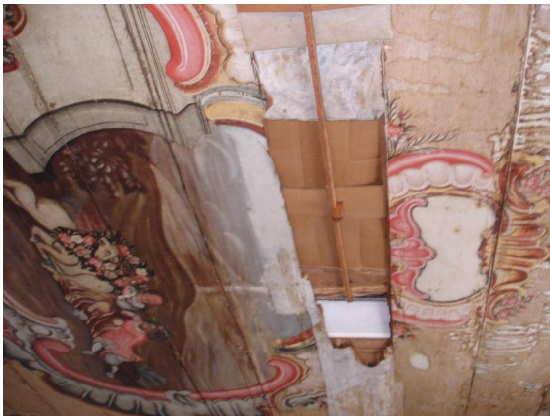
FIGURA 139 — Forro pintado do cômodo térreo do torreão da Casa Padre Toledo, com perdas em consequência de desabamento de tábuas. Fotografia do autor, 2009.
