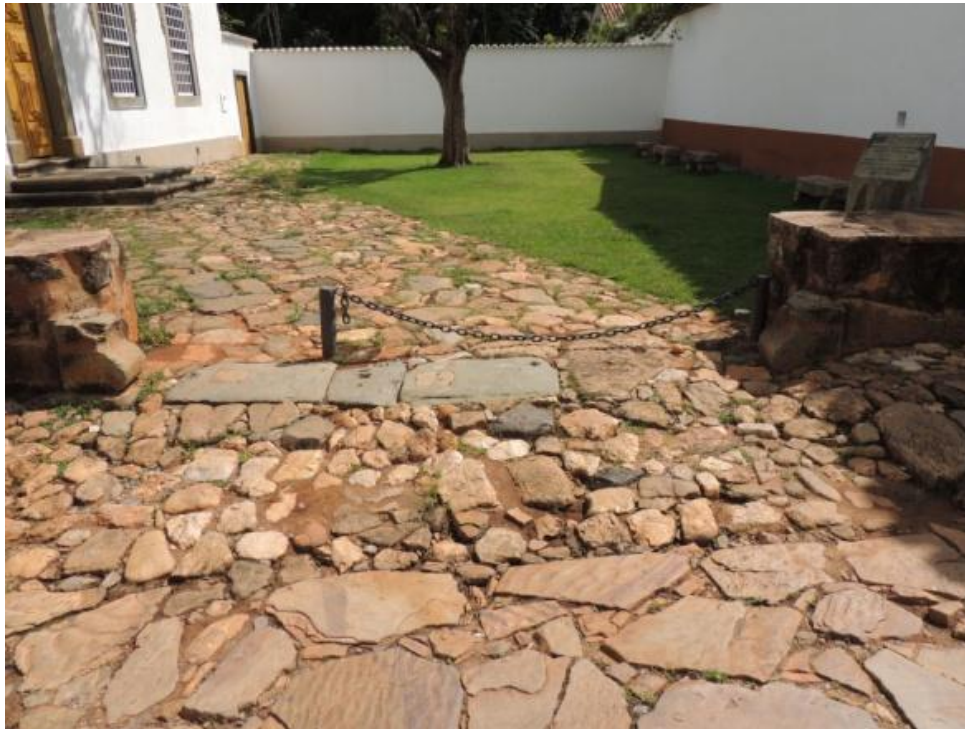
FIGURA 123 — A soleira original da entrada da Casa Padre Toledo, depois de aberta para a entrada dos veículos dos padres e do bispo, ainda mantendo os blocos de xisto e os socos. Fotografia do autor, 2014.
