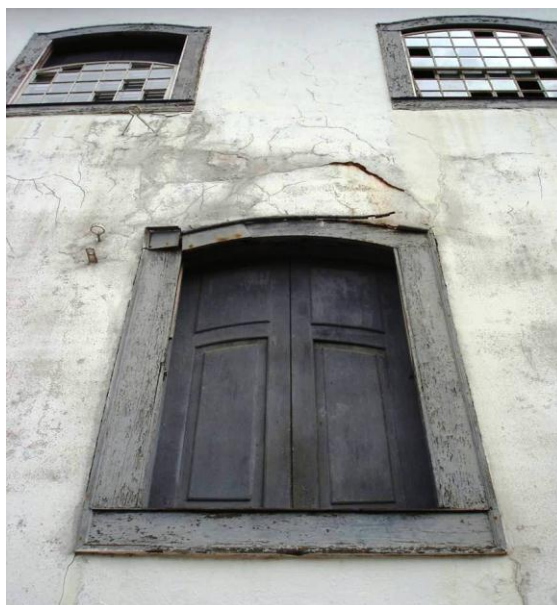
FIGURA 141 — Fachada do torreão, com o revestimento / reboco bastante comprometido e correndo risco de desabar. Fotografia do autor, 2009.
