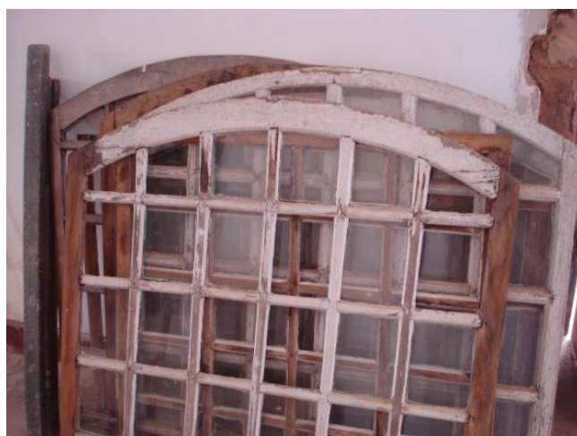
FIGURA 148 — As guilhotinas ficaram em estado de conservação bastante comprometedor. Fotografia do autor, 2011.
