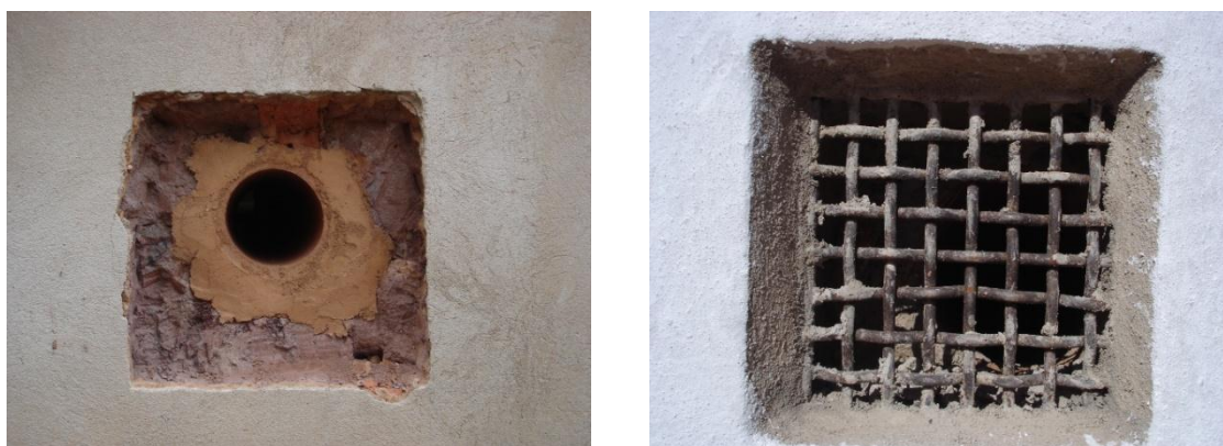
FIGURAS 192 e 193 — Os respiradouros do porão foram reabertos e embrechados. Foram colocadas grades de proteção. Fotografia do autor, 2012.
