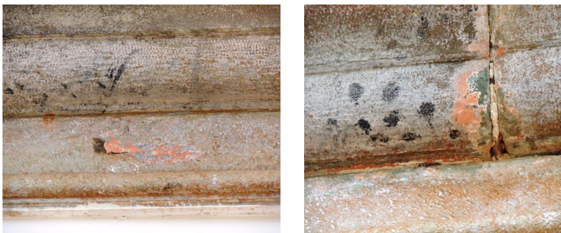
FIGURAS 64, 65 e 66 — Detalhes da cimalha da Casa Padre Toledo, com vestígios de cor sobre a pedra xisto. Fotografia do autor, 2012.
