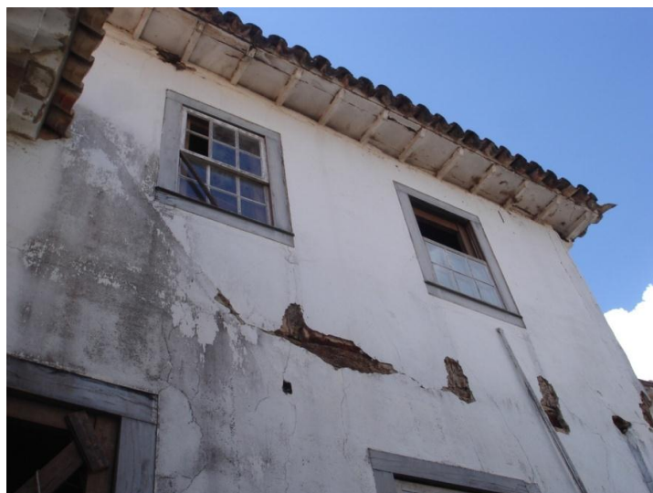
FIGURA 154 — Fachada posterior do torreão, com vários problemas. Fotografia do autor: 2011.
