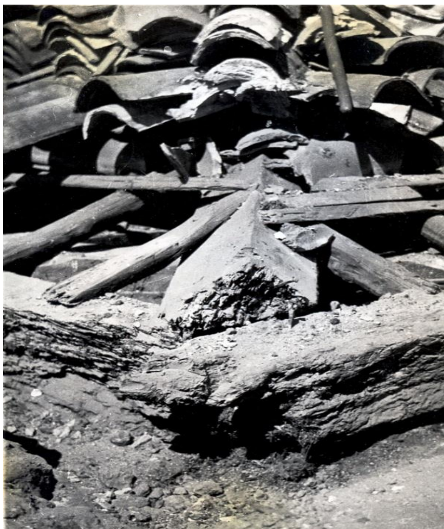
FIGURA 102 — As peças estruturais do telhado do “Edifício da Prefeitura”, a Casa Padre Toledo ficaram bastante comprometidas pelo ataque de insetos xilófagos e pelas águas pluviais. Fotografia de 1944. Fonte ACIPHAN/RJ.
