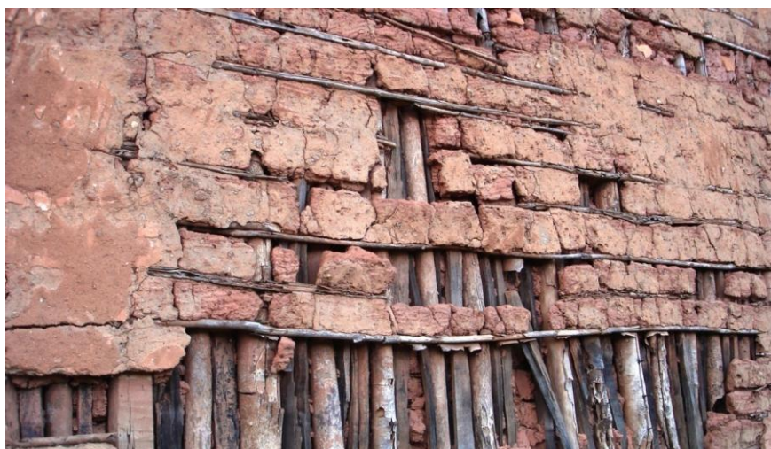
FIGURA 6 — Parede de pau a pique sem a proteção do reboco e em estado de degradação, Serro/MG. Fotografia do autor, 2010.
