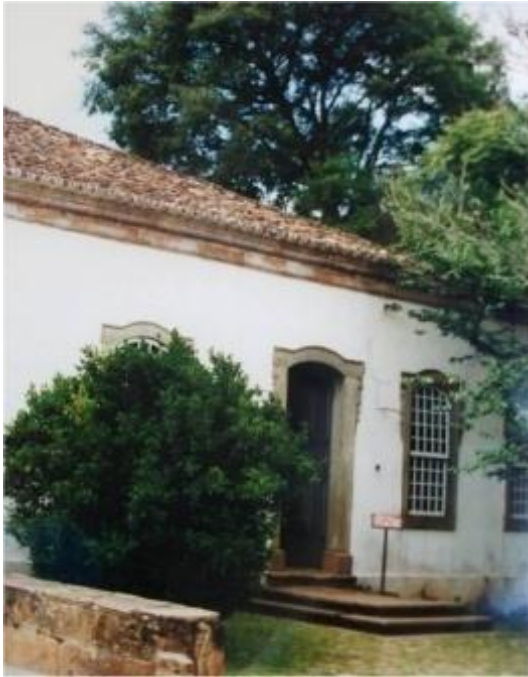
FIGURA 132 — Fachada lateral da Casa Padre Toledo, com a paineira ao fundo, árvore que causou danos aos elementos artísticos dos forros. Fotografia do autor, 1997.
