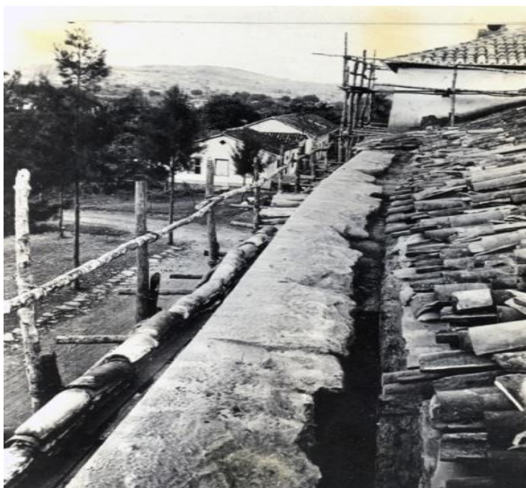
FIGURA 100 — A parede da fachada frontal, encimada pela cimalha em pedra xisto, que mesmo depois da intervenção, continuou ligeiramente abaulada, década de 1944. Fonte ACIPHAN/RJ.
