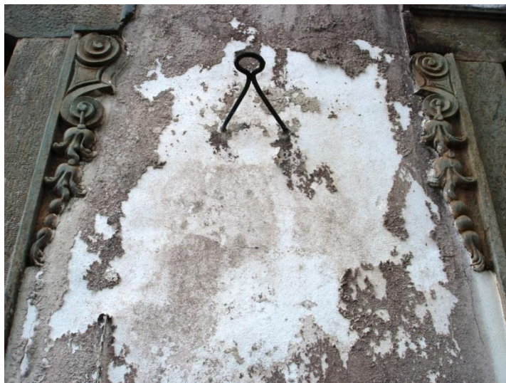
FIGURA 140 — Detalhes da fachada lateral da Casa Padre Toledo, com a pintura bastante comprometida por sujidade e água pluvial. Fotografia do autor, 2009.
