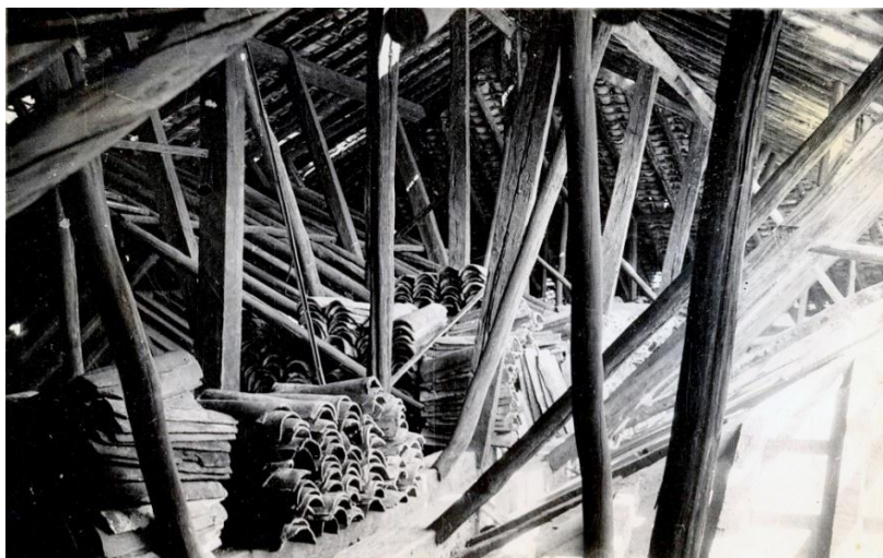
FIGURA103 — As peças roliças compoem a estrutura do telhado do “Edifício da Prefeitura”, a Casa Padre Toledo. Fotografia de1944. Fonte ACIPHA /RJ.
