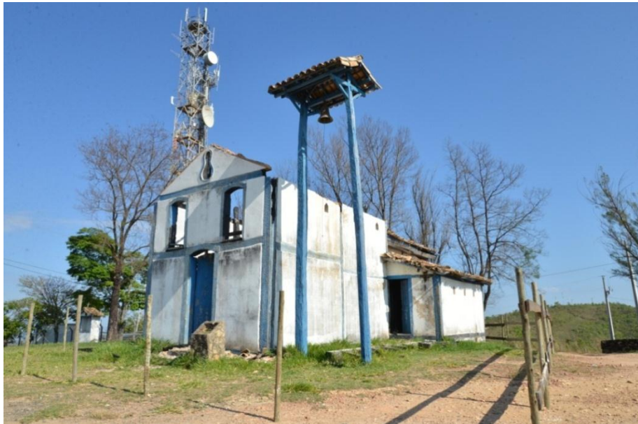
Figura 16 - Capela do Morro do Bonfim (após incêndio criminoso em 2014)
