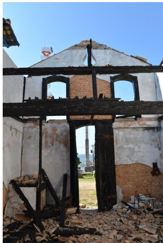
Figura 17 - Capela do Morro do Bonfim (após incêndio criminoso em 2014)
