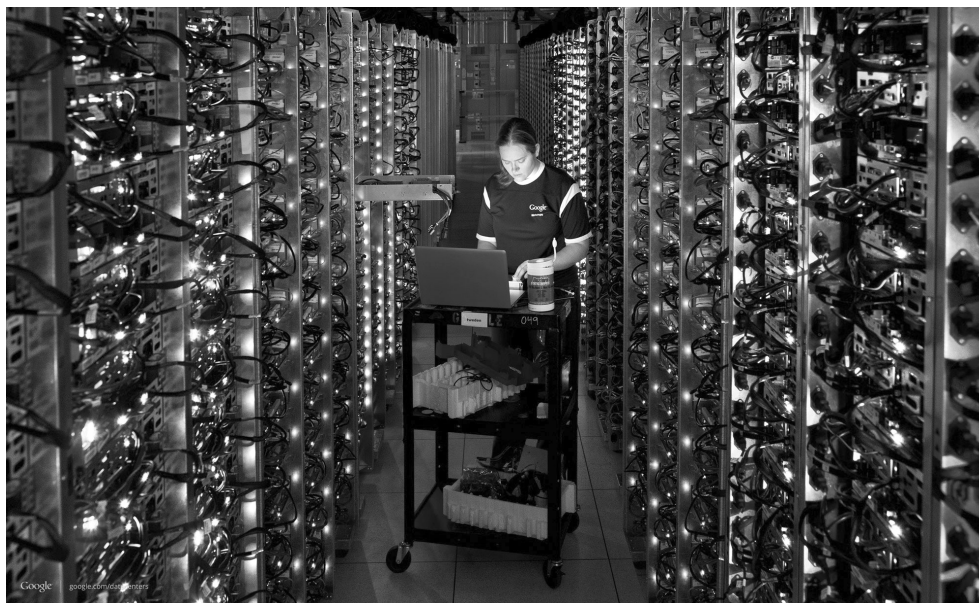
Imagem 03: Funcionária faz a manutenção de servidores em um Data Center da empresa Google em Oregon, EUA. Fonte: Connie Zhou.
