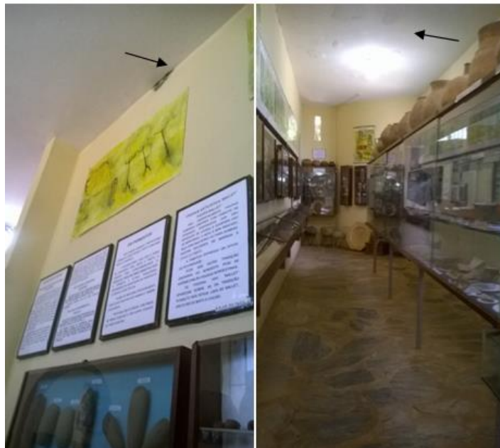
Figura 76 - Sinais de infiltração e mofos provenientes da cobertura
