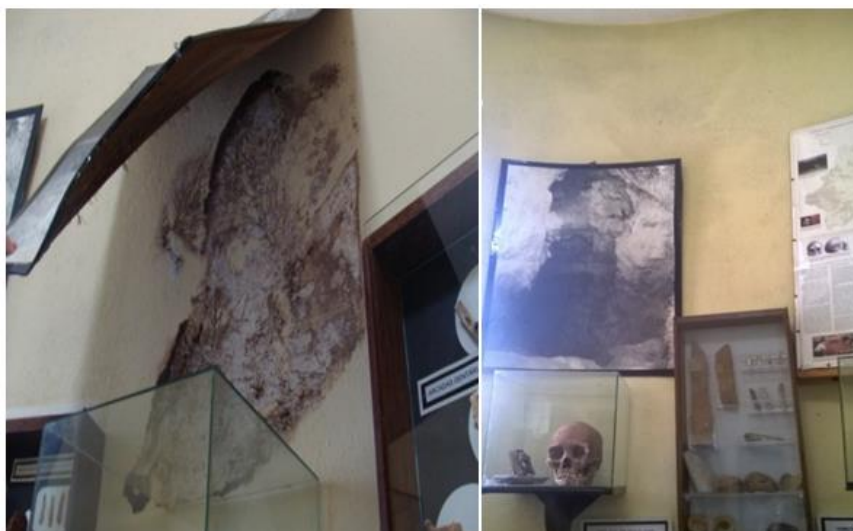
Figura 74 - Deterioração por umidades: manchas e sinais de fungos.
