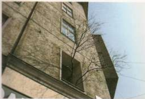
Tree tenants, Alserbachstrasse, Vienna, 1980.
