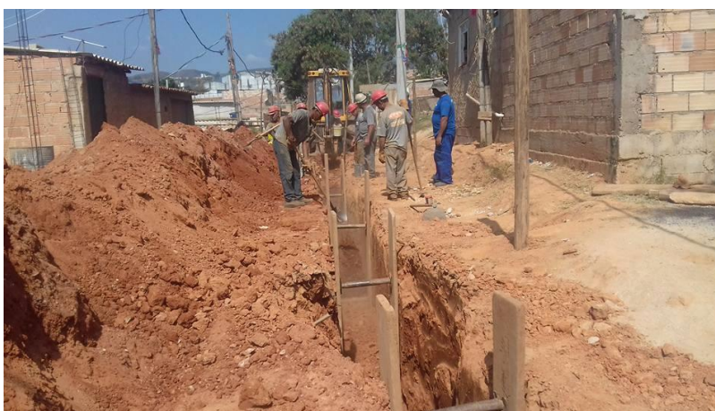
Figura 32 - Início das obras para implantação do sistema de esgotamento sanitário da Copasa na parte de cima da ocupação Eliana Silva em 17 de agosto de 2016
