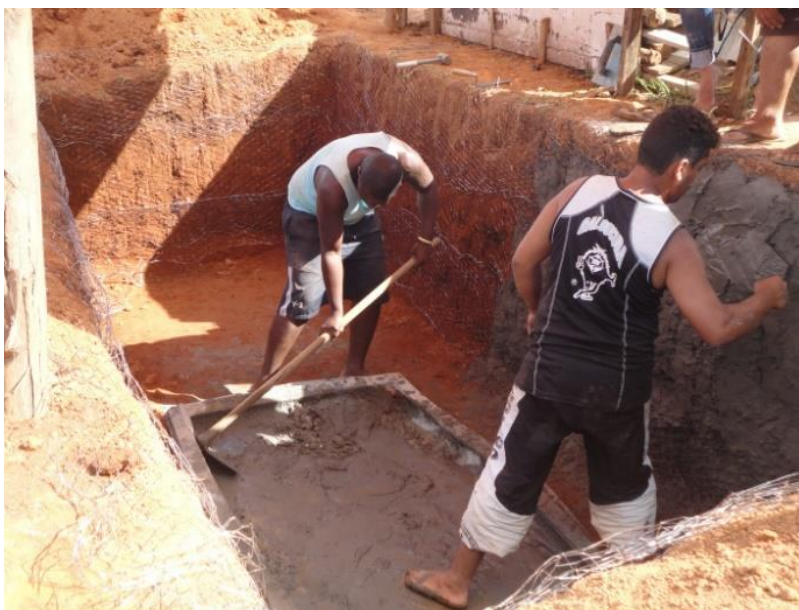
Figura 30 - Aplicação de argamassa no primeiro tevap da ocupação Eliana Silva em 05 de dezembro de 2012
