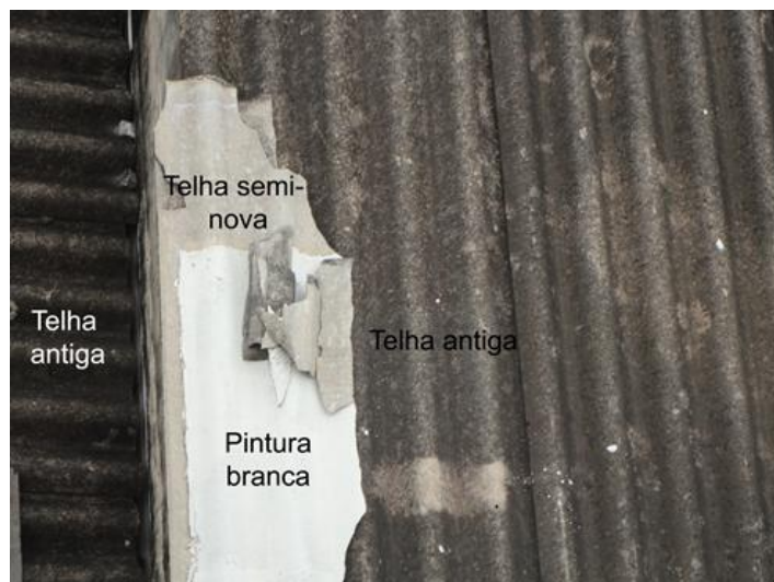
Figura 25- Escurecimento da telha de fibrocimento
