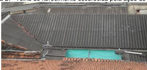
Figura 27- Telha de fibrocimento escurecida pela ação do tempo
