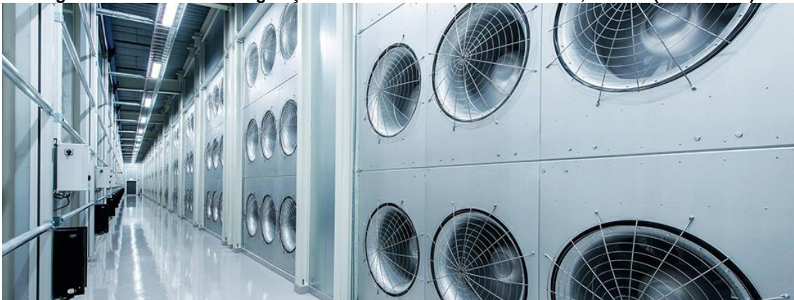
Figura 12 - Sistema de refrigeração utilizando o ar externo em Lulea, Suécia. (Fonte: DPR)
