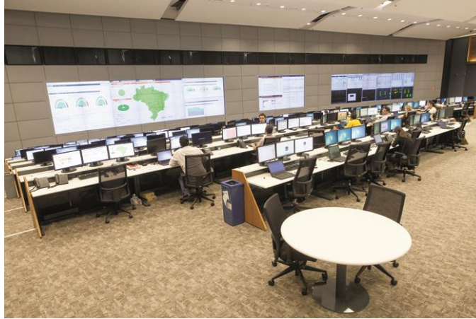
Figura 20 - Sala de controle do Data Center CTMM (Fonte: O popular Mogi Mirim)
