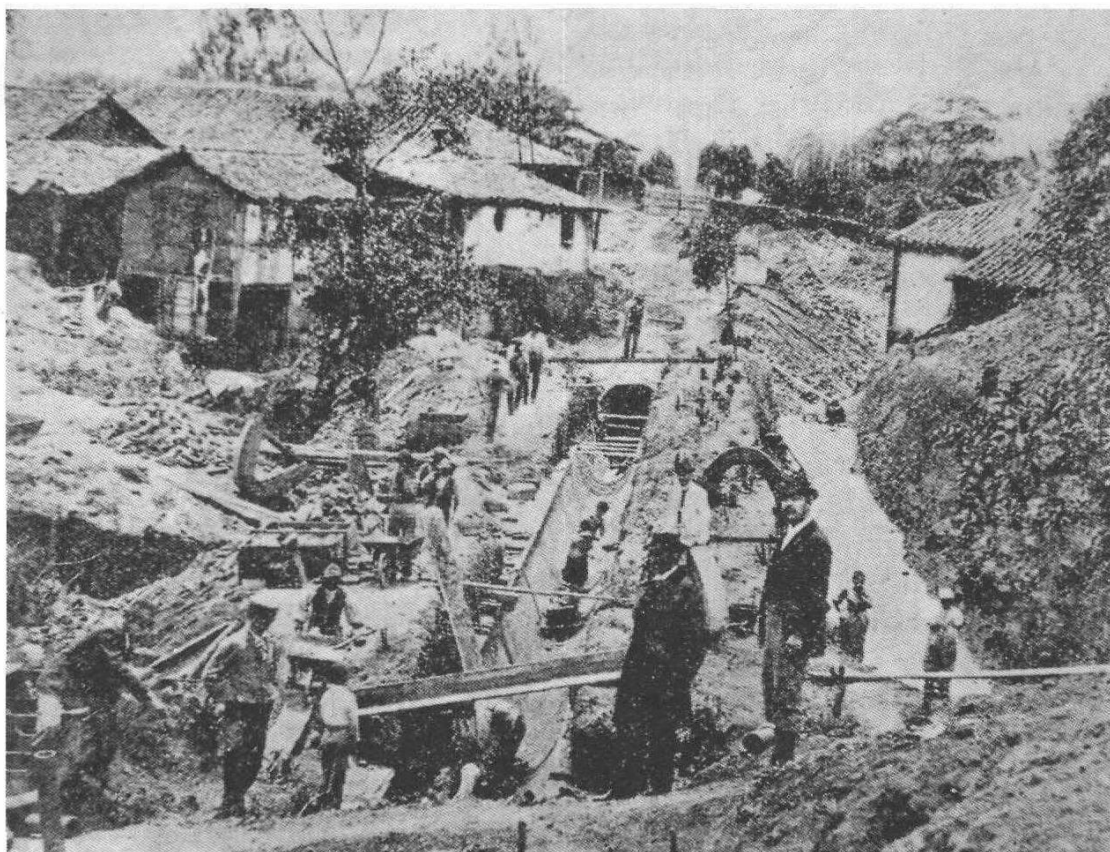
Trabalhos de construção das galerias de esgotos no Parque, vendo-se ali perto a velha fazenda em que morava o Sr. Paul Villon.
