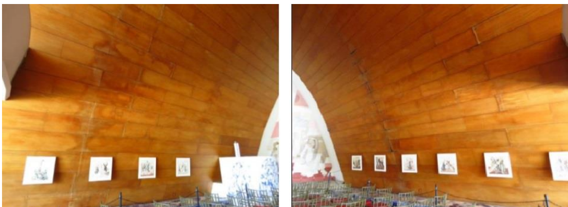
Figura 115 - Vista da lateral esquerda – lado do Evangelho. Danos mais agressivos no alinhamento da segunda junta de dilatação. Figura 116 - Vista da lateral direita – lado da Epístola. Danos mais agressivos no alinhamento da primeira junta de dilatação. Fonte: Memorial da Arquidiocese de Belo Horizonte.
