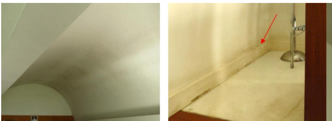
Figura 128 - Manchas de mofo na cobertura da loja. Figura 129 – Umidade ascendente na parede da loja (indicado em vermelho). Fonte: Memorial da Arquidiocese de Belo Horizonte.
