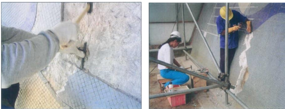
Figura 70 – Retira das pastilhas azuis claro acima do mosaico. Figura 71 - Remoção das pastilhas do mosaico sobre as juntas de dilatação. Fonte: AGUIAR; MORAES, 2005, p. 30 – 32.
