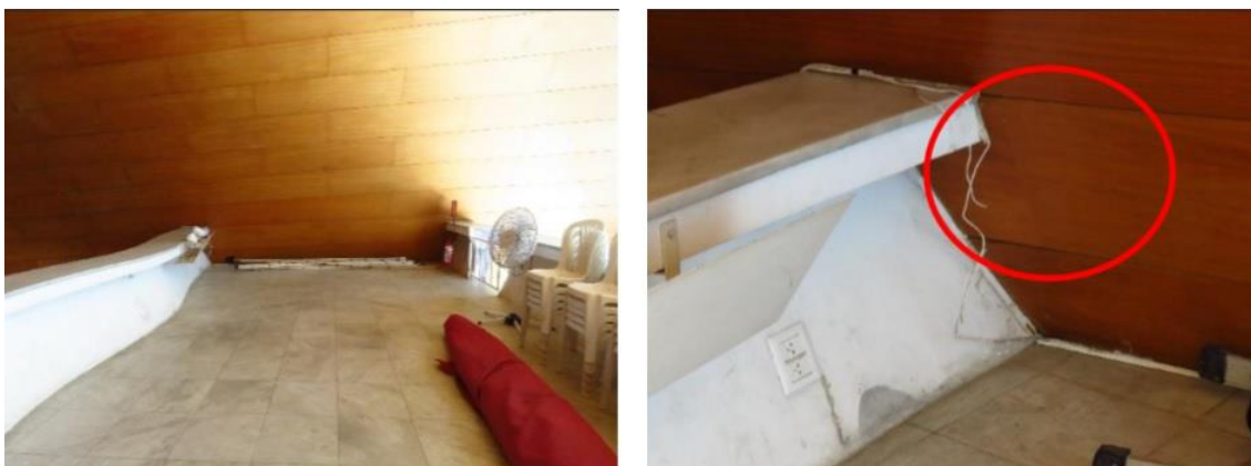
Figura 121 - Coro funcionando como local de depósito. Figura 122 – Danos no forro e fiações expostas no coro. Fonte: Memorial da Arquidiocese de Belo Horizonte.
