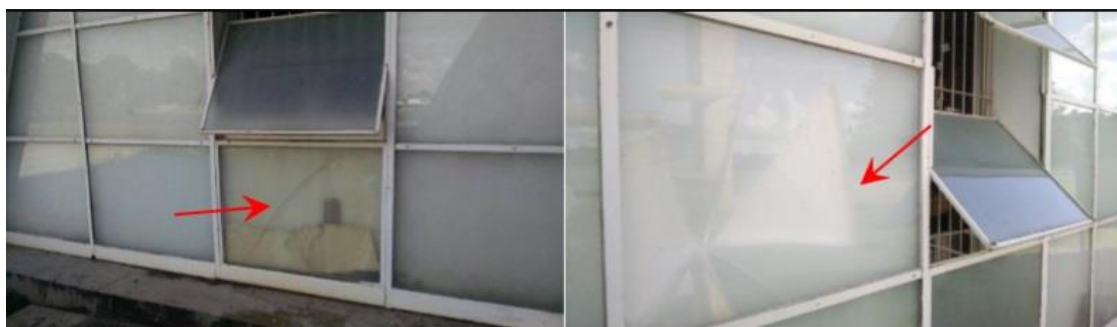
Figura 102 - Vidro quebrado na vedação da Capela do Santíssimo Sacramento. Figura 103 – Vidro quebrado na vedação da loja. Fonte: Memorial da Arquidiocese de Belo Horizonte.
