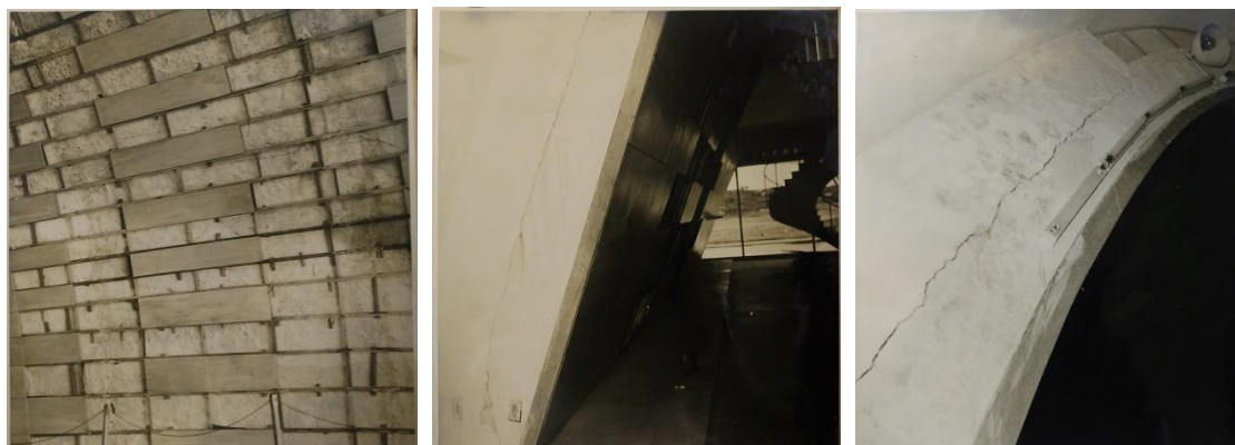
Figura 20 - Foto do relatório de obras de 1954, mostrando o concreto armado chapiscado. Figura 21 - Foto do relatório de obras de 1954, indicando a fenda entre a capela mor e a nave. . Figura 22 - Foto do relatório de obras de 1954, indicando a fenda entre a capela mor e a nave. Fonte: Arquivo Central do IPHAN/RJ.
