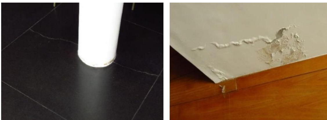
Figura 117 - Fissura no piso do átrio (0,4 mm). Figura 118 - Infiltração na laje átrio. Fonte: Memorial da Arquidiocese de Belo Horizonte.
