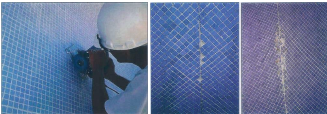
Figura 84 – Corte das pastilhas com Makita para abertura das juntas de dilatação. Figura 85 e 86 – Desprendimentos de pastilhas após o corte. Fonte: AGUIAR; MORAES, 2005, p. 60 – 61.
