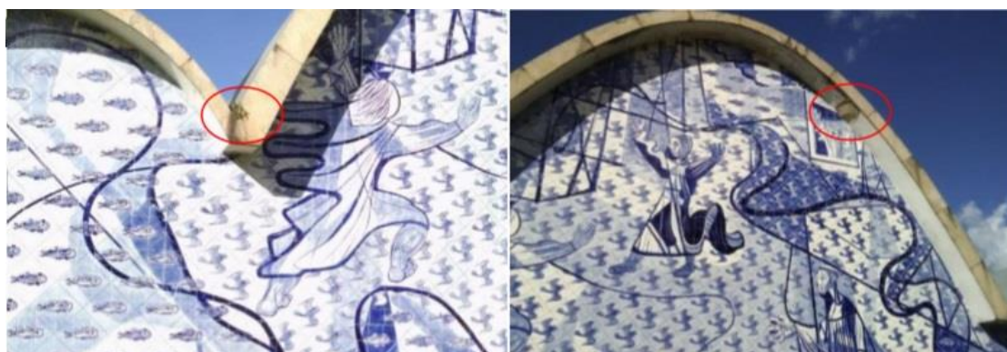
Figura 100 - Fachada posterior – vegetação invasiva no encontro das coberturas. Figura 101 - Fachada posterior –destacamento de reboco no beiral. Fonte: Memorial da Arquidiocese de Belo Horizonte.
