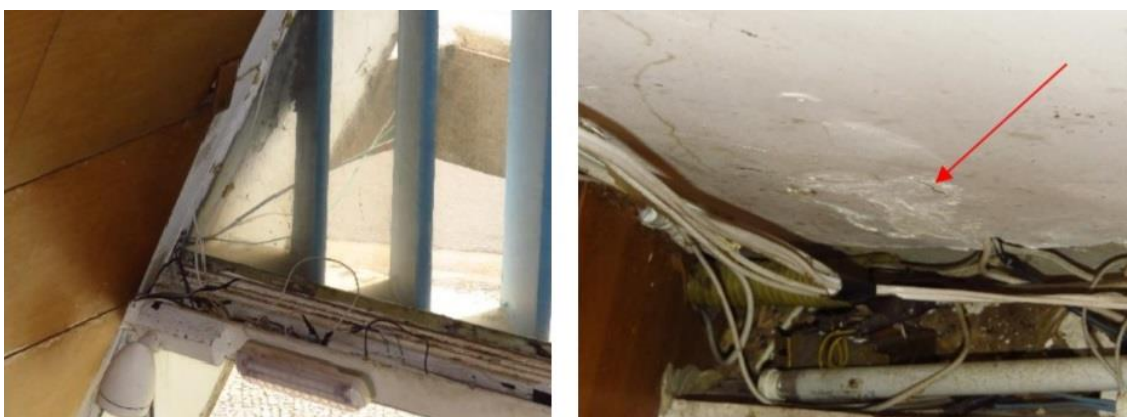
Figura 119 - Esquadrias da fachada frontal oxidadas com fiação exposta. Figura 120 - Problemas de infiltrações na sanca próximo a condutores embolados. Fonte: Memorial da Arquidiocese de Belo Horizonte.
