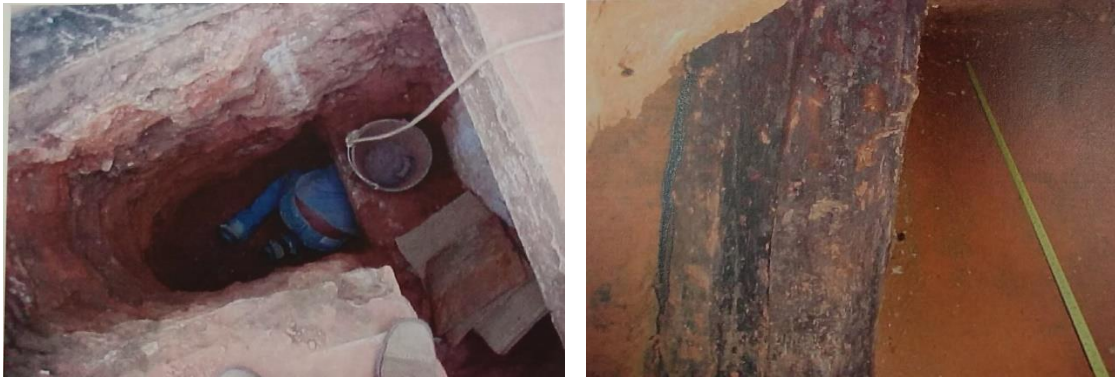
Figura 46 - Escavação do poço de inspeção para pesquisa da fundação. Figura 47 - Estacas de madeira da fundação em perfeito estado de conservação. Fonte: IPHAN/MG.
