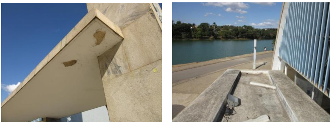
Figura 95 – Destacamentos na marquise de entrada. Figura 96 – Vista superior da marquise sem nenhuma evidência de problemas com a impermeabilização. Fonte: Recuperação Serviços Especiais de Engenharia.
