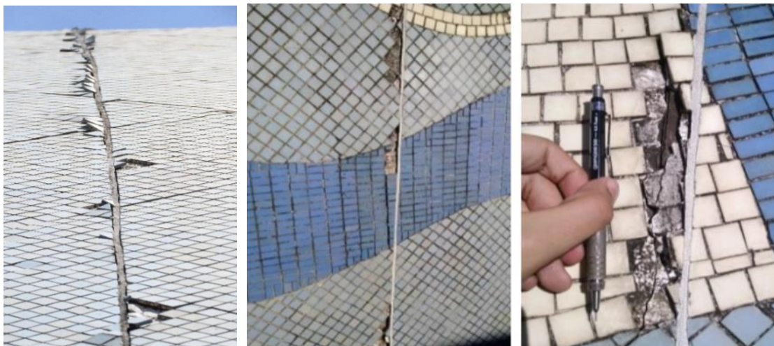
Figuras 97, 98 e 99 – Destacamento de pastilhas ao longo das juntas de dilatação e desprendimento da argamassa de assentamento das pastilhas. Fonte: Memorial da Arquidiocese de Belo Horizonte.
