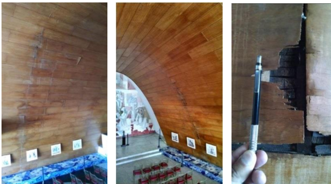
Figuras 104, 105 e 106 – Danos no forro em madeira: marcas de escorrimento de água, desprendimento, parte apodrecidas, lacunas. Fonte: Memorial da Arquidiocese de Belo Horizonte.
