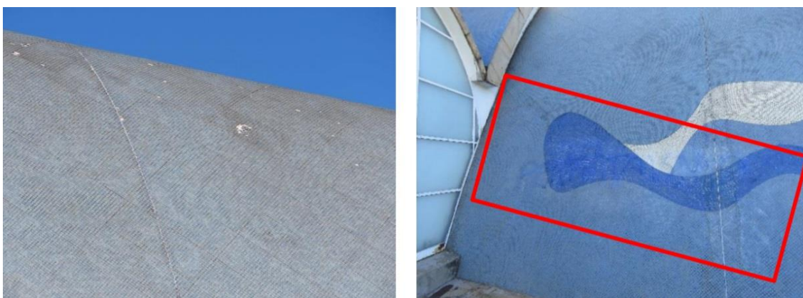
Figura 135 - Parte superior da cobertura da nave – descolamentos de pastilhas generalizados. Figura 136 - Área de limpeza da pichação. Fonte: Memorial da Arquidiocese de Belo Horizonte.
