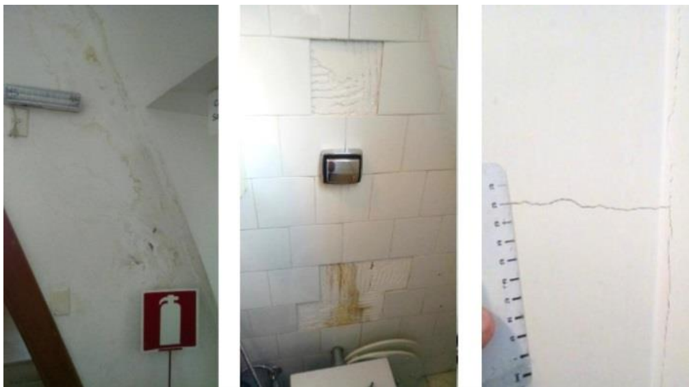
Figura 110 – Marcas de infiltração, manchas e pintura estufada – arco do presbitério. Figura 111 – Descolamento do revestimento cerâmico dos banheiros e marcas de escorrimentos das instalações hidráulicas. Figura 112 – Fissura na parede da sacristia (0,2 mm) – circulação para os banheiros. Fonte: Memorial da Arquidiocese de Belo Horizonte.
