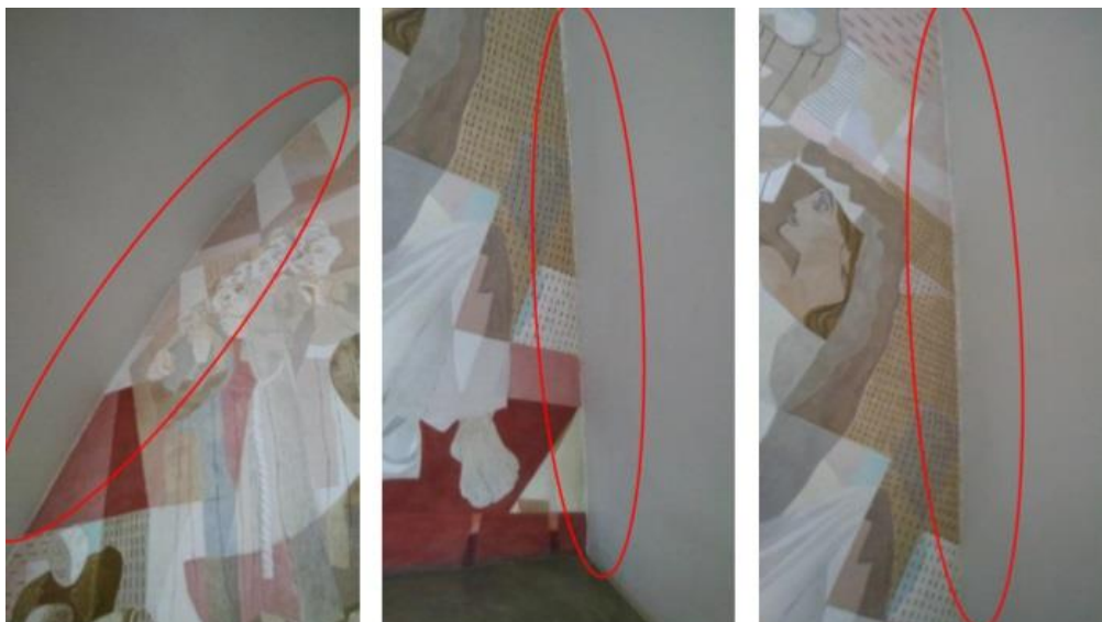
Figuras 107, 108 e 109 – Fissuras na parede do presbitério (aproximadamente 0,7mm). Fonte: Memorial da Arquidiocese de Belo Horizonte.
