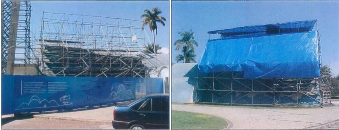
Figura 56 – Montagem dos andaimes sobre a casca da Igreja em 2004. Figura 57 – Vista dos andaimes já cobertos pela lona de proteção contra chuvas. Fonte: AGUIAR; MORAES, 2005, p. 17-18.
