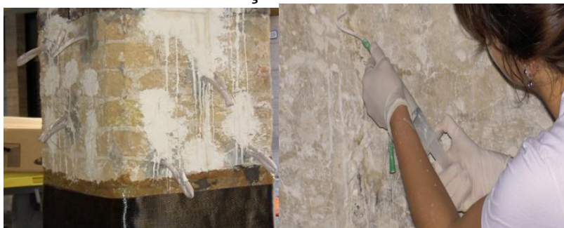
Figura 78 – Momentos da intervenção de impregnação de uma coluna e de consolidação dos rebocos.
