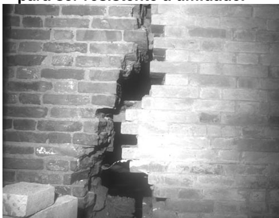
Figura 126 –Substituição de material degradado com material novo, tratado para ser resistente a umidade.
