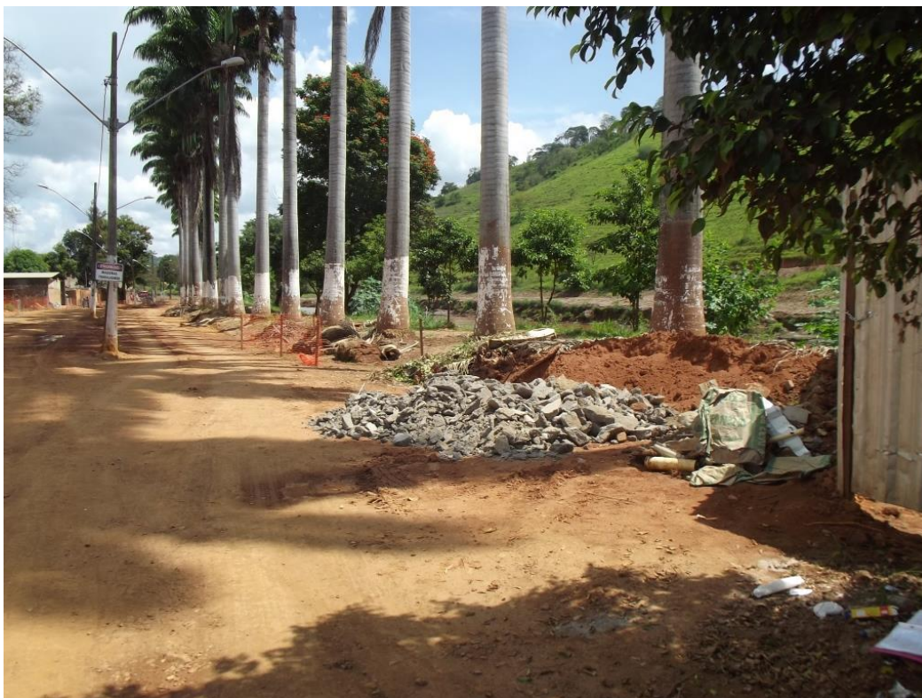
Figura 45 - Av. Martins Francisco Carneiro, Barra Longa, MG
