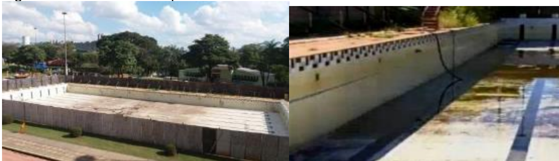
Figura 163 – Piscina olímpica do CEU interditada.
