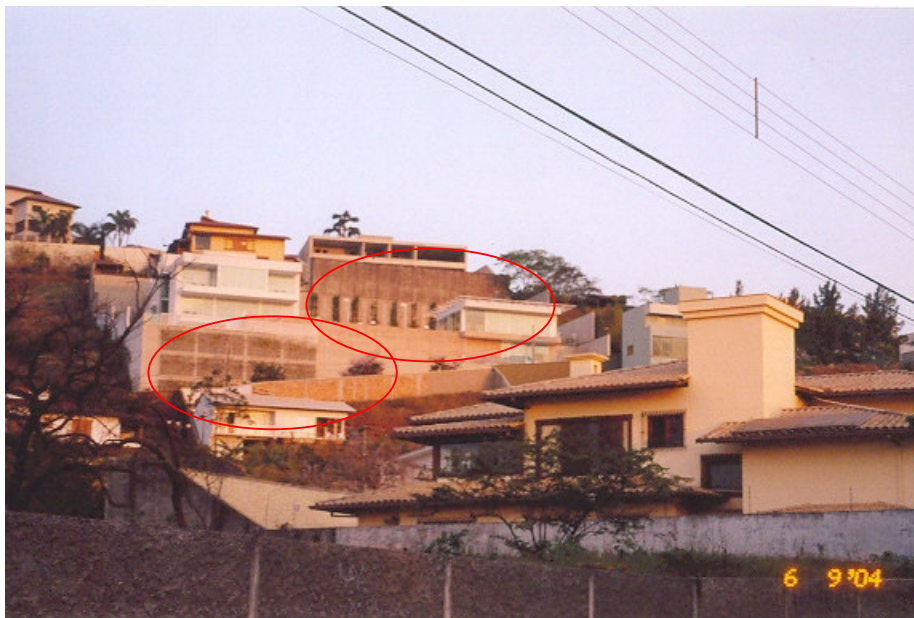
Foto 3 - Casas situadas no Belvedere II, com destaque às fundações das mesmas. Não são raras as construções neste local que demandam esta base estrutural
