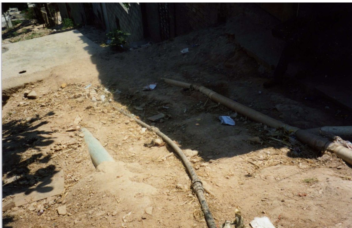
Foto 38: À esquerda, exemplo de tubulação de rede de esgoto realizada pela COPASA em 1997. Ao centro tubulação de água da COPASA e à direita tubulação de esgoto feita por habitante. Fonte: arquivo do autor 2007.
