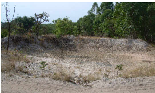
FIGURA 152 – Barraginha construída em 2007 para conter o assoreamento na vereda do Meloso. Os sulcos de erosão da enxurrada que desce do tubulão sob a BR-365 foram destruídos. (set./2007).
