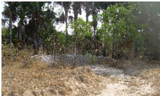
FIGURA 153 – Barraginha na vereda do Meloso, nos primeiros pés de buritis, construída em 2007, para conter a deposição de sedimentos e para facilitar a infiltração de água de enxurradas das estradas e vindas da tubulação sob a BR-365. (set./2007).
